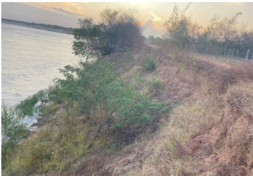
Figura 9 - Erosão no Rio Parnaíba (Magalhães de Almeida - MA)
