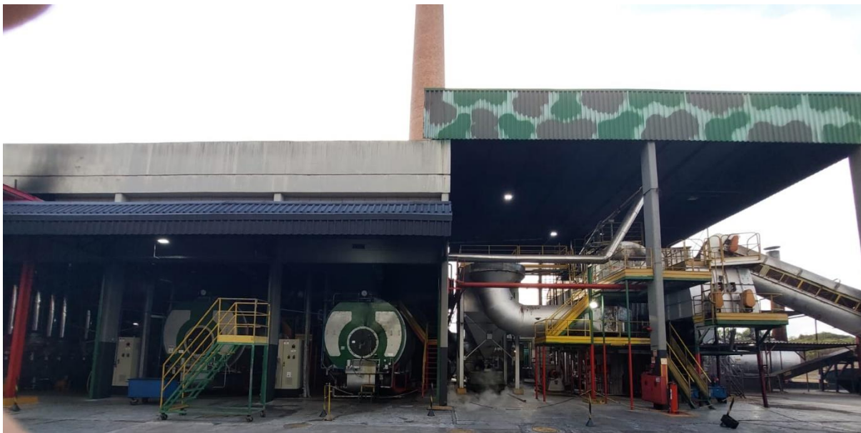
Figura 10 – Local de instalação das caldeiras.
