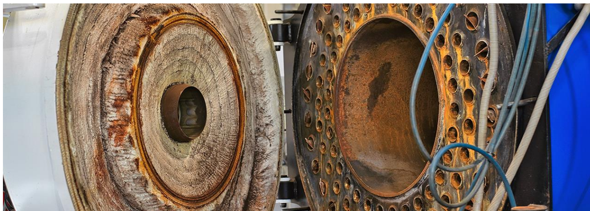
Figura 6 – Caldeira com deterioração por corrosão.
