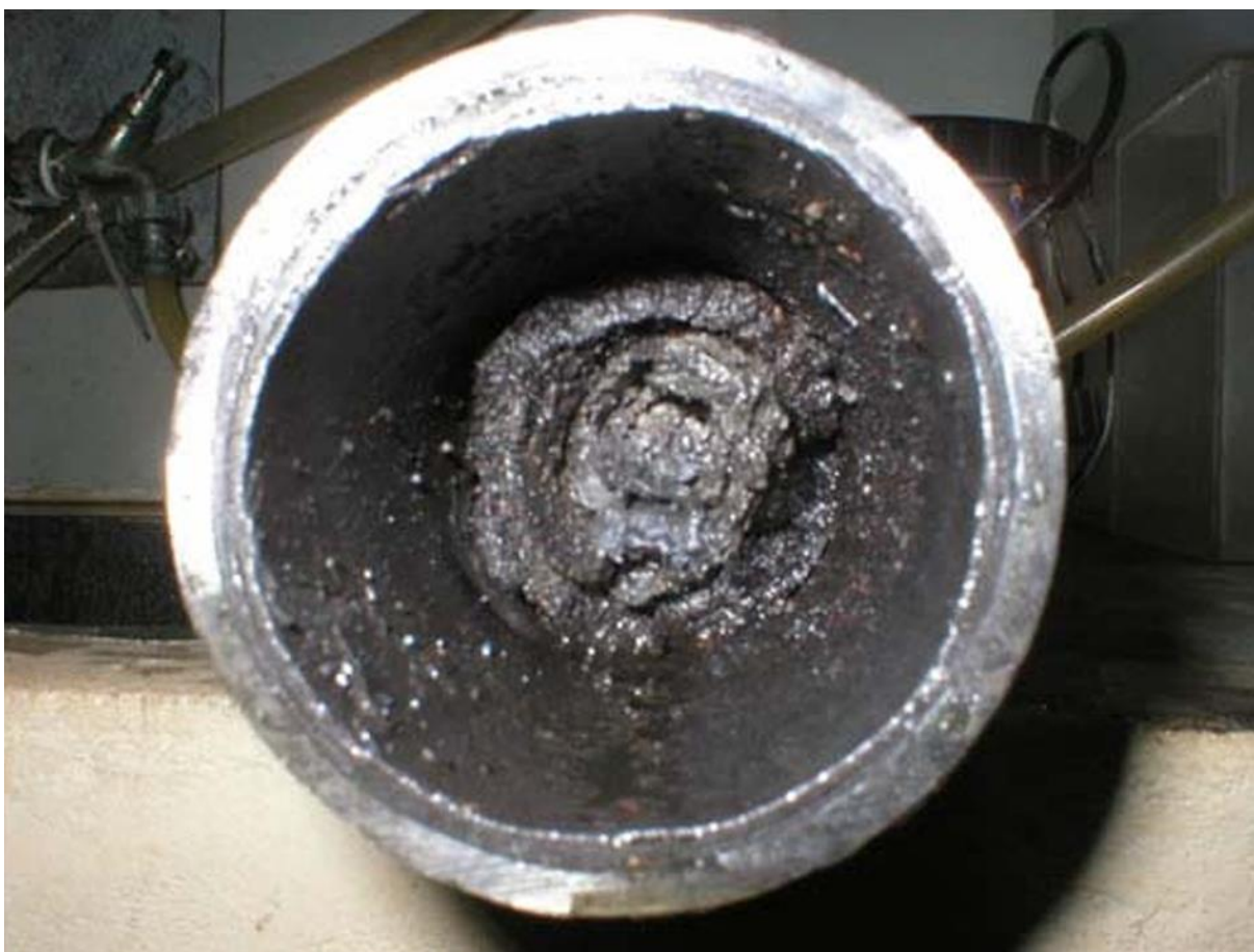
Figura 8 – Tubo de superaquecedor completamente obstruído por material originado de arrastes.
