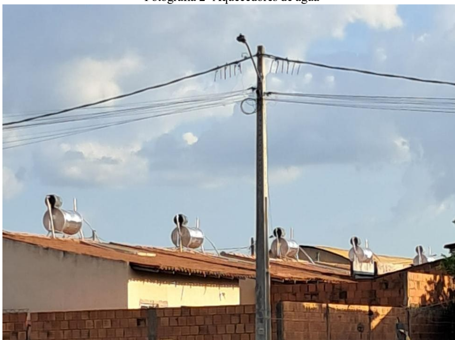
Fotografia 2- Aquecedores de água
