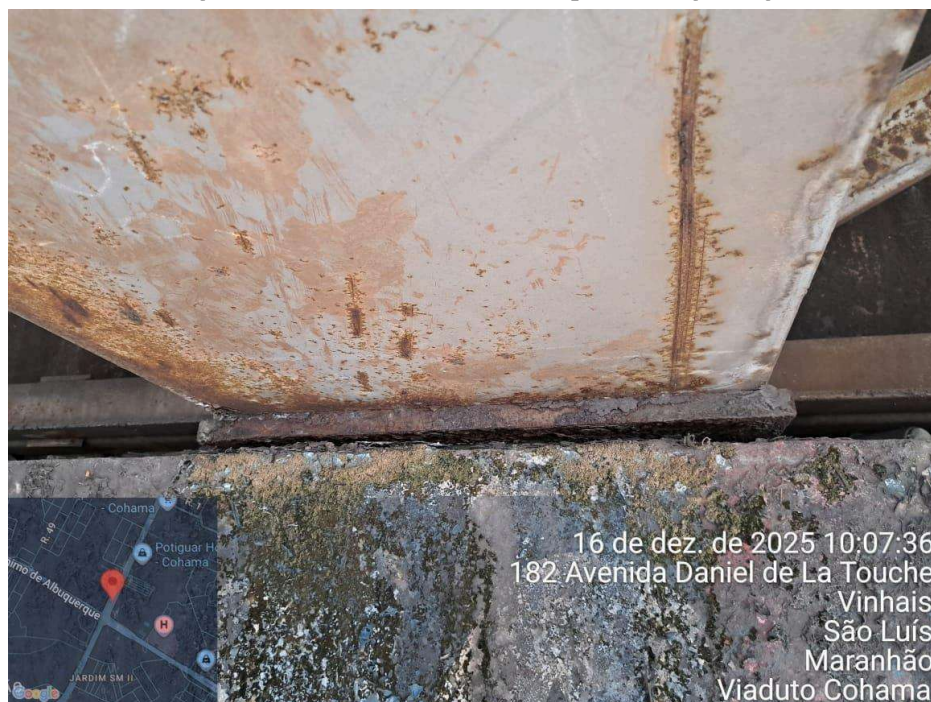
Figura 20 – Corrosão na base de apoio da viga longarina
