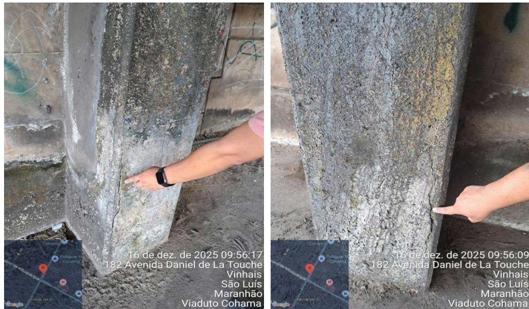
a) Deslocamento de concreto e corrosão b) Armadura exposta devido a corrosão
