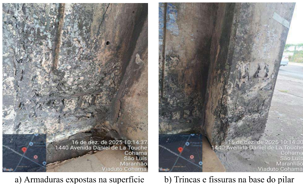
Figura 16– Armadura exposta na base do pilar
