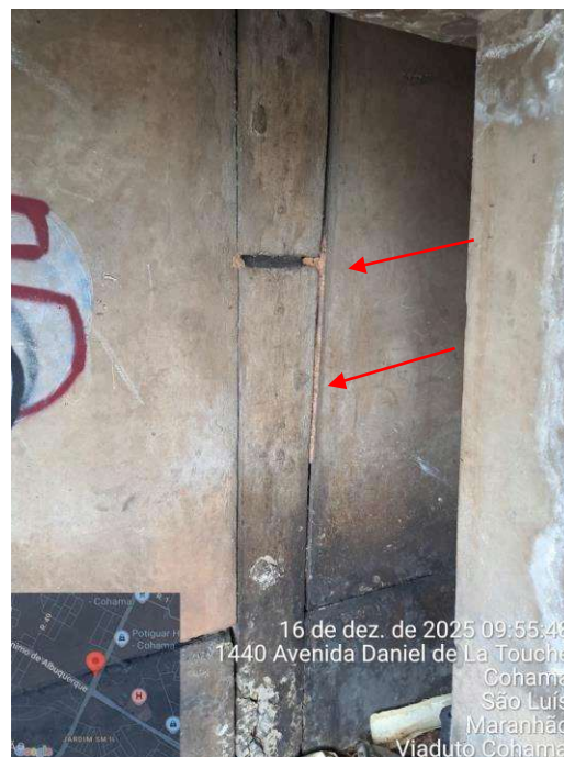
Figura 5- Presença de solo de aterro entre juntas das placas pré-moldadas
