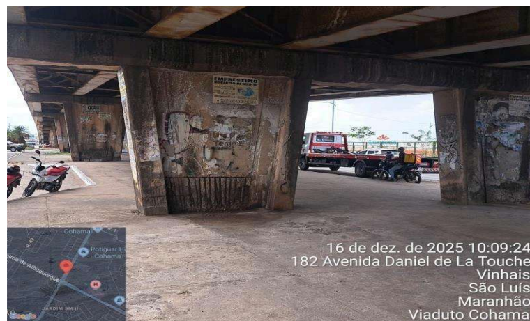
Figura 13 – Processo de corrosão avançado no pilar 1 do pórtico 2.
