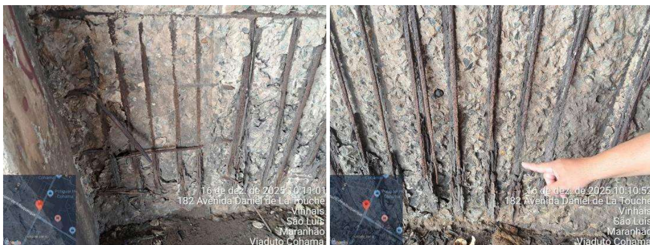
a) Ausência de armaduras devido a corrosão
