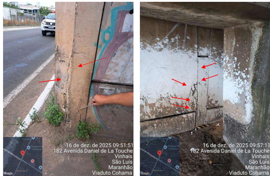
a) Fissuras e trincas
