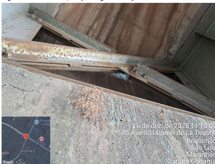
Figura 27- Manifestações patológicas na laje do tabuleiro
