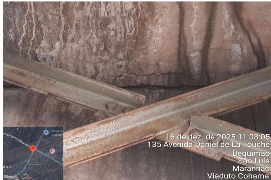
Figura 22 – laje do tabuleiro fissurada
