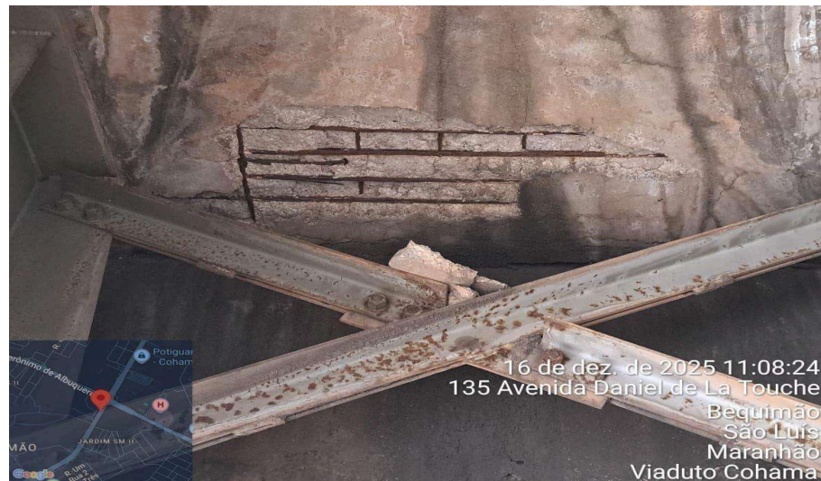
Figura 24- deslocamento de concreto e armadura exposta na laje do tabuleiro
