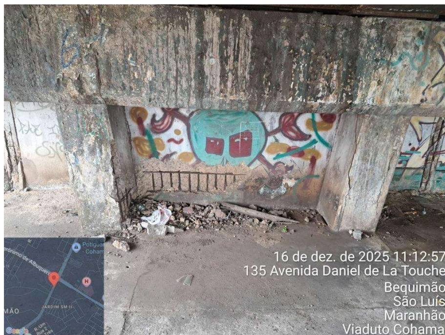
Figura 18— Pilar com armaduras expostas
