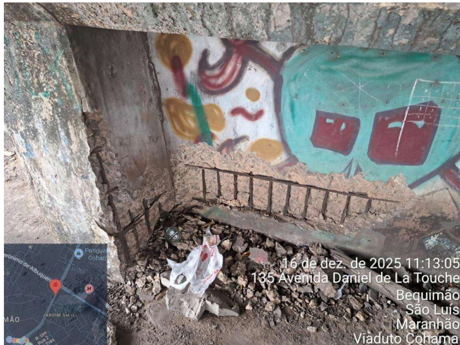
Figura 19– Armaduras expostas na base do Pilar
