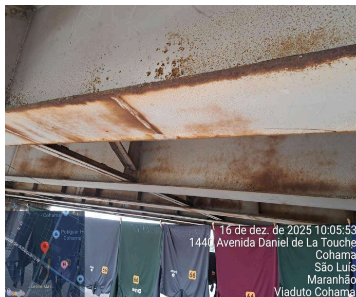
Figura 25– Longarinas metálicas com corrosão
