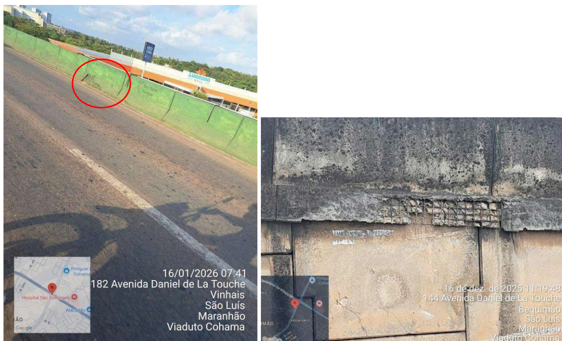
Figura 29– Deslocamento de concreto da barreira de proteção
