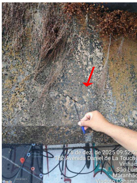
Figura 11 – Fissuras e trincas na viga de travamento
