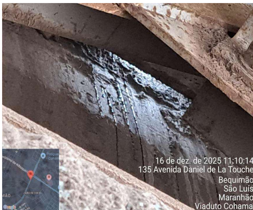
Figura 26 – Falha na junta de dilatação vista pela parte inferior da laje do tabuleiro
