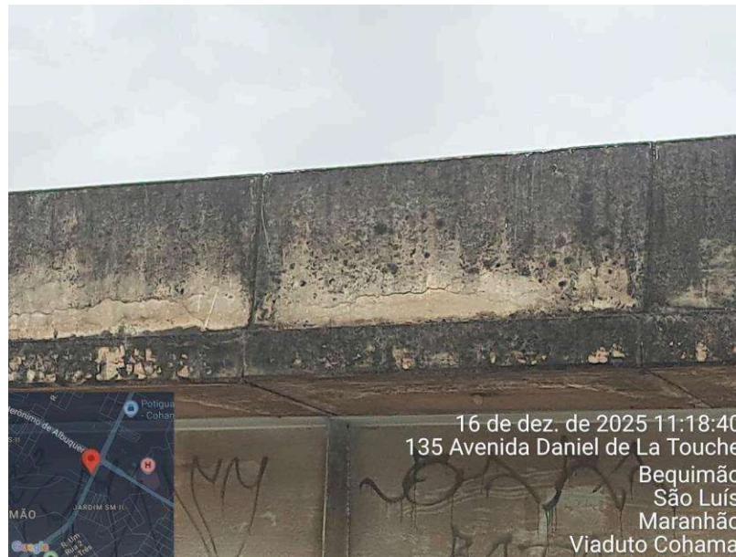
Figura 30 - Fissuração nas barreiras de proteção da pista de rolamento do viaduto
