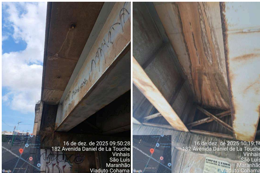
a) Drenos obstruídos com manchas
