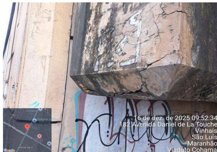
Figura 10 – Fissuras e trincas na viga de travamento
