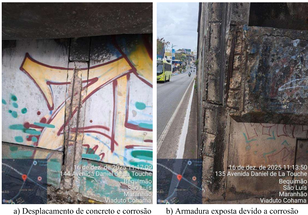
Figuras 8 – Armadura exposta com corrosão
