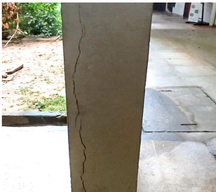
Figura 4: Rachaduras em elemento estrutural
