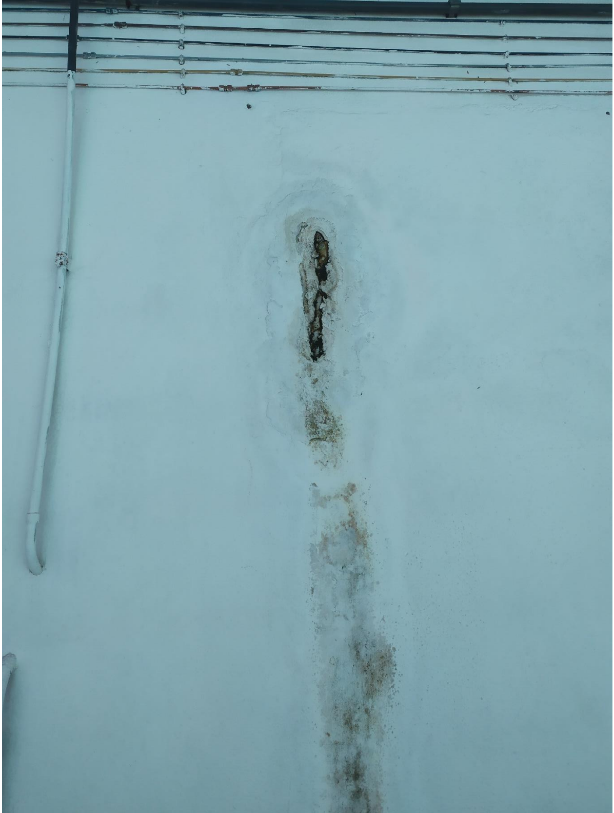
Figura 16: Mancha em parede causada por umidade
