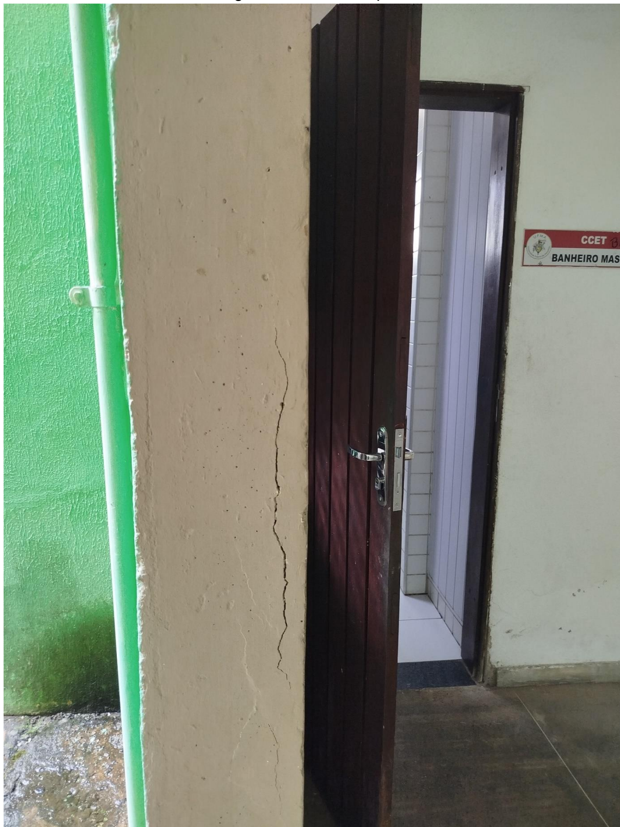
Figura 14: Trinca em pilar
