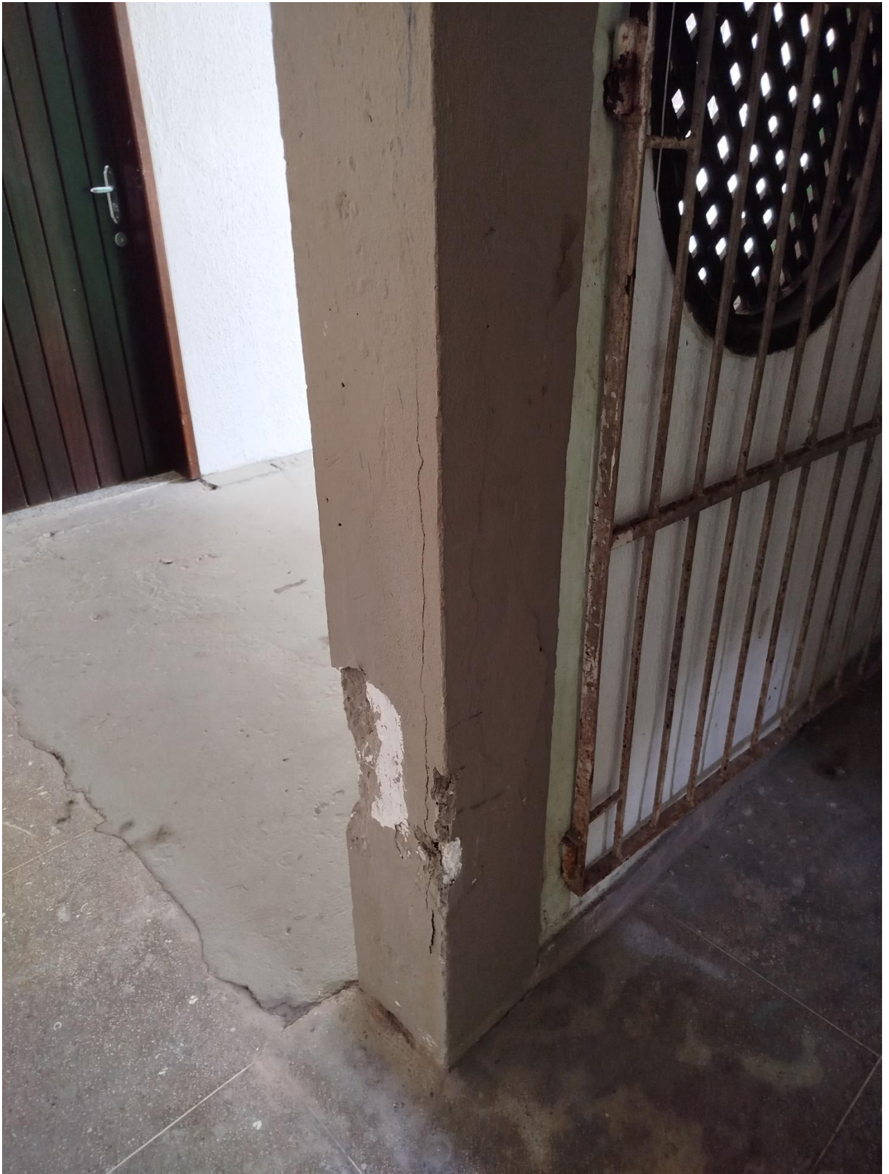
Figura 21: Trinca e deslocamento em pilar de concreto
