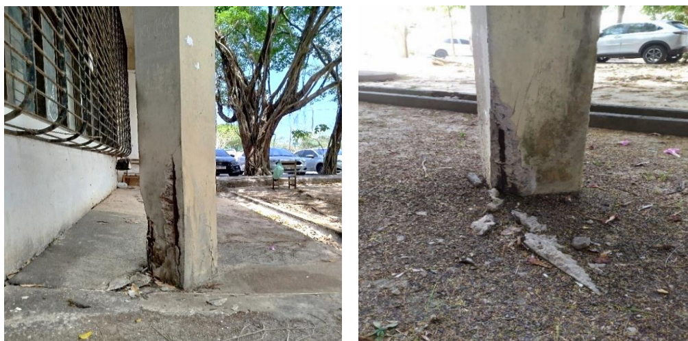
Figuras 12a e 12b: Corrosão na armadura em pilar estrutural na parte externa
