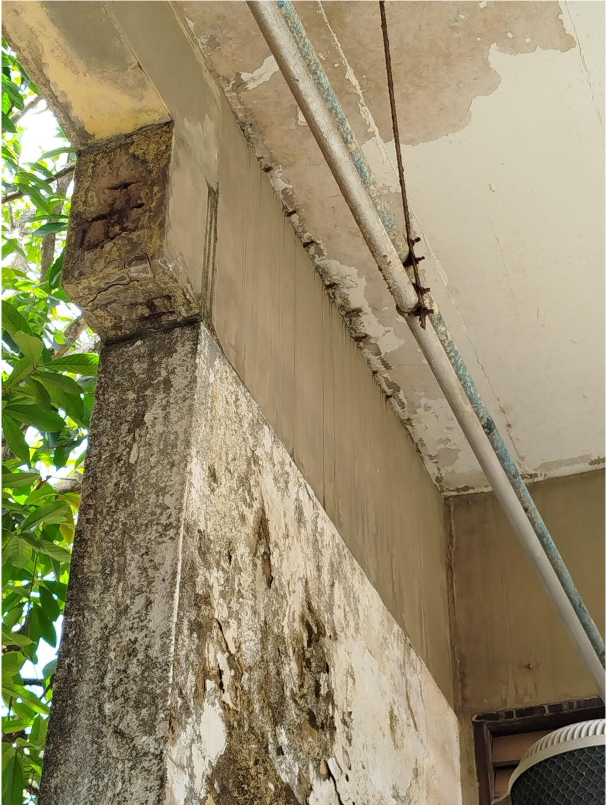
Figura 26: Desplacamento em viga e descascamento de pintura
