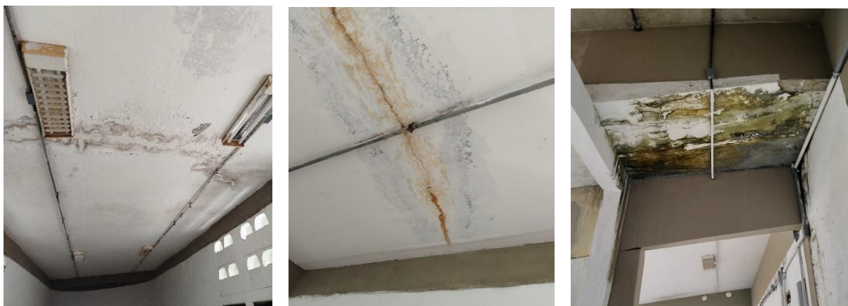
Figuras 11a, 11b e 11c: mancha provocada pela presença de umidade no teto da edificação
