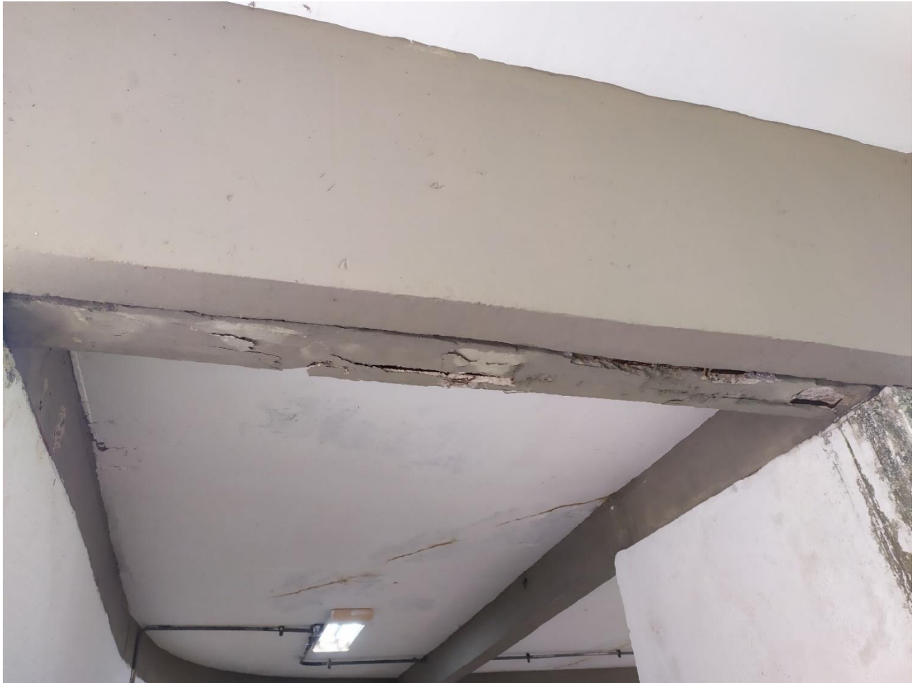
Figura 17: Corrosão de armadura em viga
