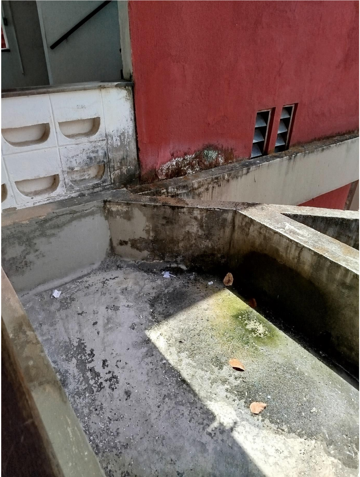
Figura 27: Umidade, manchas e bolor
