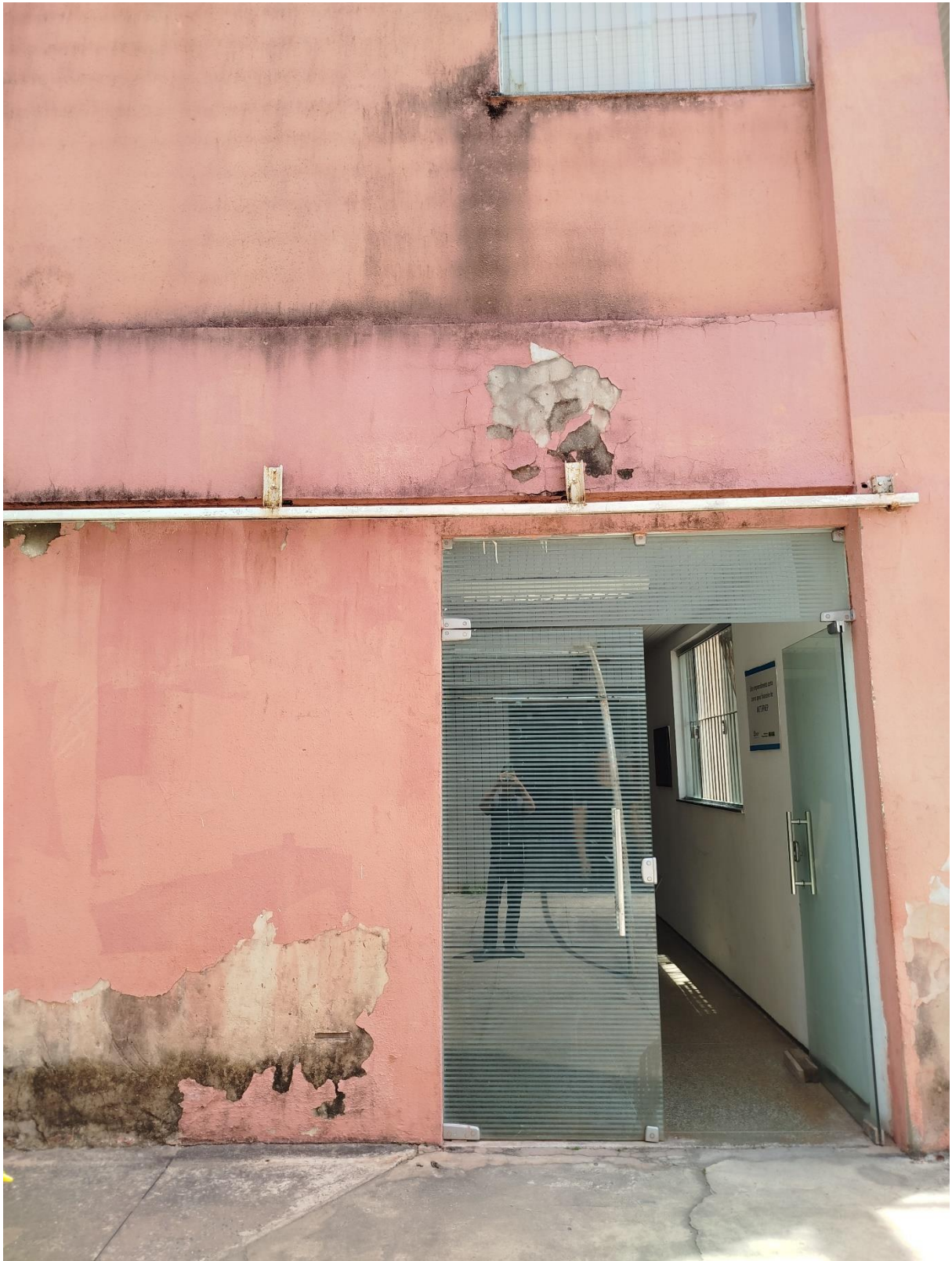
Figura 24: Descascamento de pintura em parede externa
