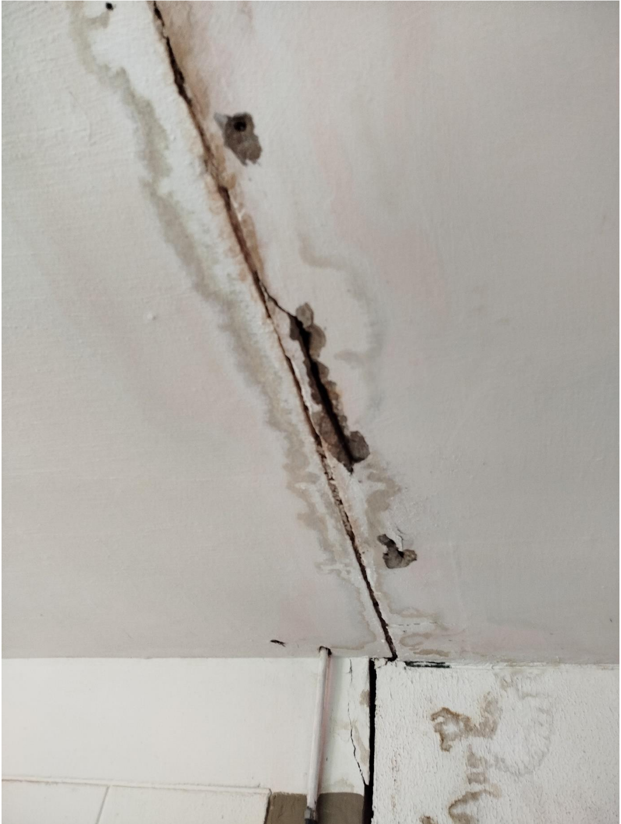
Figura 28: Corrosão de armadura, mancha e umidade
