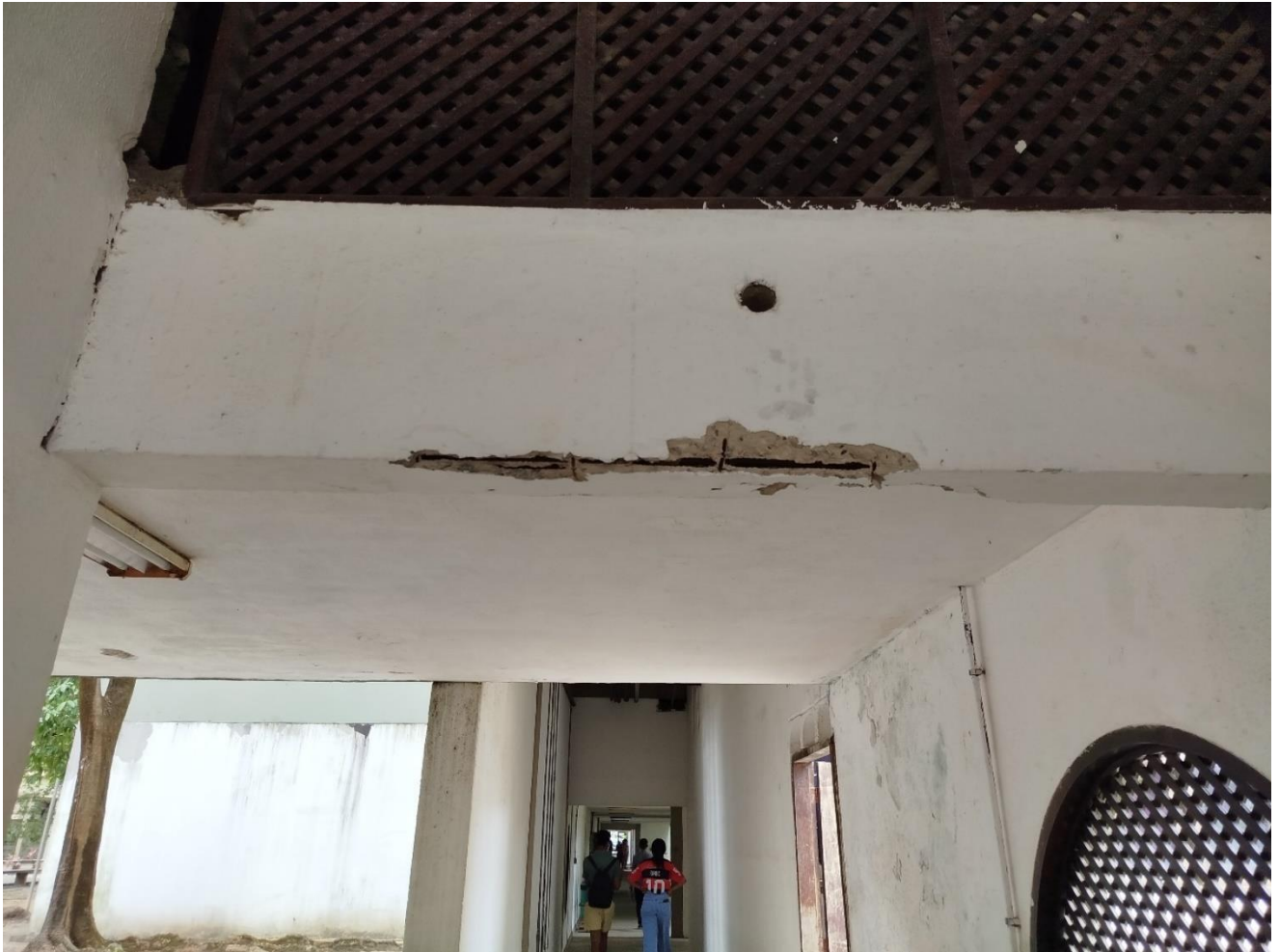
Figura 19: Corrosão de armadura em viga
