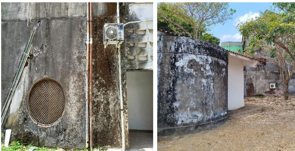
Figuras 6a e 6b: Manchas e bolores em parede de vedação externa
