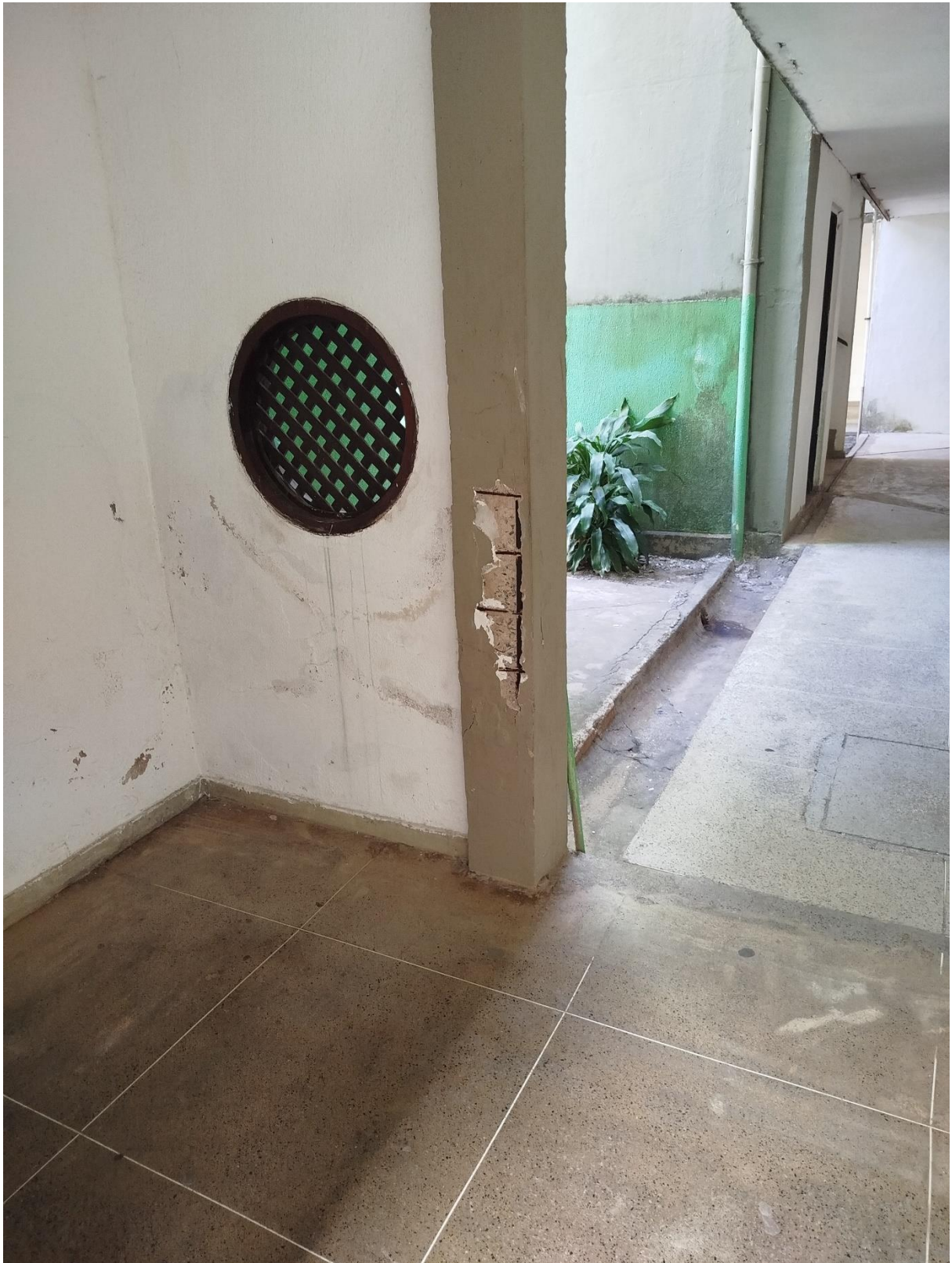
Figura 29: Deslocamento em pilar e corrosão de armadura
