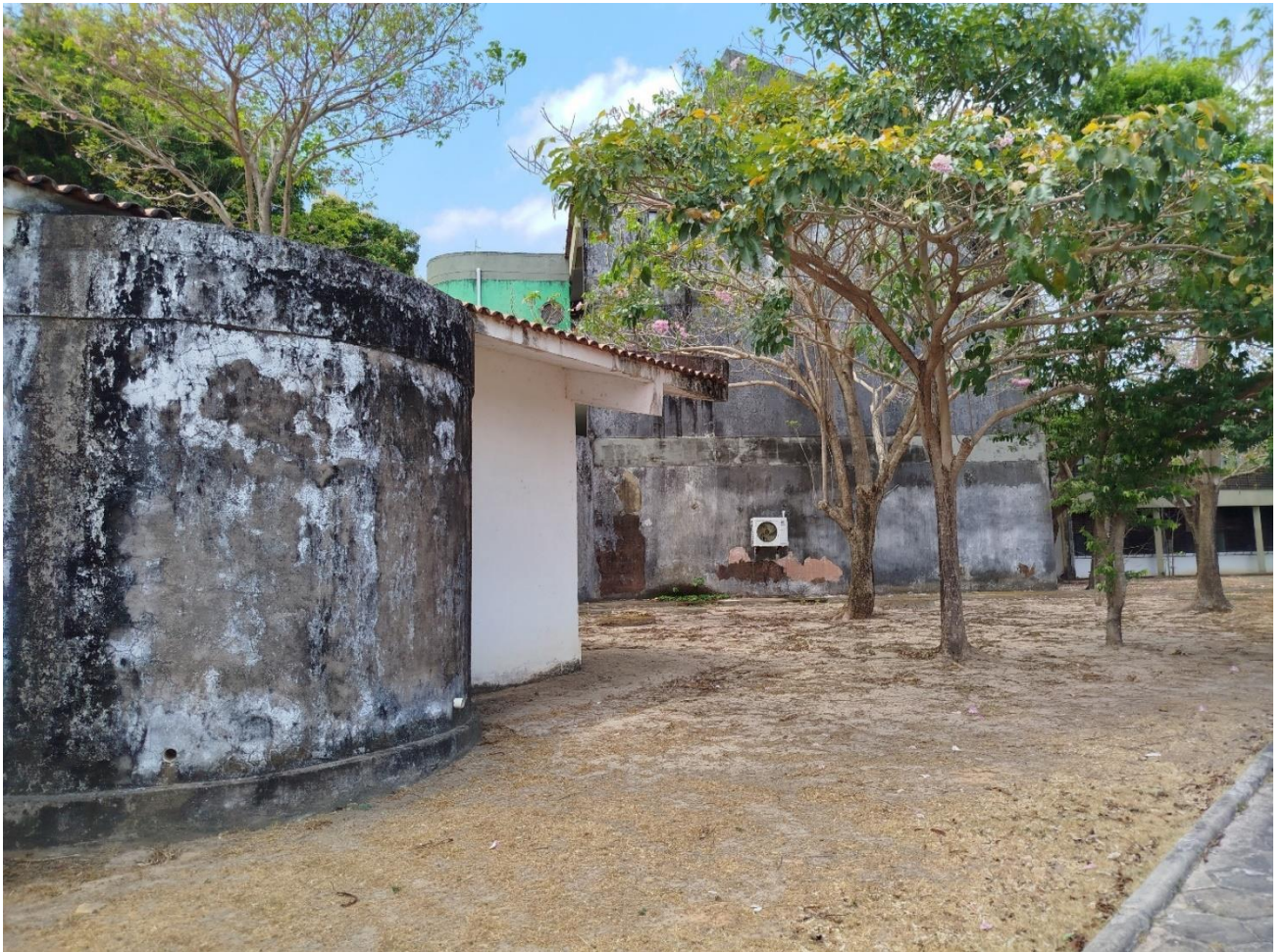
Figura 22: Manchas e bolores em alvenaria externa
