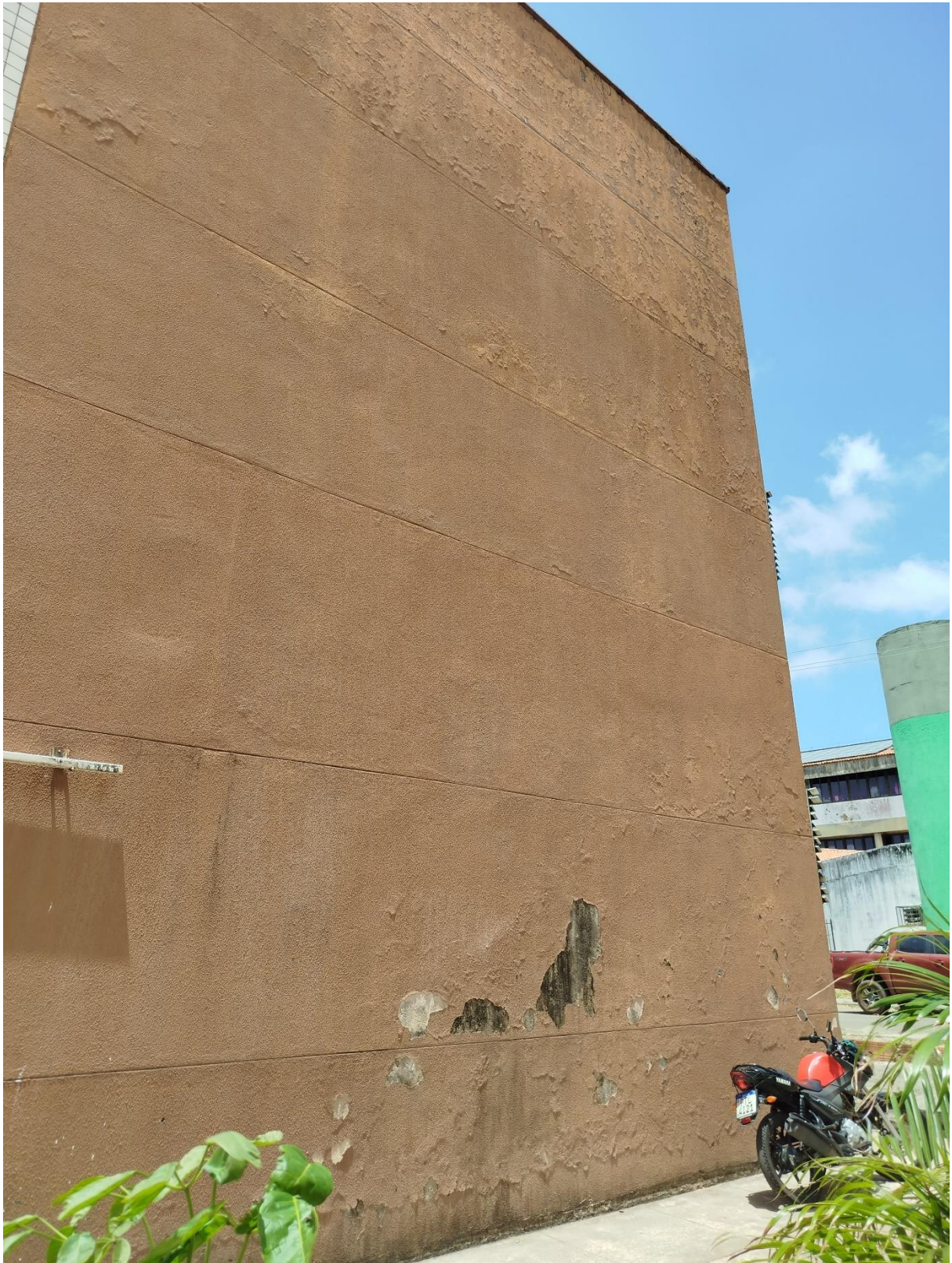
Figura 23: Descascamento de pintura
