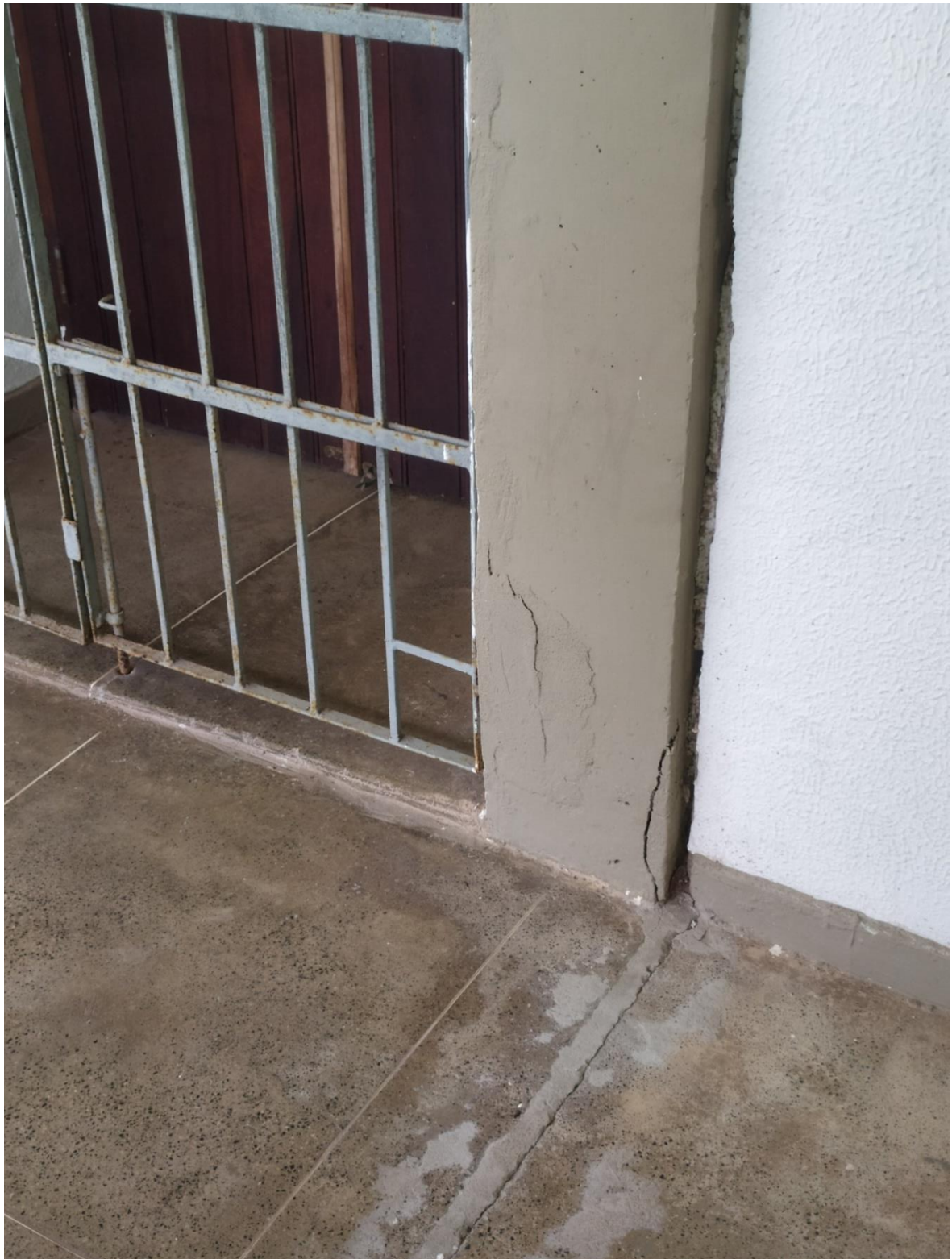
Figura 15: Trinca em pilar
