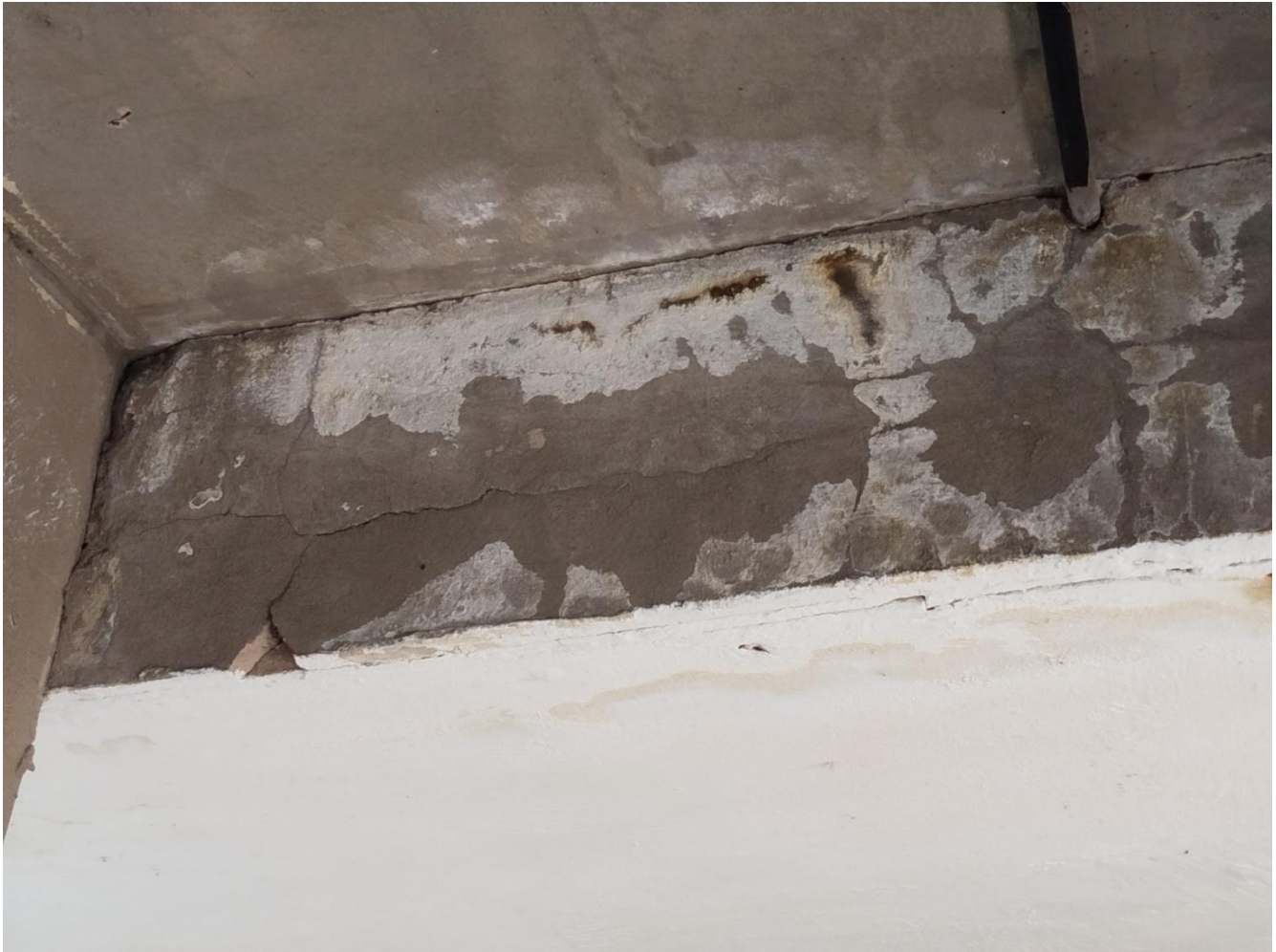
Figura 18: Trincas e eflorescência
