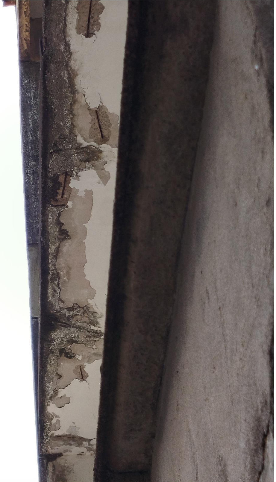
Figura 25: Deslocamento em laje de concreto armado e corrosão de armadura
