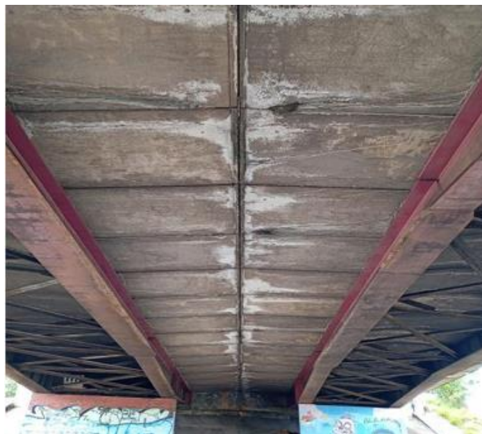
Figura 5: Eflorescência em laje de viaduto em São Luís/MA
