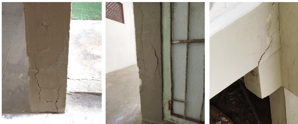
Figuras 10a, 10b e 10c: fissuras, trincas e rachaduras respectivamente
