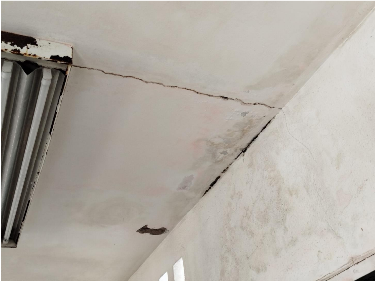
Figura 20: Trinca e umidade na parte inferior da laje
