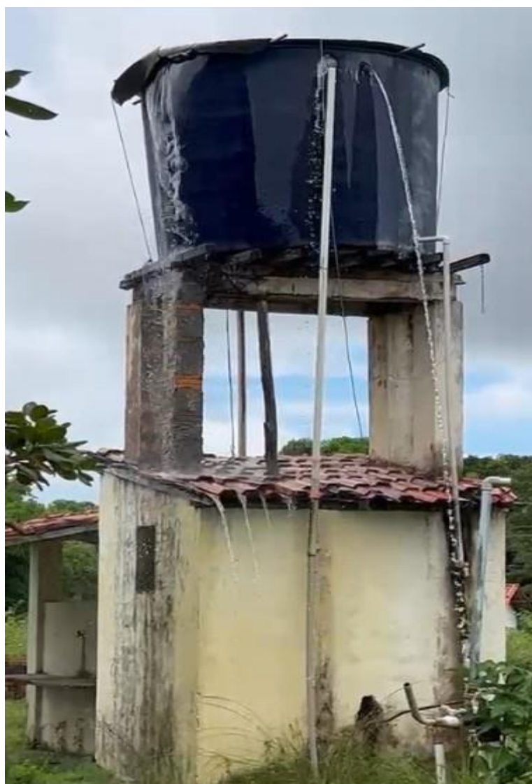
Figura 9 - Caixa d'água da lavanderia com vazamento, Agrovila Cajueiro
