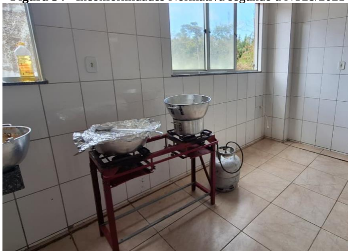
Figura 34 - Inconformidades Normativa segundo a NT28/2021
