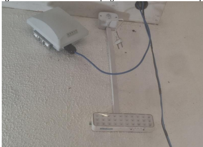
Figura 26 - Bloco autônomo desplugado do circuito de alimentação
