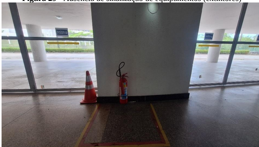
Figura 29 - Ausência de sinalização de equipamentos (extintores)
