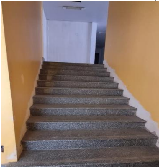
Figura 16 - Ausência de corrimão na escada de acesso ao pavimento 2
