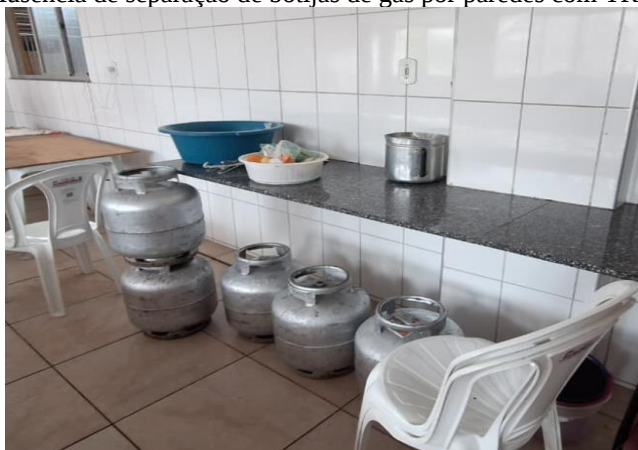
Figura 35 - Ausência de separação de botijas de gás por paredes com TRRF de 120 min
