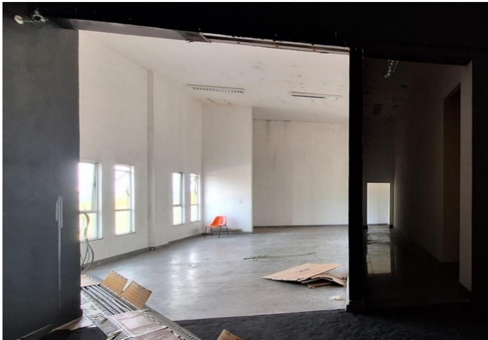
Figura 24 - Incompatibilidade do projeto com o executado quanto às portas de saída de emergência
