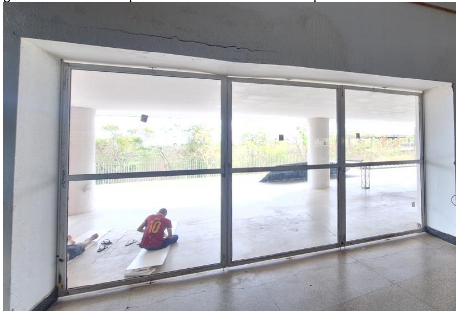
Figura 21 - Porta com dispositivo de travamento e fissura impossibilitando abertura da folha
