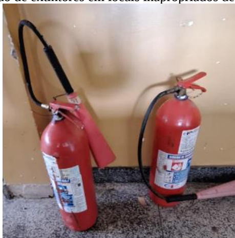
Figura 31 - Disposição de extintores em locais inapropriados de circulação de usuários
