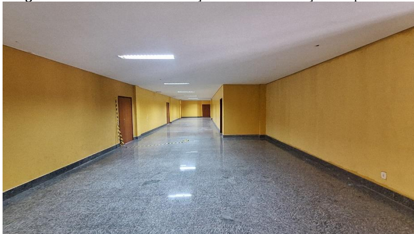
Figura 28 – Ausência de sinalização básica e sinalização complementar
