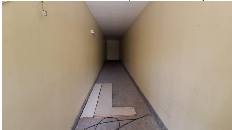
Figura 17 - Ausência de corrimão na rampa de acesso a circulação de serviço
