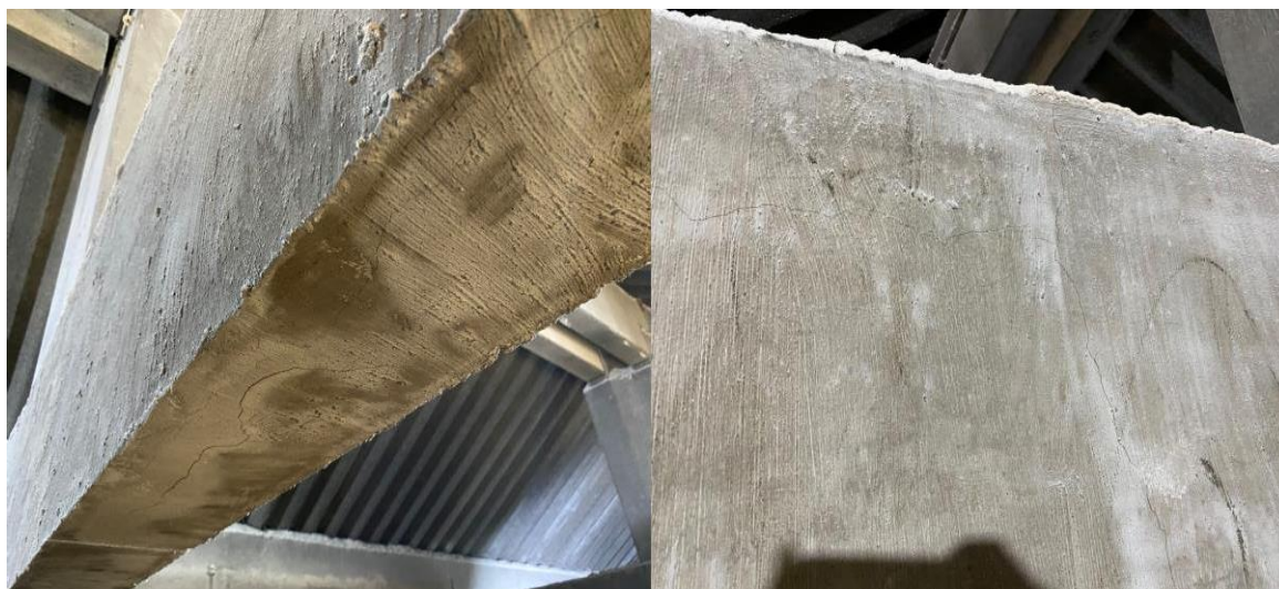
Figura 18 – Vista das Vigas Pórtico 02 a 08, evidenciando fissuras aparentes.
