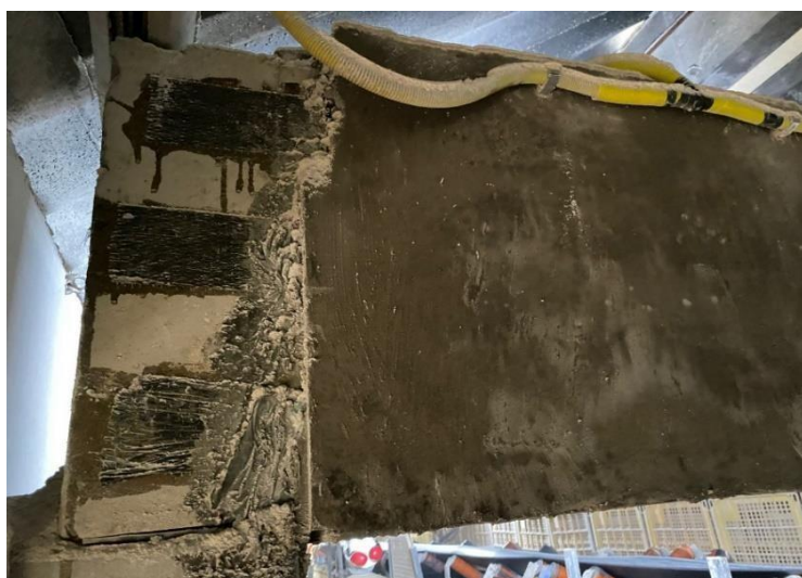
Figura 19 – Vigas Pórtico 02 a 08, evidenciando diferença de acabamento superficial associada à aplicação não uniforme do revestimento em graute
