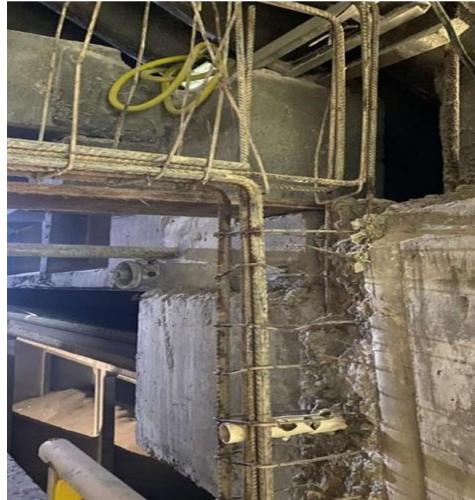
Figura 9 – Armaduras da Viga e pilar Pórtico 01 antes da intervenção.
