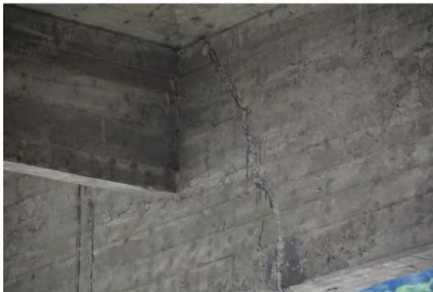
Figura 5 - Fissura em 45° na viga longitudinal
