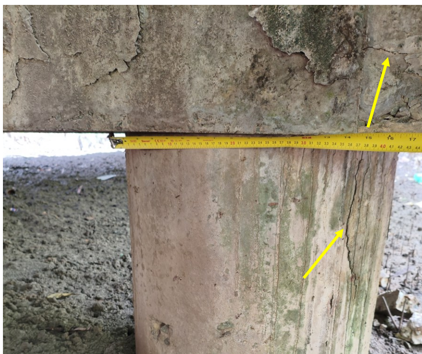
Figura 24: Fissuras encontradas na viga de travamento da ponte e estacas.
