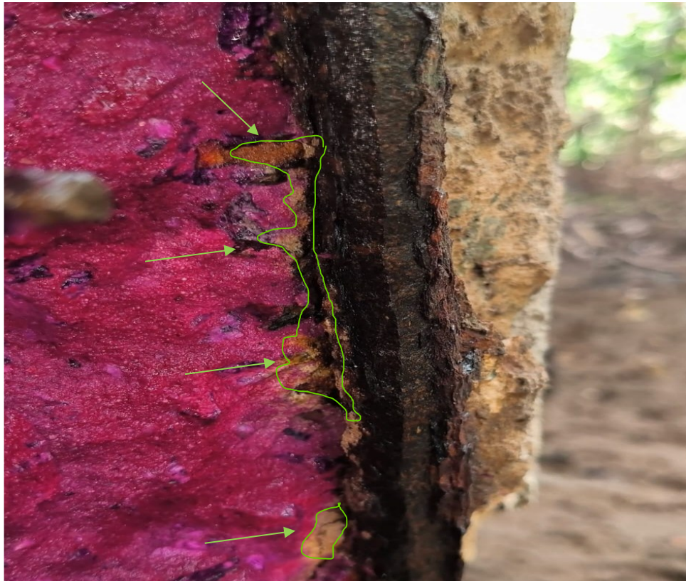
Figura 33 – Ensaio em armadura oxidada.
