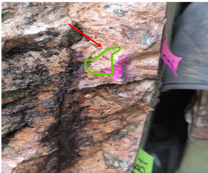
Figura 32 – Indicação de despasse do concreto
