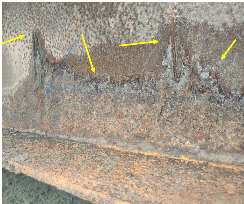
Figura 26 – Processo de corrosão nas vigas longarinas.
