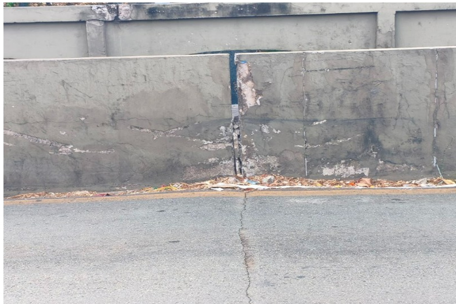
Figura 16 – Fissura no alinhamento da junta de dilatação
