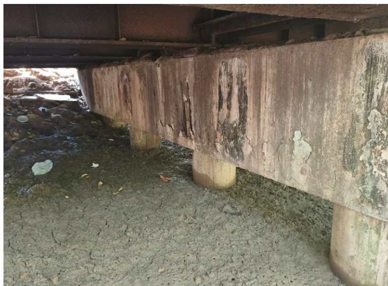
Figura 11 – Manifestações patológicas encontradas na viga de travamento
