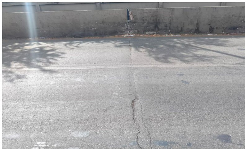
Figura 15 – Fissura no alinhamento da junta de dilatação
