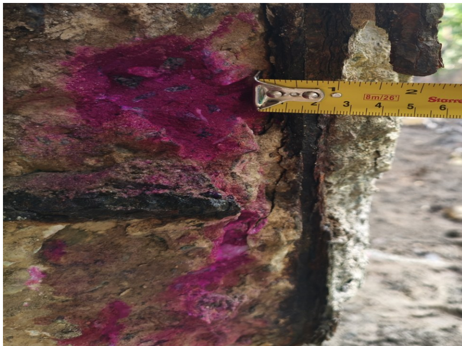
Figura 34 – Ensaio com armadura exposta.
