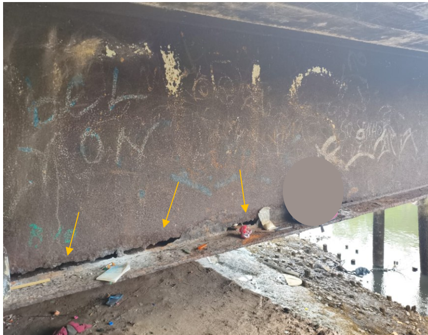
Figura 25 – Perda de seção por corrosão em longarinas
