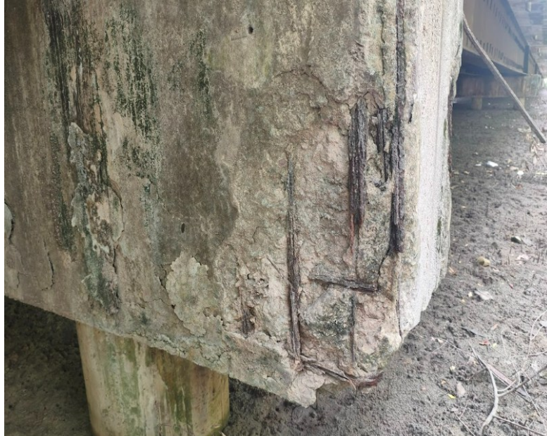
Figura 12 – Corrosão da armadura na viga de travamento.
