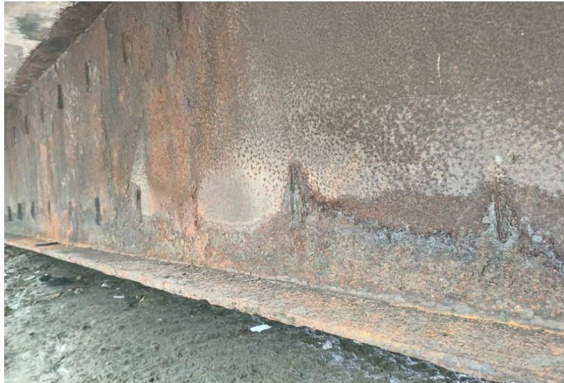
Figura 14 – Corrosão de armadura na viga longitudinal metálica
