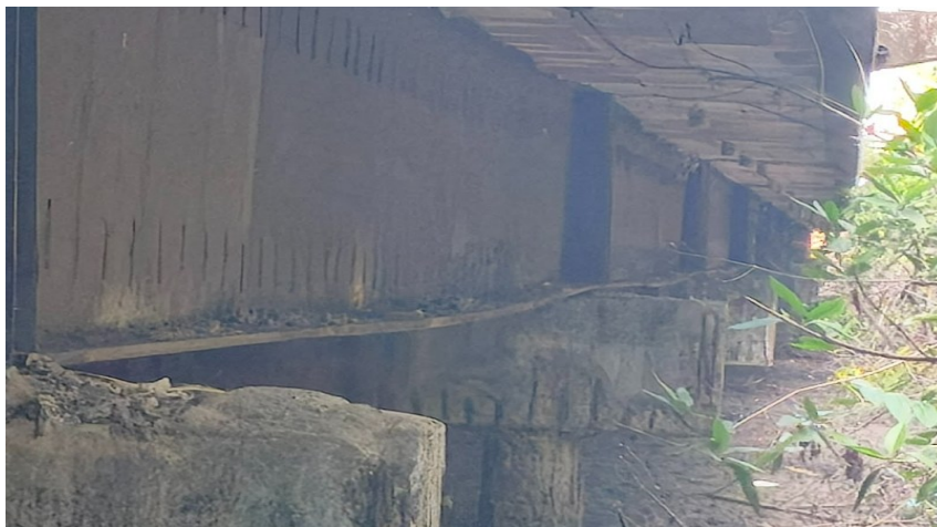
Figura 13 – Corrosão de armadura na viga longarina e viga de travamento
