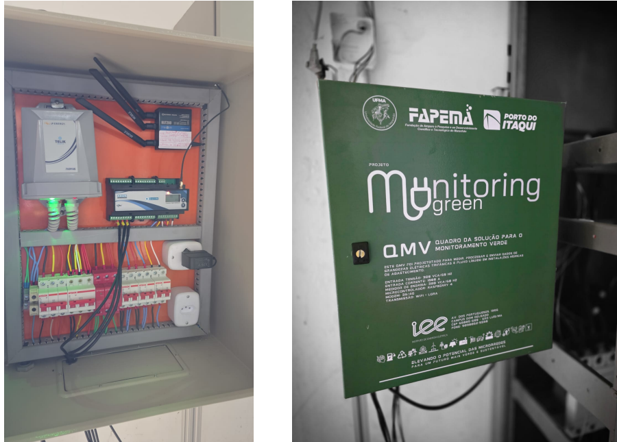
(a) Montagem interna.
