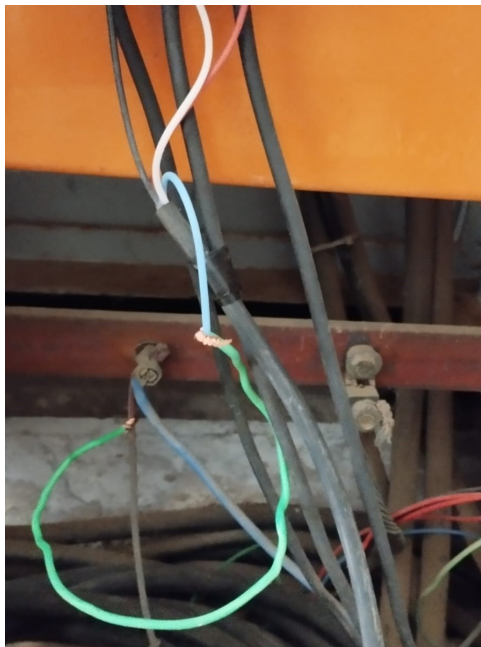
Figura 5.8 – Emendas irregulares e fios desencapados.
