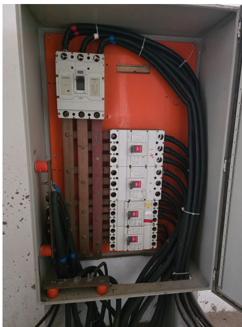
Figura 5.9 – Barramento trifásico exposto.
