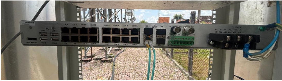
Figura 24 - Conexões na RTAC da subestação B
