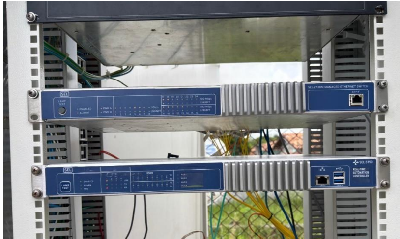
Figura 23 - RTAC na subestação B
