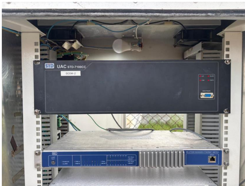
Figura 22 - UAC na subestação B
