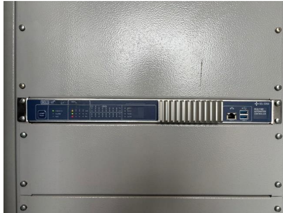
Figura 19 - RTAC na subestação A
