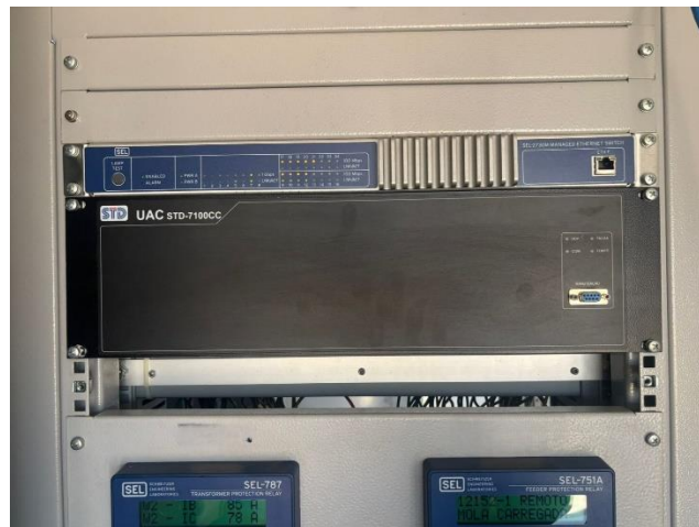
Figura 18 - UAC na subestação A
