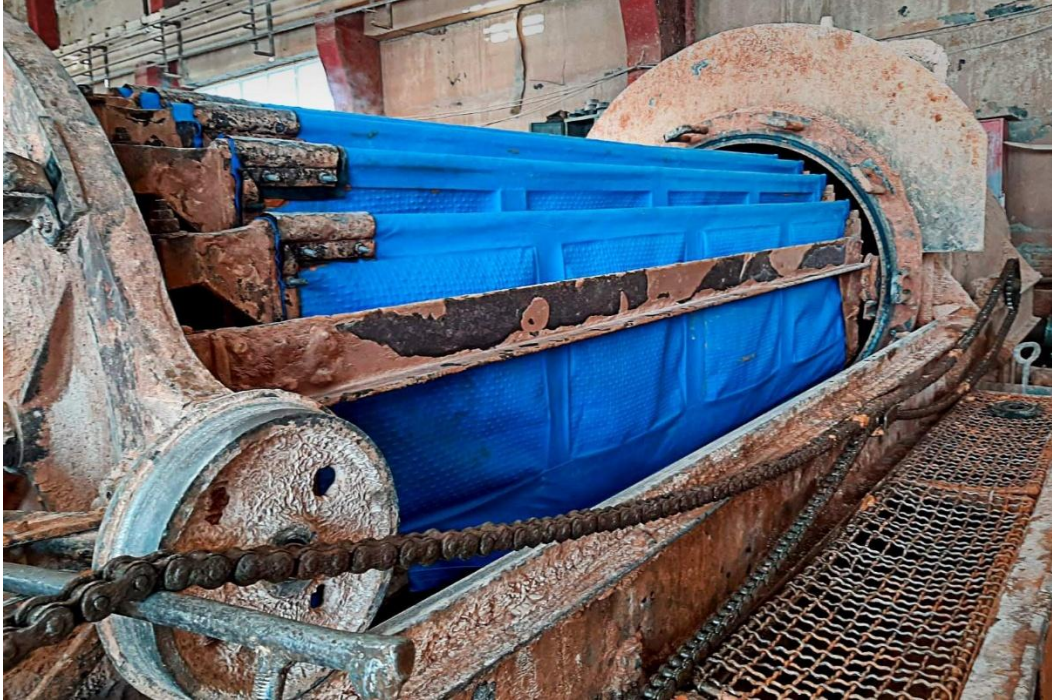
Figura 2: Filtro Kelly com novos panos instalados.
