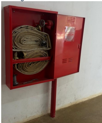
Figura 36 - Abrigo de Hidrante no Bloco Administrativo
