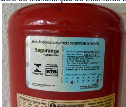
Figura 33 - Selo de Manutenção de Extintores Desatualizado
