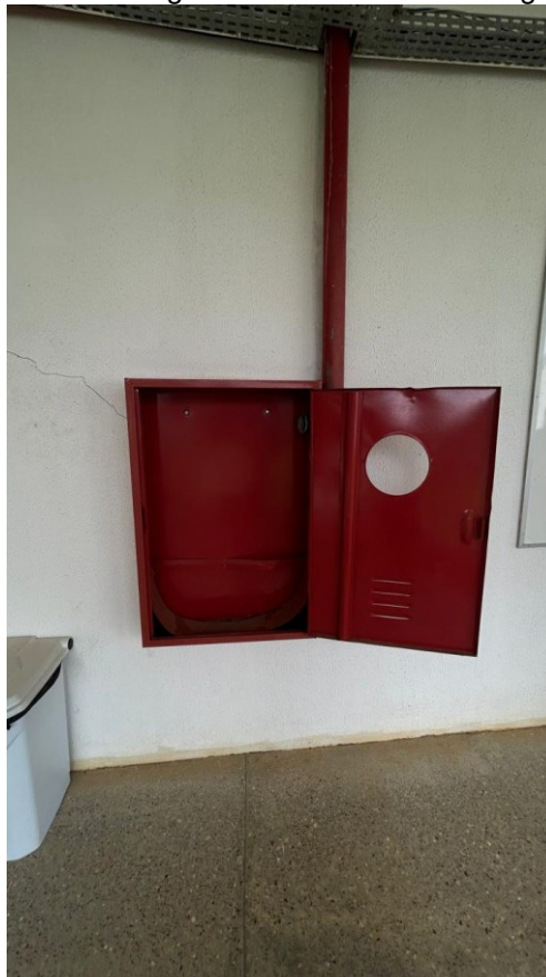
Figura 37 - Abrigo de Hidrante Bloco Pedagógico
