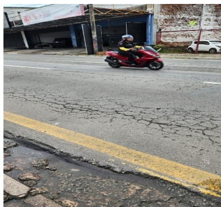
Figura 11: Trincas bloco, segmento 02.
