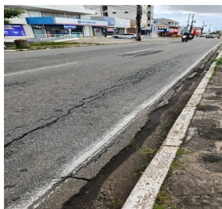
Figura 12: Trincas longitudinais, segmento 02.
