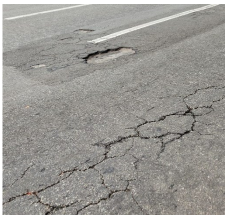
Figura 09: Trincas bloco, segmento 01.
