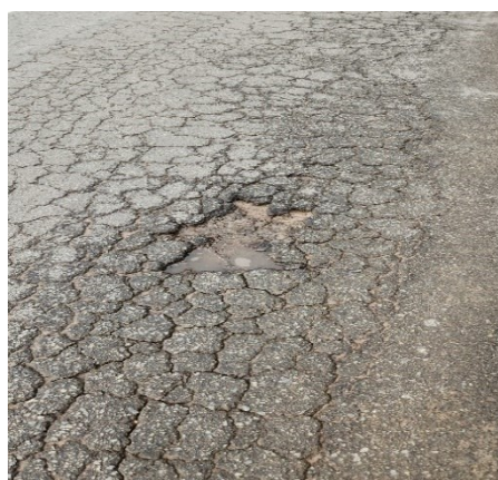
Figura 10: Trincas couro de jacaré, segmento 02.
