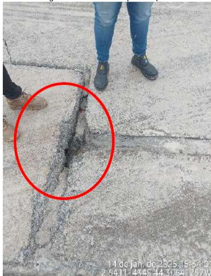
Figura 21: Fissuras no piso do pátio.
