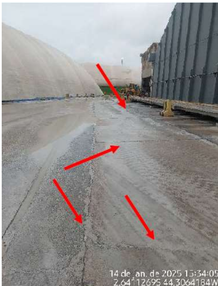
Figura 23: Desgastes na via.
