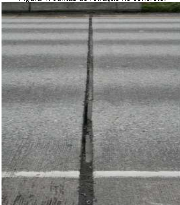
Figura 4: Juntas de retração no concreto.
