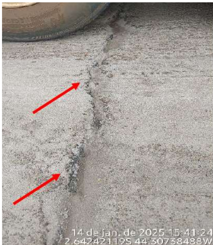
Figura 25: Deformações em decorrência do deslocamento entre placas.
