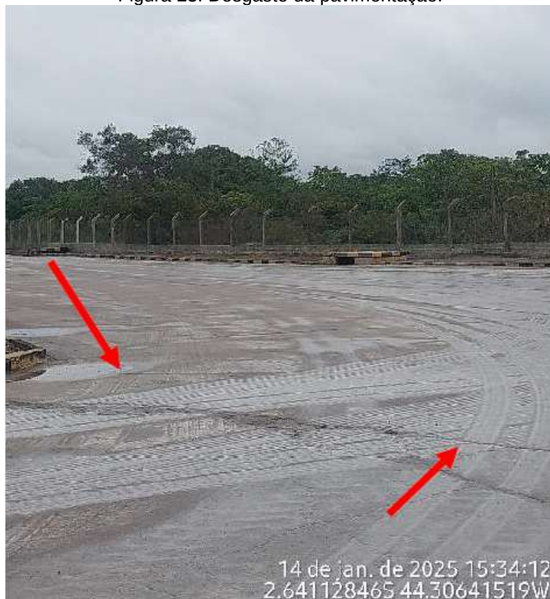
Figura 23: Desgaste da pavimentação.
