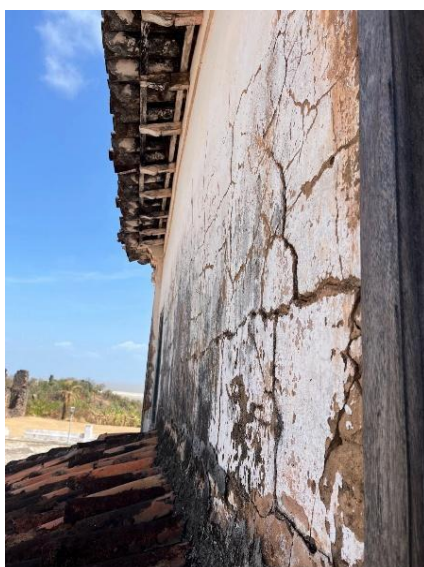
Figura 3: Parede com trincas finas e ramificadas
