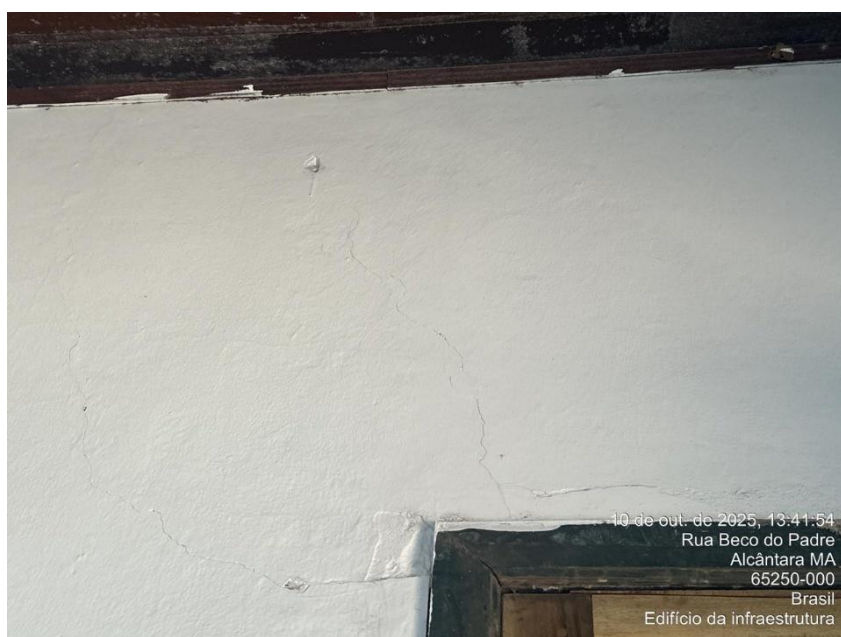
Figura 2: Fissuras na parede da parte interna
