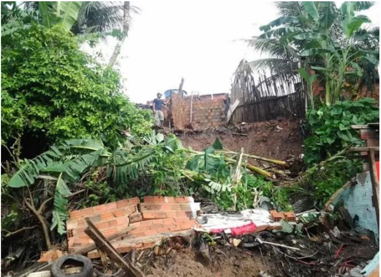
Figura 8 - Deslizamentos no Bairro Coroadinho no município de São Luís (MA).
