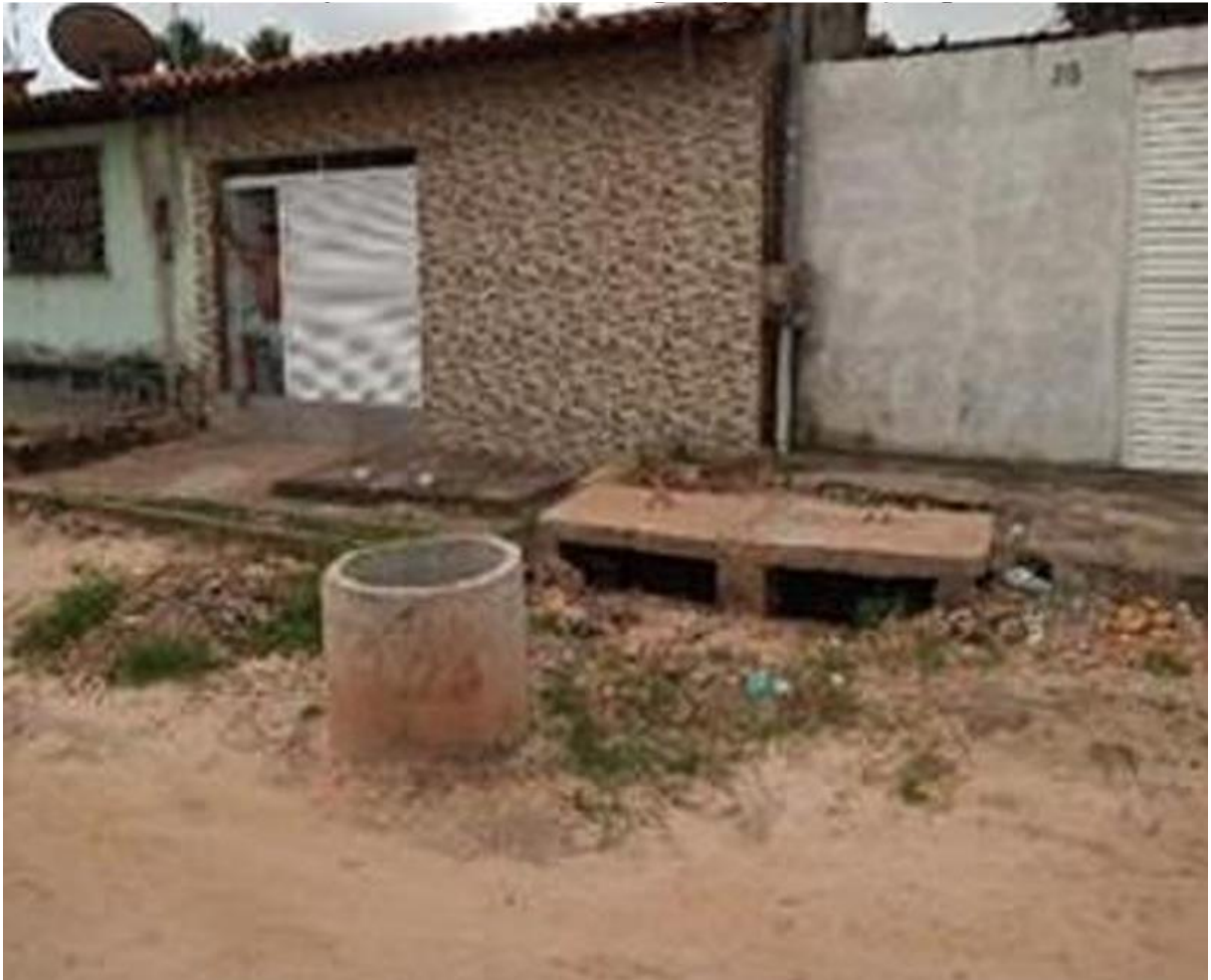
Figura 13 - Exemplos de deficiência dos sistemas de drenagem em áreas de encosta, evidenciando processos erosivos, escoamento superficial descontrolado e degradação das condições geotécnicas do terreno.
