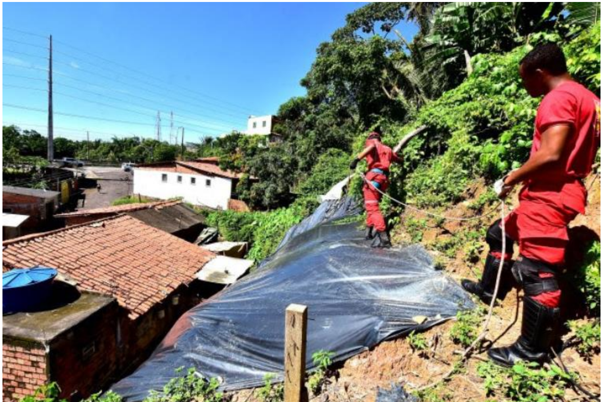
Figura 4 - Área de risco no município de São Luís (MA), evidenciando ocupação em encosta e suscetibilidade a processos erosivos e deslizamentos.
