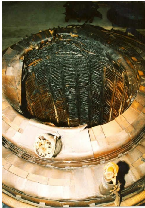
Figura 3.3: Danos catastróficos por superaquecimento e carbonização nos enrolamentos de um transformador
