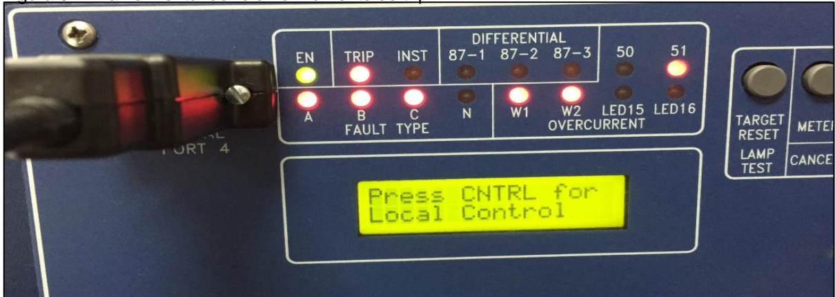
Figura 54 - Painel frontal do relé no momento de trip.
