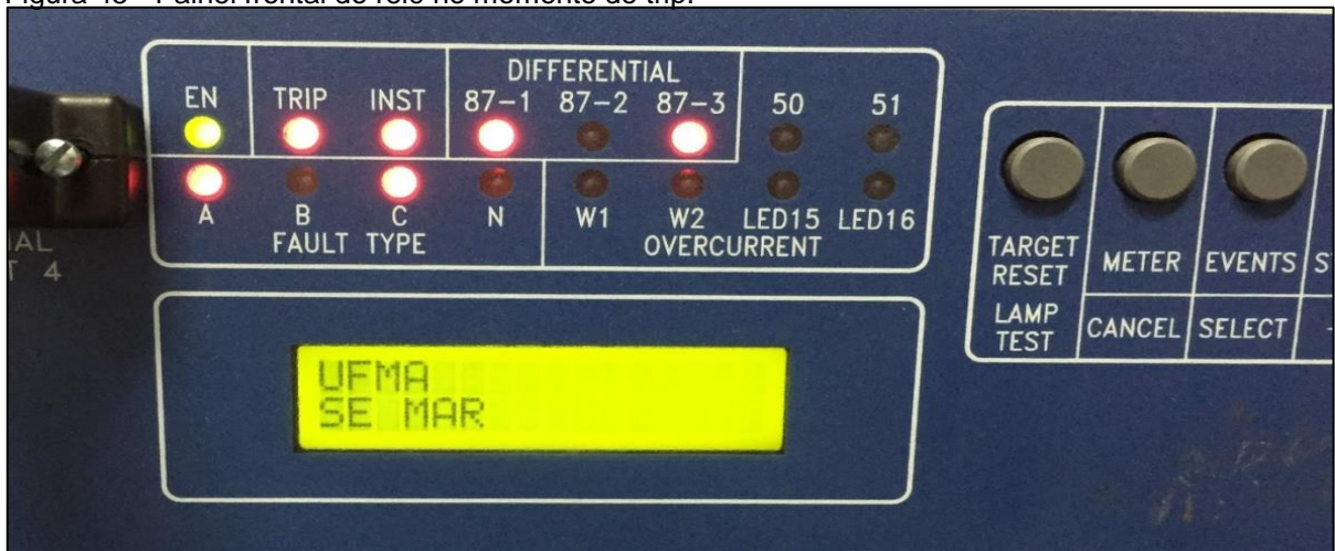
Figura 45 - Painel frontal do relé no momento de trip.
