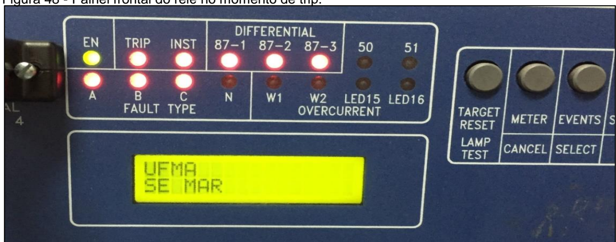
Figura 48 - Painel frontal do relé no momento de trip.
