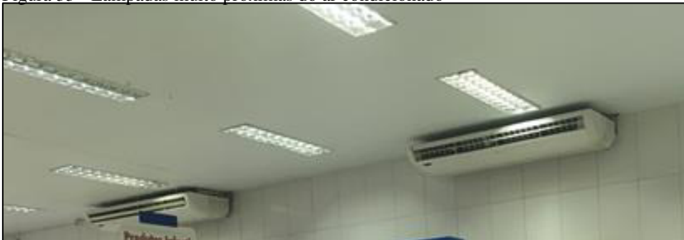
Figura 33 - Lâmpadas muito próximas do ar condicionado
