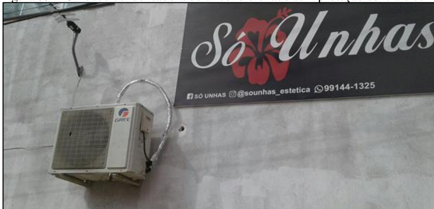
Figura 39 – Unidade condensadora do ar condicionado sem proteção contra o sol
