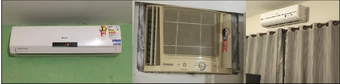
Figura 27 - Ar condicionados e proteção solar interna
