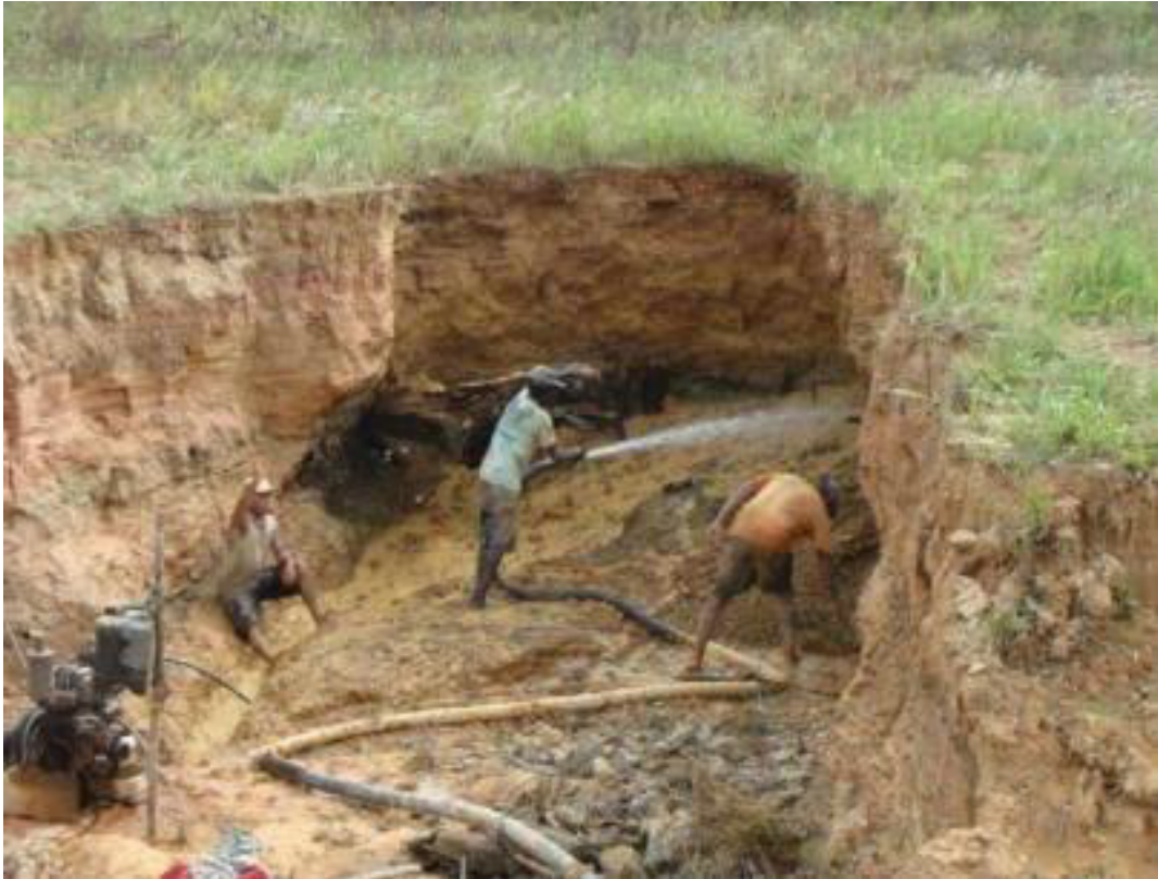
Figura 12 – Risco iminente de queda de barranco e falta de EPI
