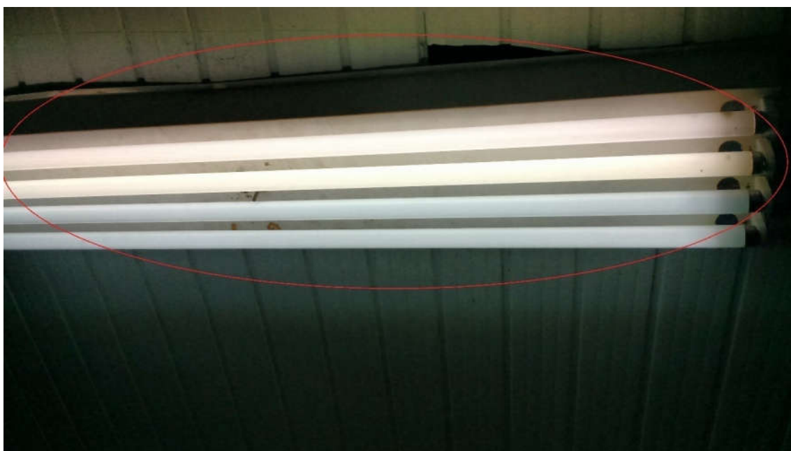
Fotografia 34 – Teto e suporte das lâmpadas da Sala 01
