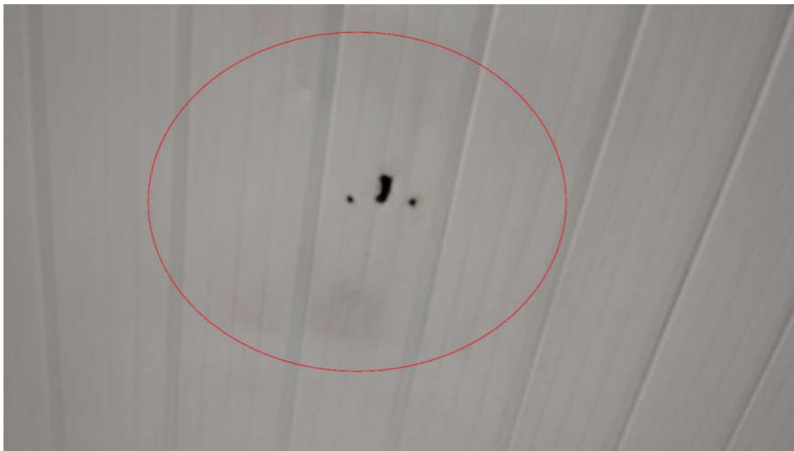
Fotografia 35 – Buraco no teto da Sala 01
