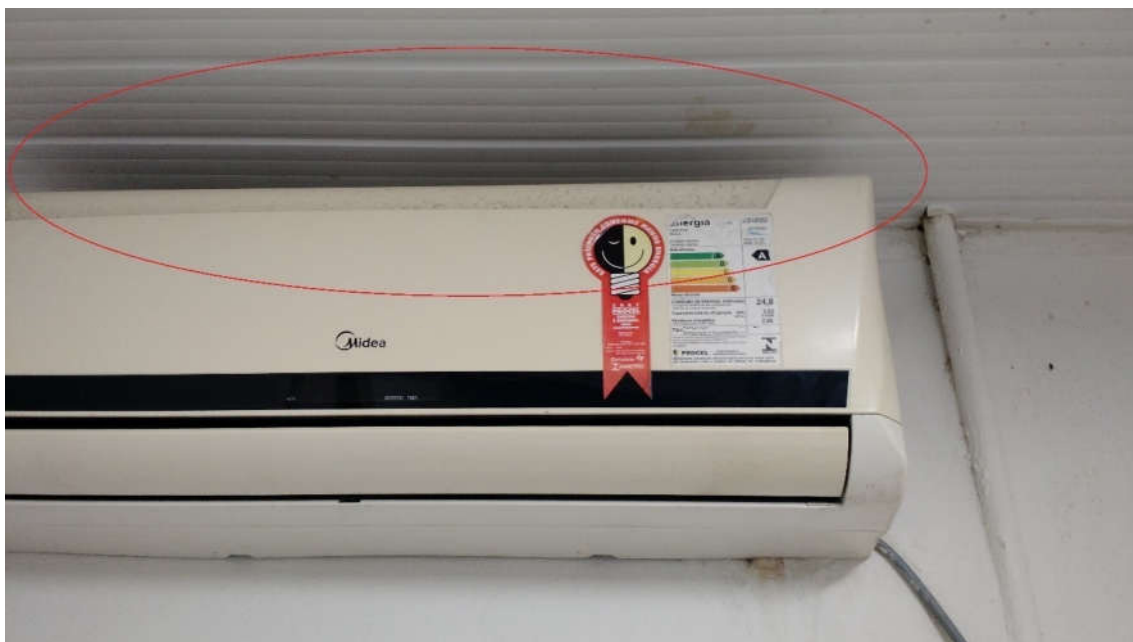
Fotografia 19 – Ar-condicionado da Sala 01
