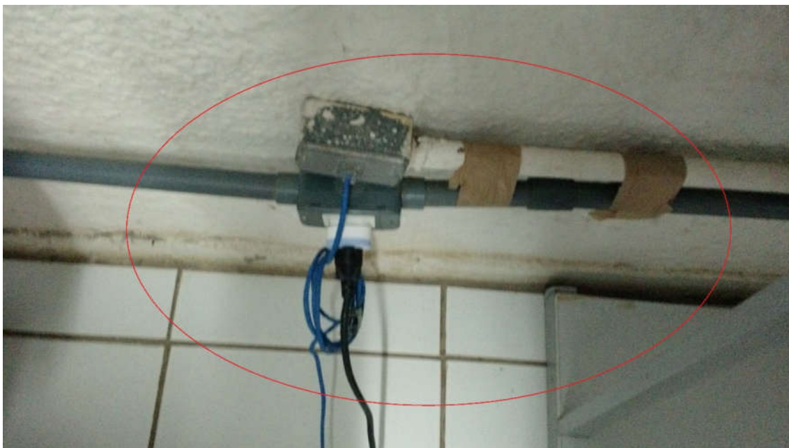
Fotografia 70 – Cabeamento e parte elétrica na Sala 02
