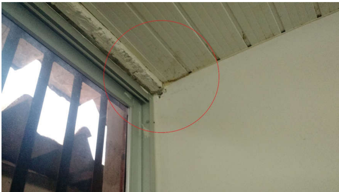
Fotografia 72 – Canto do teto próximo à janela na Sala 02
