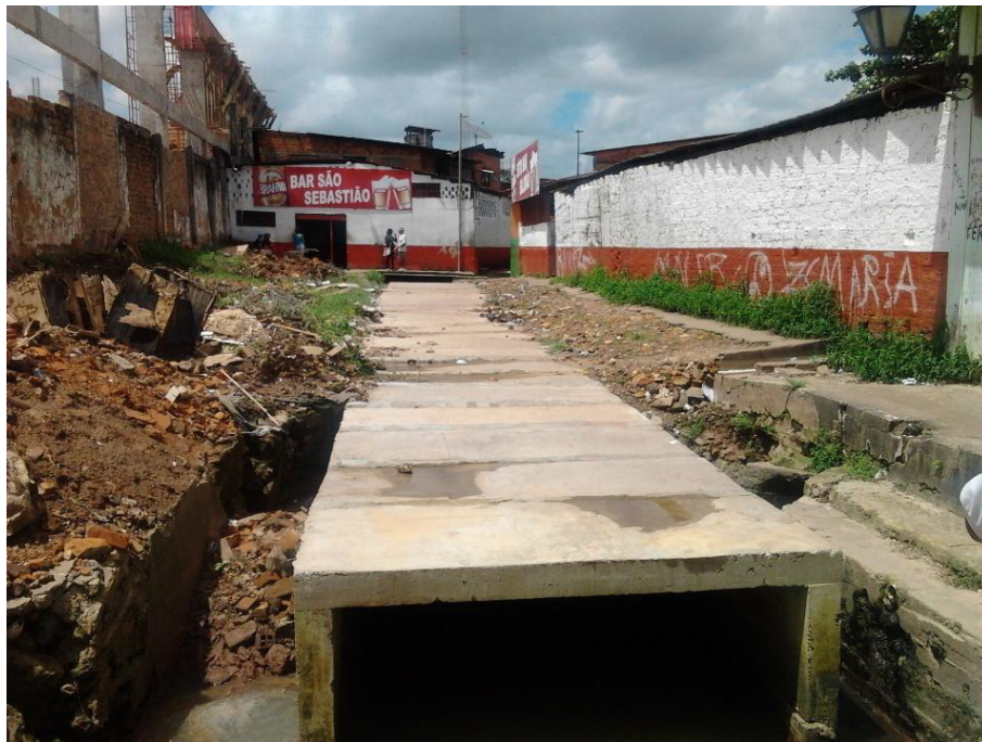
Figura 11 – Células de canalização da macrodrenagem
