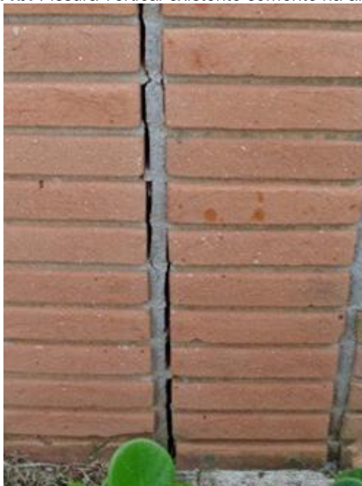
Figura 11b: Fissura vertical existente somente na argamassa
