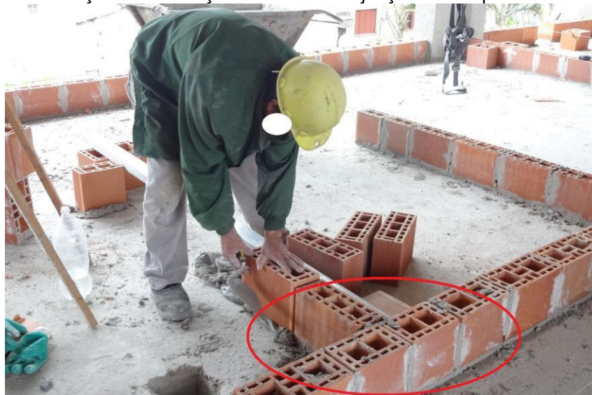
Figura 33: Locação de amarração das fiadas em junção "T" em paredes de meia vez
