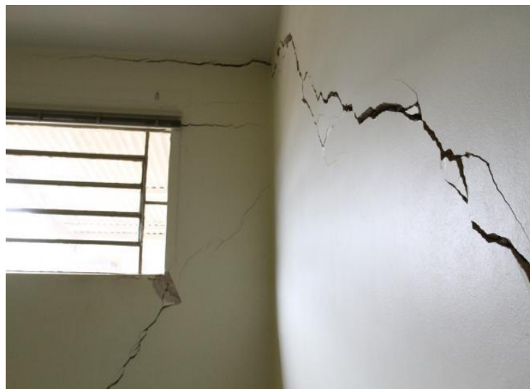
Figura 14b: Fissuras devido a recalque diferencial de fundações
