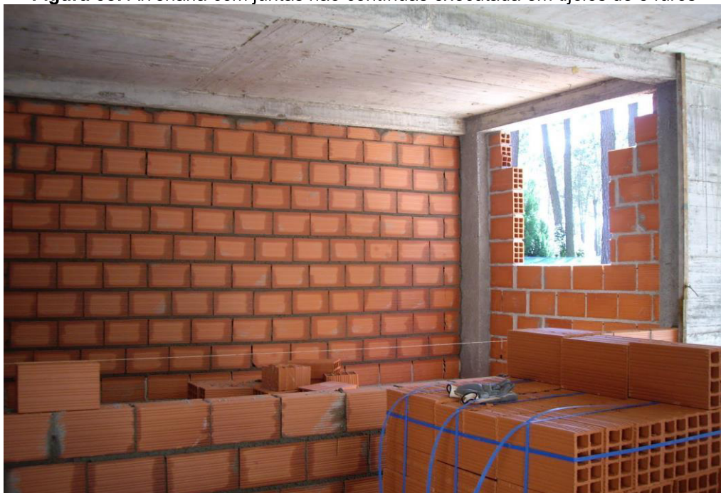
Figura 38: Alvenaria com juntas não contínuas executada em tijolos de 8 furos
