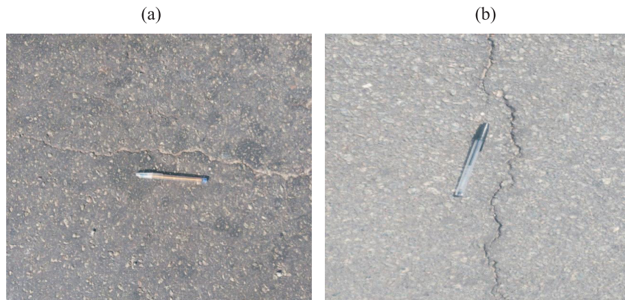
Figura 52 – Trincas (a) longitudinal e (b) transversal na estação 10
