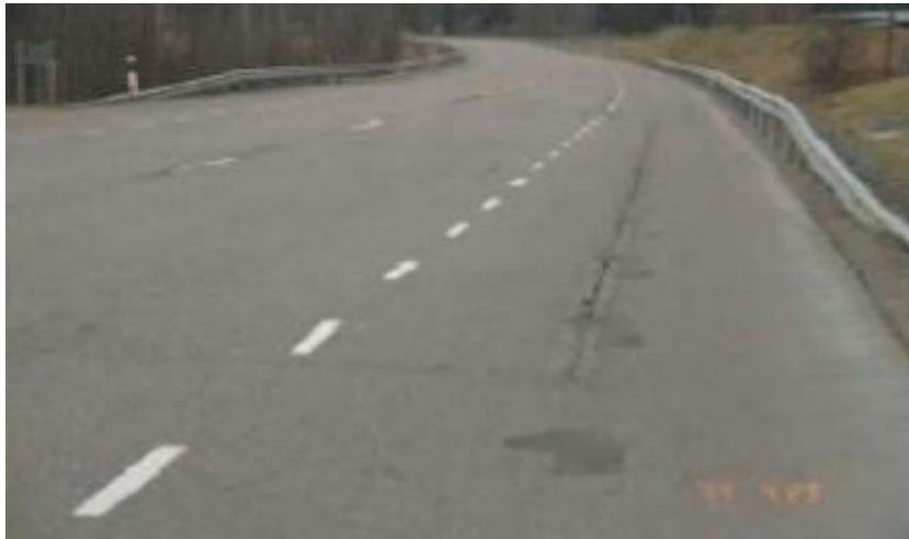
Figura 16 – Fendilhamento longitudinal por retração térmica
