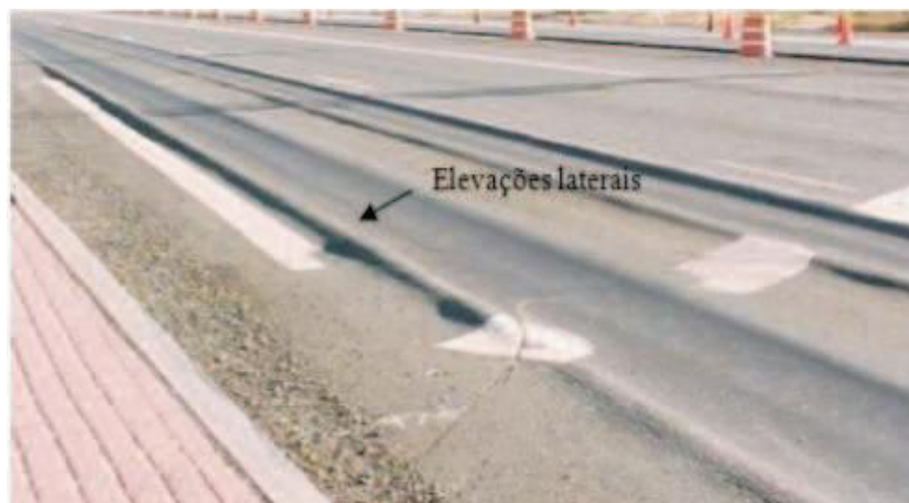
Figura 13 – Rodeiras por deformação excessiva
