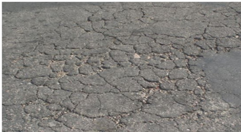
Figura 14 – Fendilhamento por fadiga
