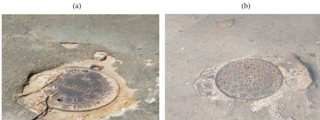
Figura 61 – Imperfeições em tampa de PV nas estações (a) 45 e (b) 149
