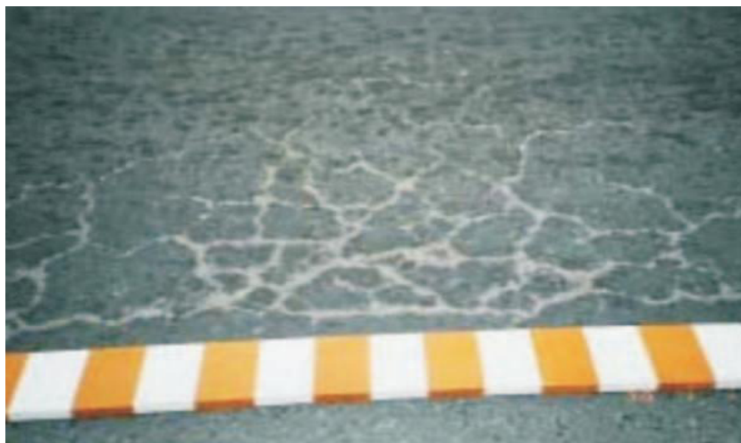
Figura 17 – Fendilhamento em malha larga
