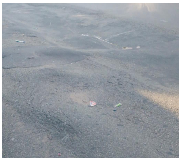
Figura 56 – Ondulações em revestimento da estação 162
