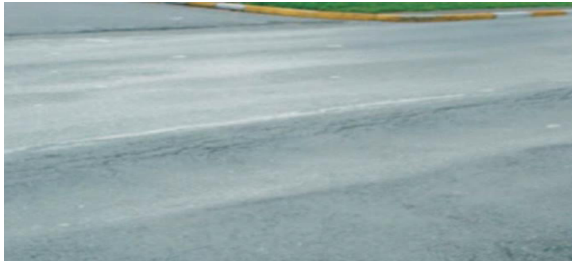
Figura 31 – Afundamento plástico nas trilhas de roda
