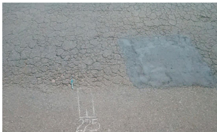
Figura 54 – Estação 225 em estágio de fadiga avançado
