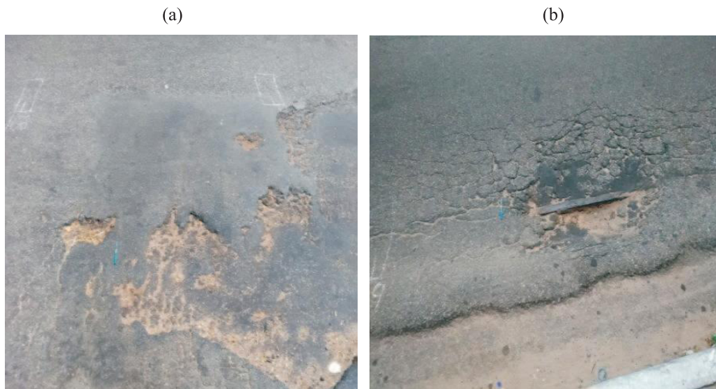
Figura 50 – Defeitos atípicos nas estações (a) 114 e (b) 209
