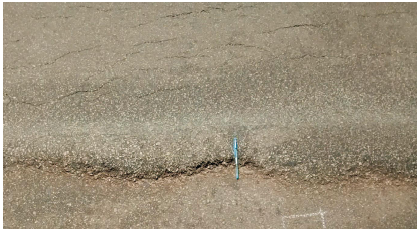
Figura 63 – Solevamento lateral do afundamento plástico de trilha na estação 125
