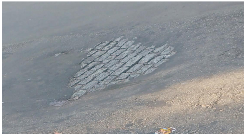
Figura 62 – Deslocamento do revestimento asfáltico na estação 168
