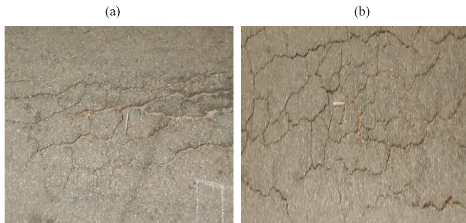
Figura 53 – Trinca interligada tipo couro de jacaré com erosão nas estações (a) 29 e (b) 82
