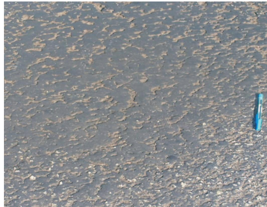
Figura 65 – Exsudação na estação 123
