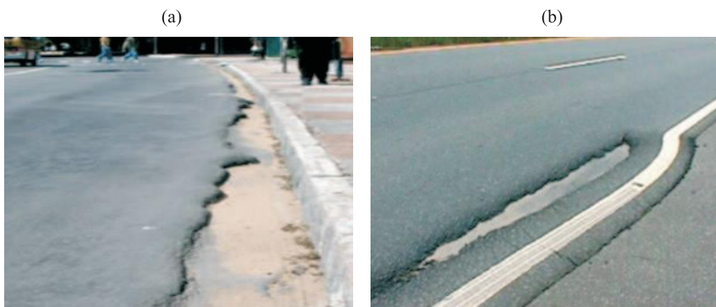
Figura 35 – Escorregamento (a) do revestimento (b) da massa asfáltica
