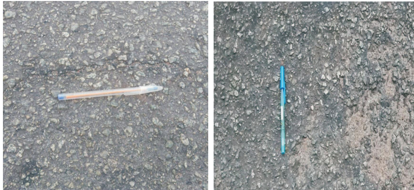
Figura 55 – Desgaste do pavimento na estação 12
