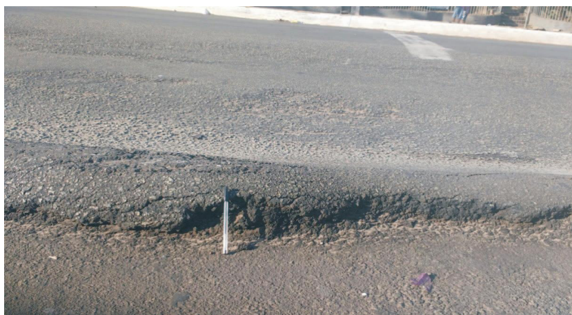
Figura 64 – Afundamento plástico de trilha de roda na estação 187
