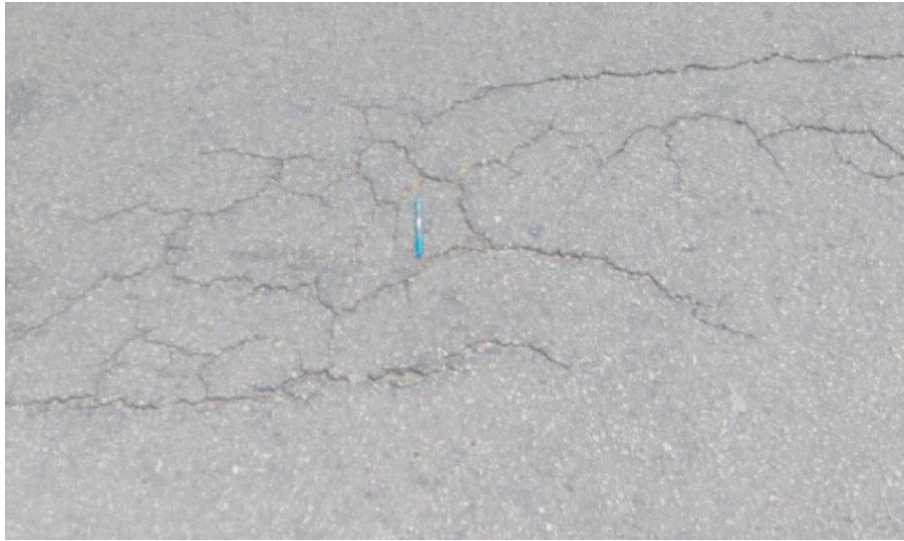
Figura 30 – Fendas interligadas tipo couro de jacaré
