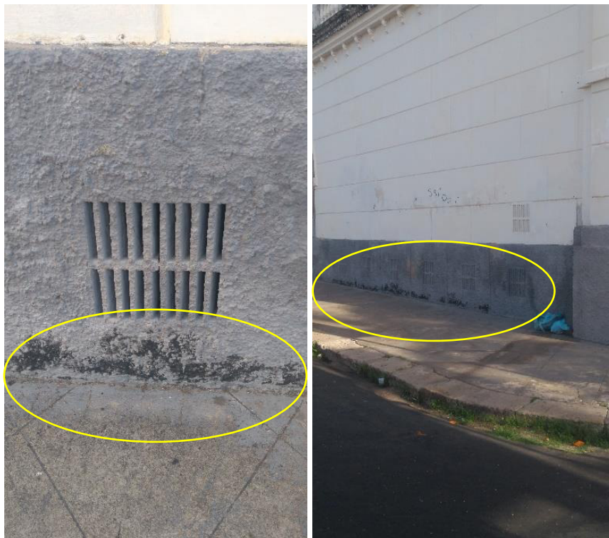
Figura 37 - Manchas na parte inferior da fachada lateral esquerda
