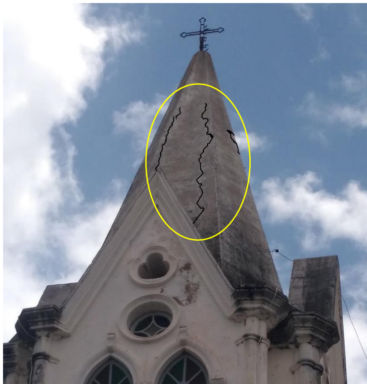
Figura 25 – Detalhe das fendas
