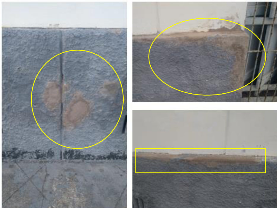
Figura 49 - Indícios de reparos feitos
