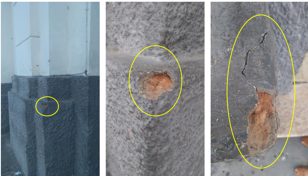
Figura 20 - Descolamento do revestimento
