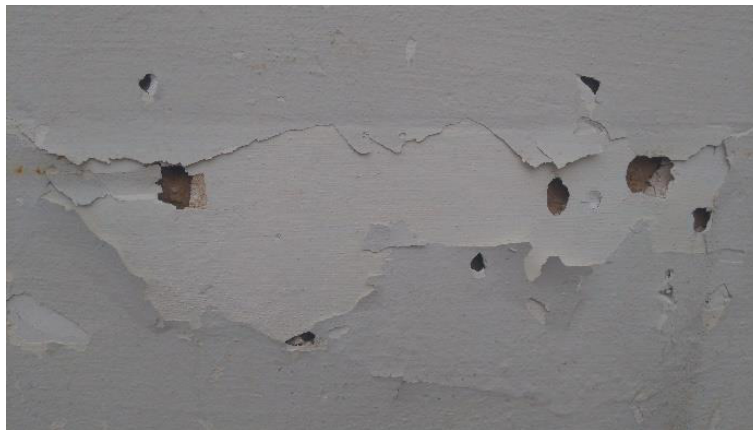
Figura 41 - Descolamento do revestimento argamassado na fachada lateral direita
