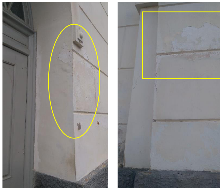
Figura 33 - Descascamento da pintura.
