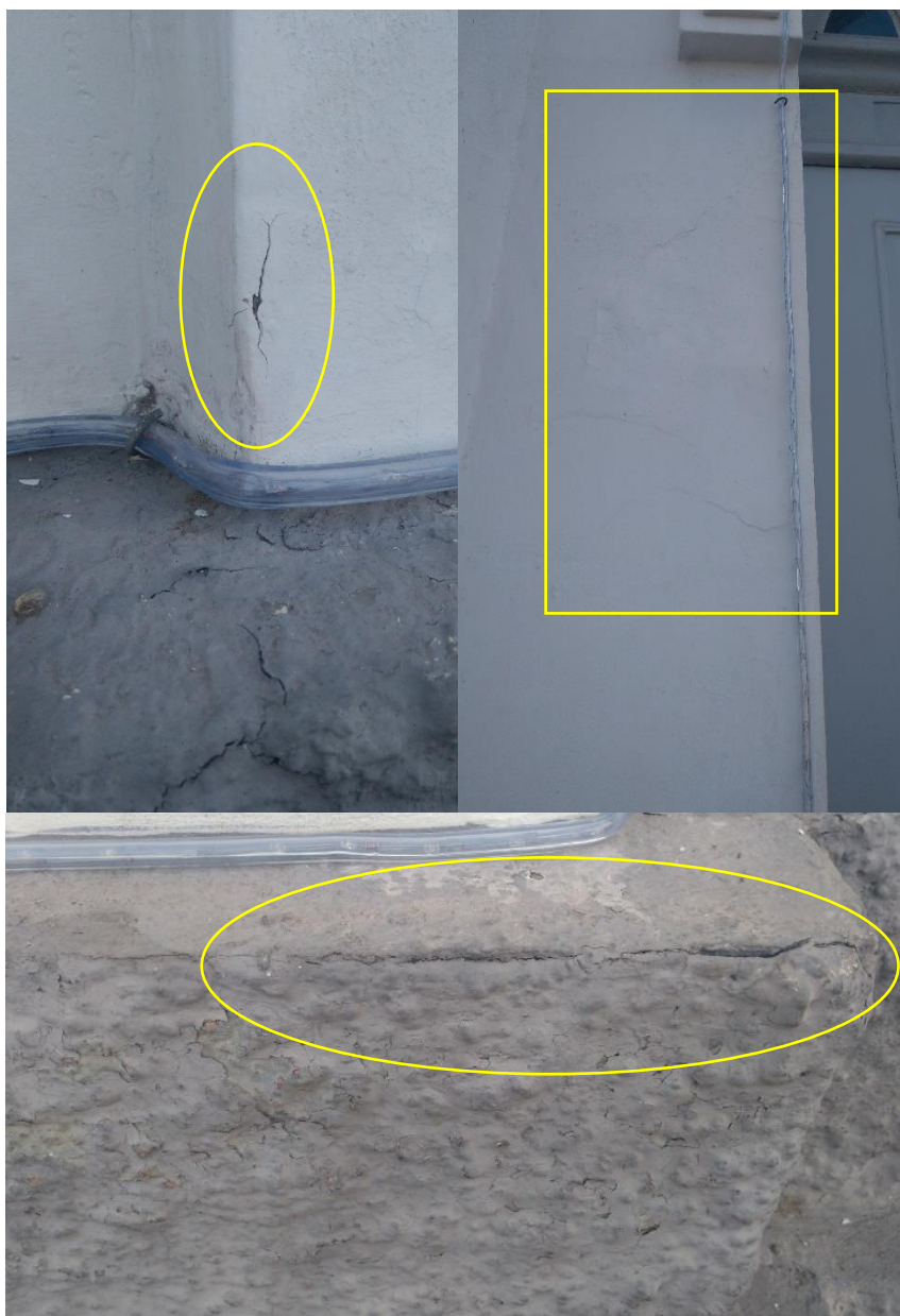
Figura 23 - Fissuras incidentes na fachada principal
