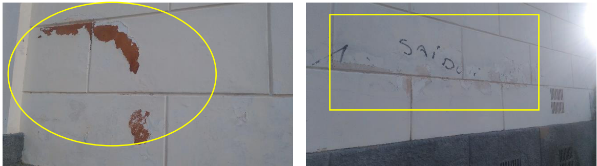
Figura 32 - Descolamento da pintura e pichação
