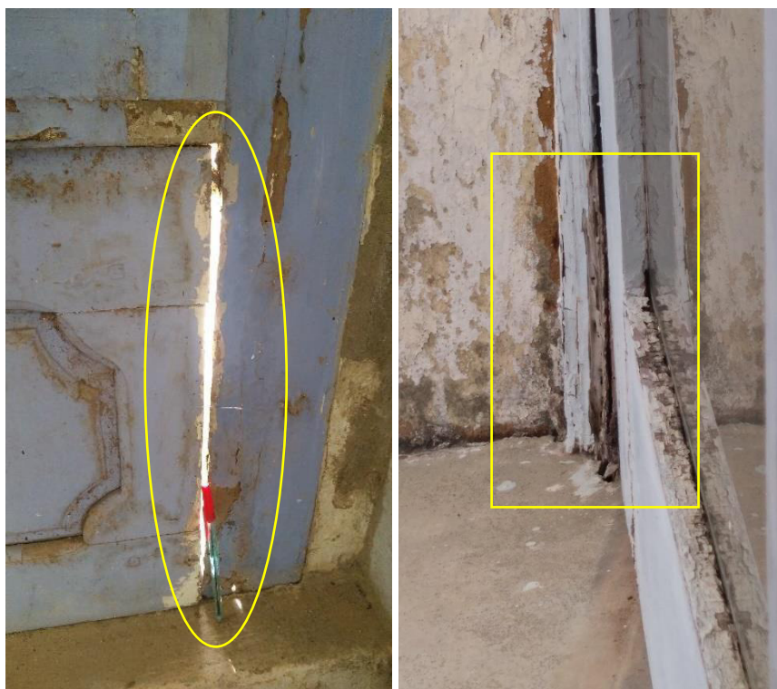
Figura 52 - Esquadria com madeira deteriorada
