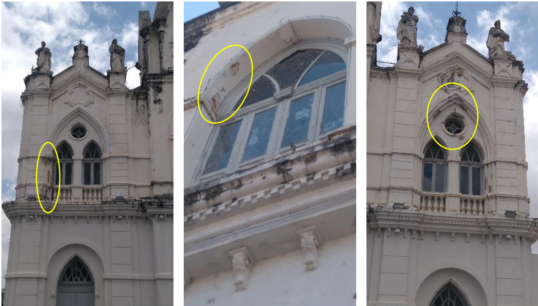
Figura 19 - Descolamento da pintura nos detalhes das esquadrias
