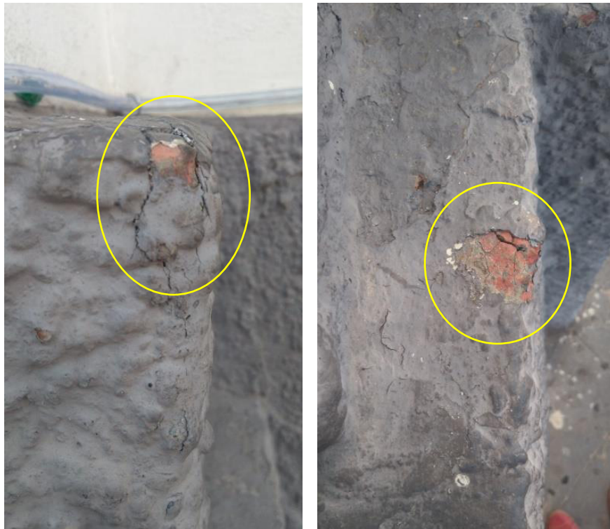
Figura 18 - Descolamento de pintura nas extremidades das paredes
