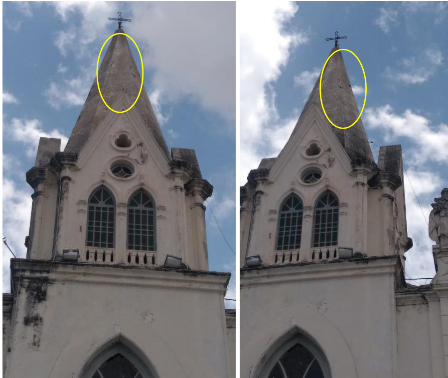
Figura 24 - Fendas na cobertura da torre
