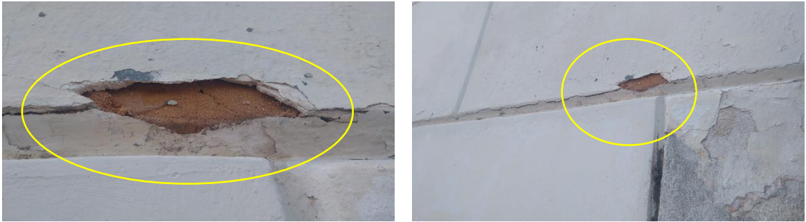
Figura 30 - Descolamento do revestimento nos detalhes da fachada
