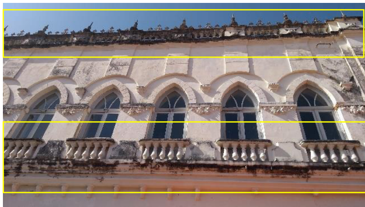
Figura 43 - Bolor na parte superior da fachada lateral direita
