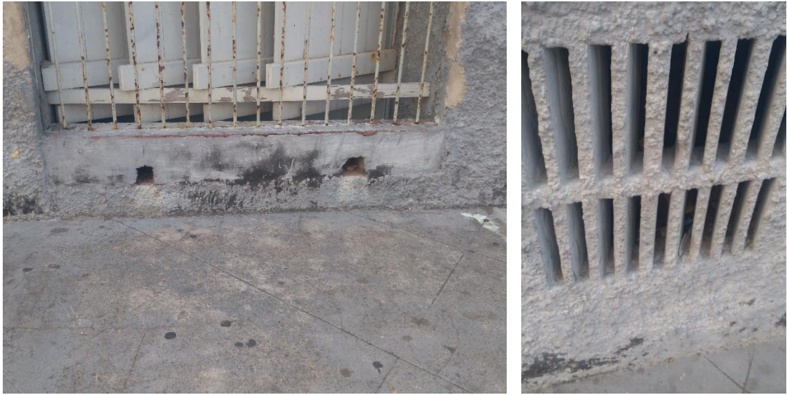
Figura 48 – Aberturas vulneráveis para o surgimento de patologias
