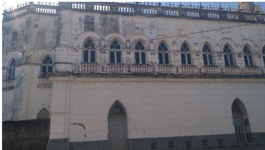
Figura 38 - Manchas na parte superior da fachada lateral esquerda
