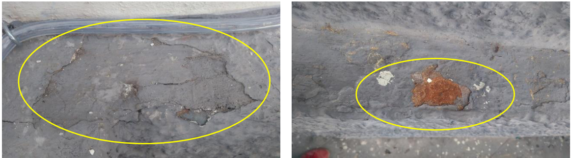
Figura 17 - Descolamento de revestimento nos detalhes horizontais da fachada
