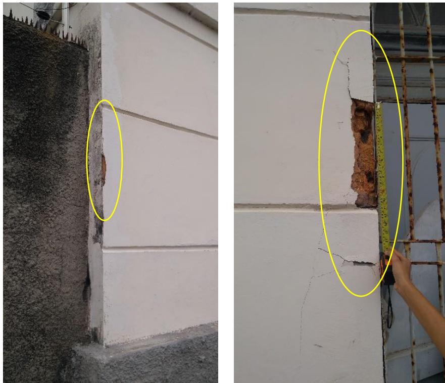
Figura 31 - Descolamento do revestimento nas extremidades das paredes
