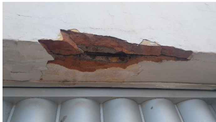
Figura 22 – Detalhe da fachada com armadura exposta
