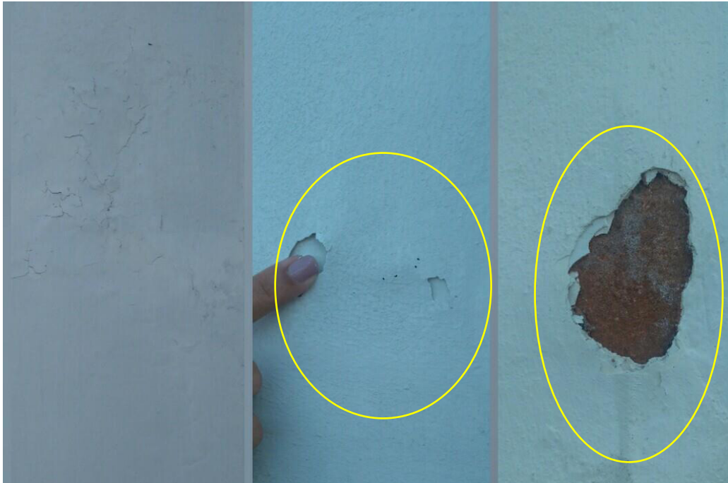
Figura 14 - Fases do descolamento da pintura
