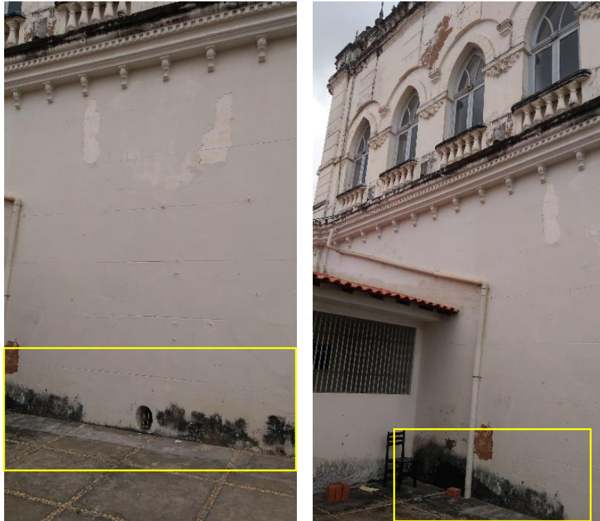
Figura 42 - Presença de bolor na fachada lateral direita
