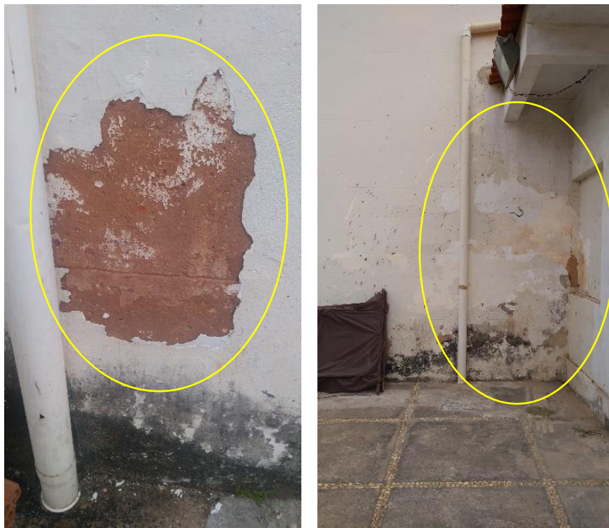
Figura 40 - Descolamento da pintura na fachada lateral direita
