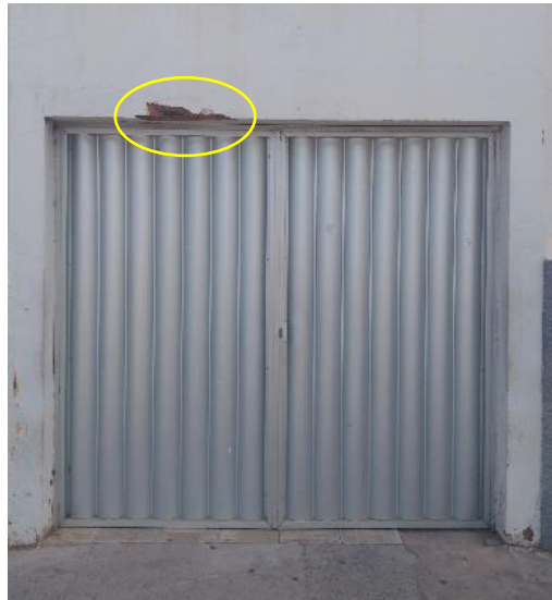
Figura 21 - Descolamento de revestimento com armadura exposta
