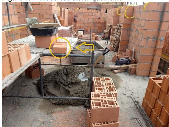
Figura 15 – Bloco estrutural quebrado
