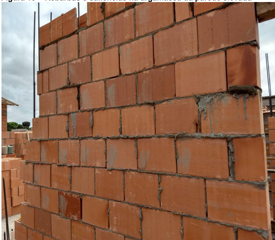
Figura 19 – Rebarbas e saliências na argamassa da parede elevada
