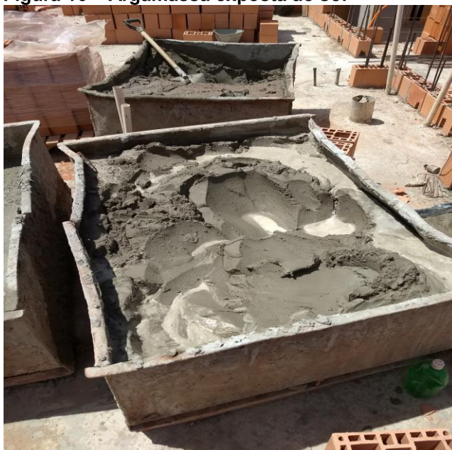
Figura 16 – Argamassa exposta ao sol
