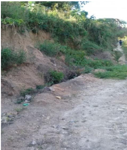
Figura 04: Erosão na extensão da nascente.
