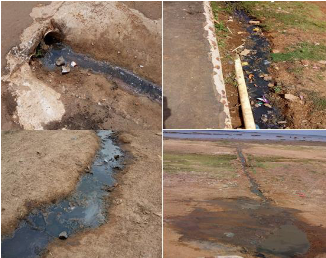
Imagem 5 Um dos pontos de lançamento de esgoto.
