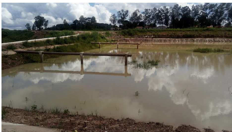
Figura 2 Tanque Com Dejetos na Estação de Tratamento no Novo Bacabal
