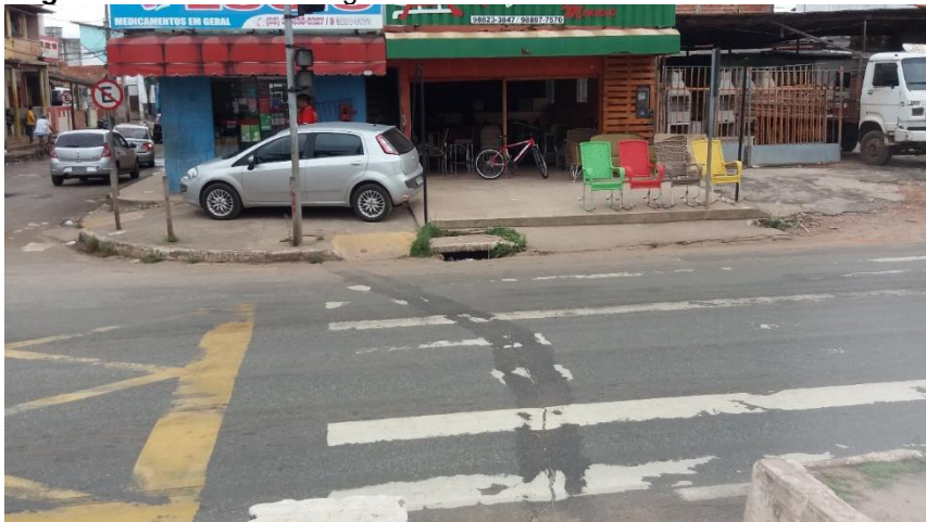
Figura 36 – Ponto de Alagamento – Avenida dos Africanos
