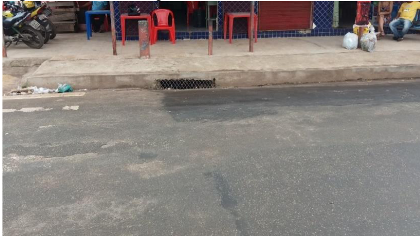
Figura 35 – Ponto de Alagamento – Avenida dos Africanos
