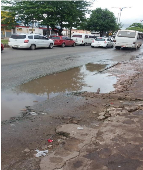
Figura 34 – Ponto de Alagamento – Avenida dos Africanos
