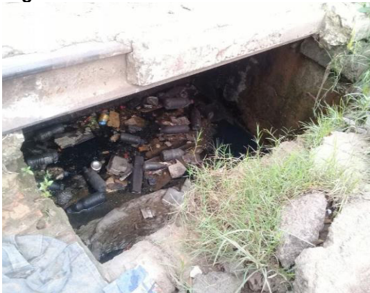
Figura 40 – Boca de lobo obstruída
