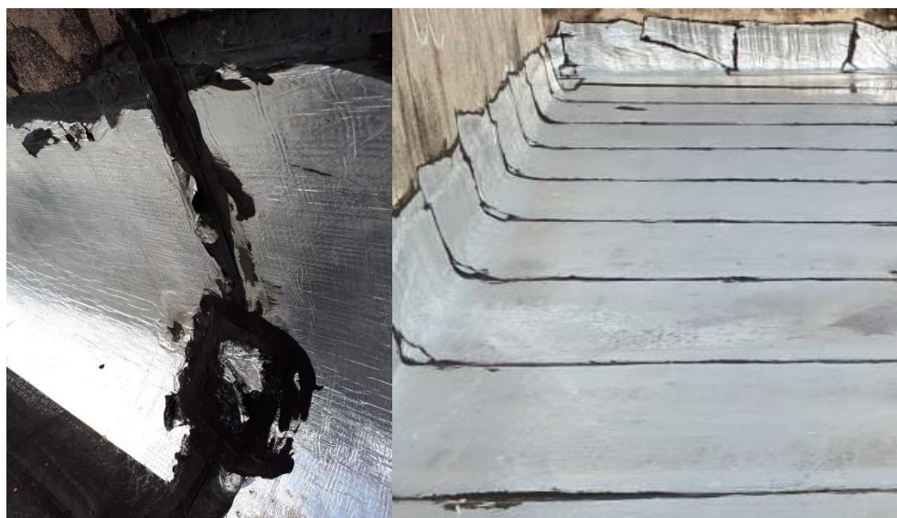
Figura 22 – Sobreposição inadequada das mantas.
