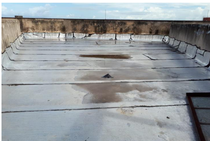
Figura 18 – Ausência de drenagem da água das chuvas sobre a impermeabilização.
