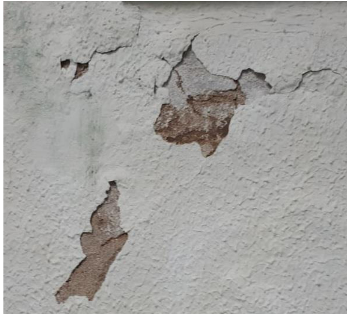
Figura 31 – Degradação de reboco da parede.
