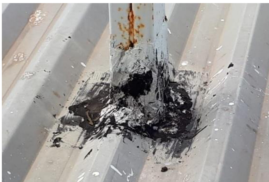
Figura 26 – Arremate inadequado em instalação fixada na estrutura.
