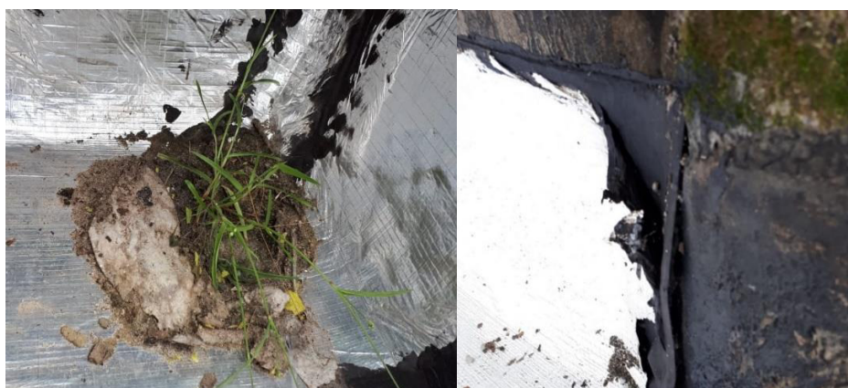
Figura 25 – Problemas na integridade da manta.
