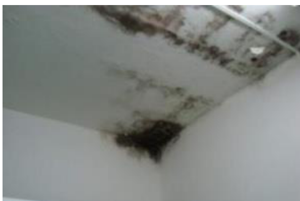
Figura 13 – Presença de mofo em laje.
