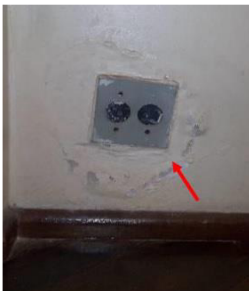
Figura 14 – Empolamento da pintura.
