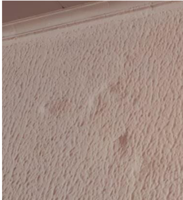
Figura 34 – Empolamento da pintura.
