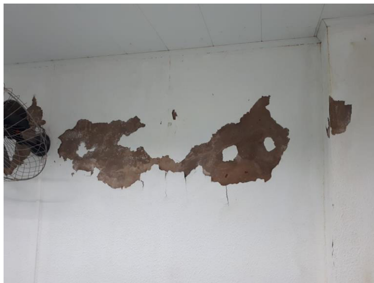
Figura 35 – Descolamento da pintura.
