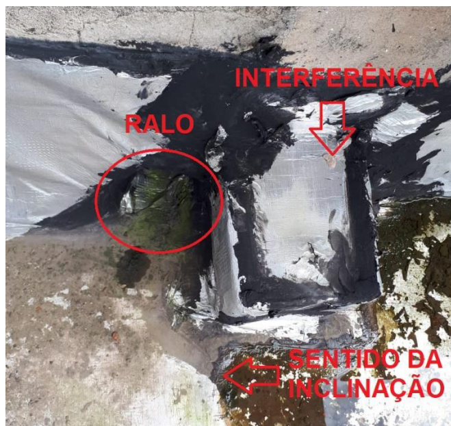
Figura 20 – Disposição inadequada do ralo.
