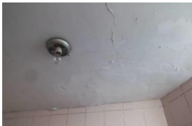
Figura 10 – Decomposição do forro de gesso.
