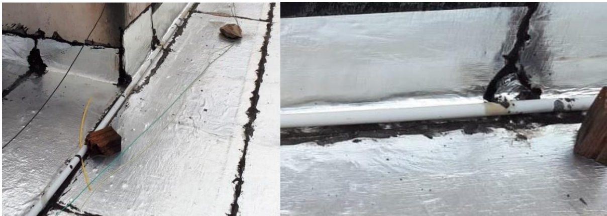
Figura 28 – Tubulação aparente executada sem elevação.
