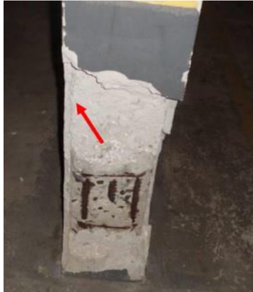
Figura 9 – Degradação do concreto em pilar.
