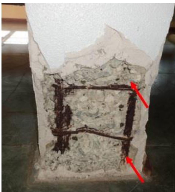
Figura 8 – Corrosão da armadura em pilar.
