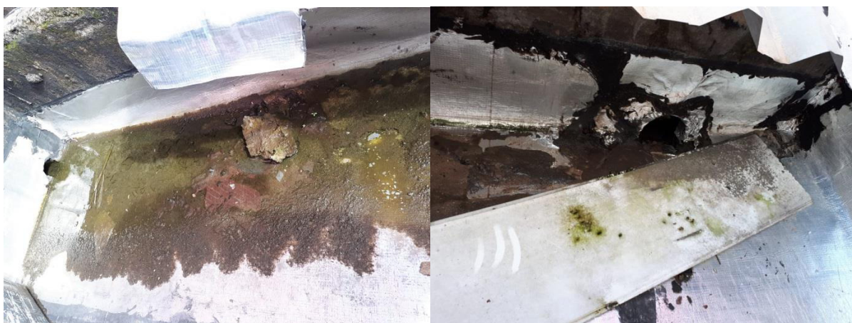
Figura 19 – Sujeira e obstrução do caminho de percolação da água.
