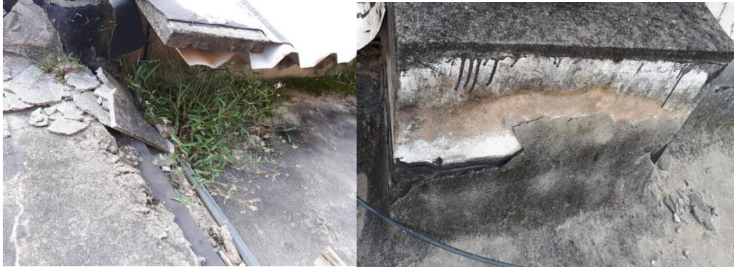
Figura 27 – Problemas na integridade da proteção mecânica.
