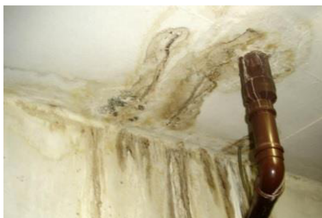
Figura 12 – Manchas de umidade.
