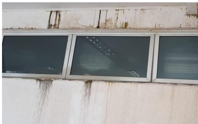
Figura 32 – Manchas de umidade na parede.
