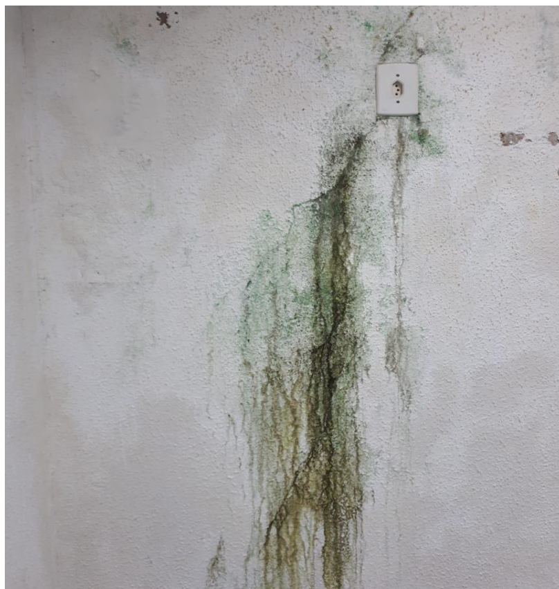
Figura 33 – Formação de mofo e bolor na parede.
