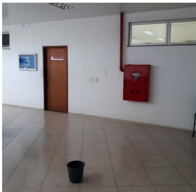
Figura 30 – Gotejamento da laje de cobertura.
