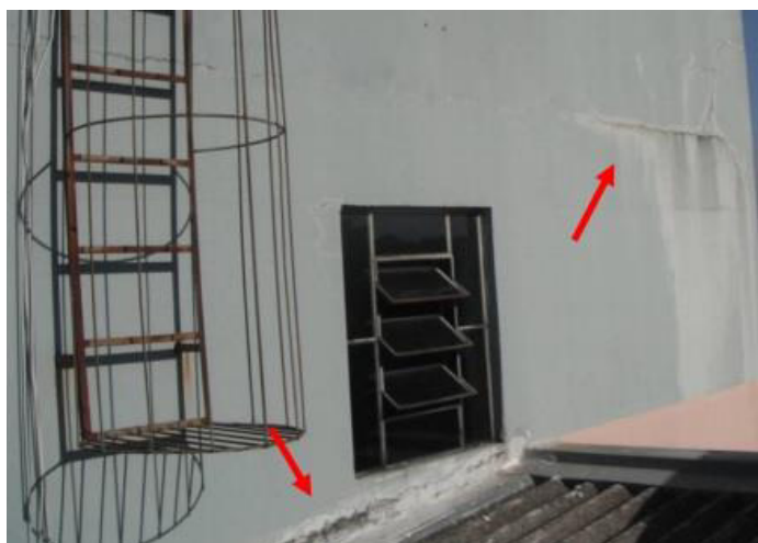
Figura 11 – Eflorescência em platibanda e abaixo da janela.
