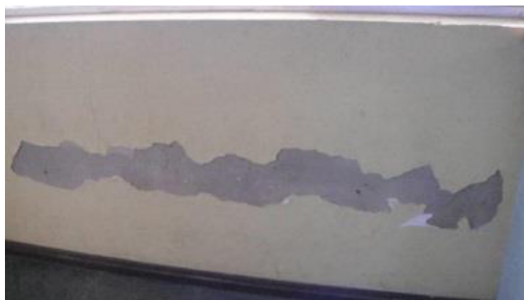
Figura 15 – Descolamento de pintura.
