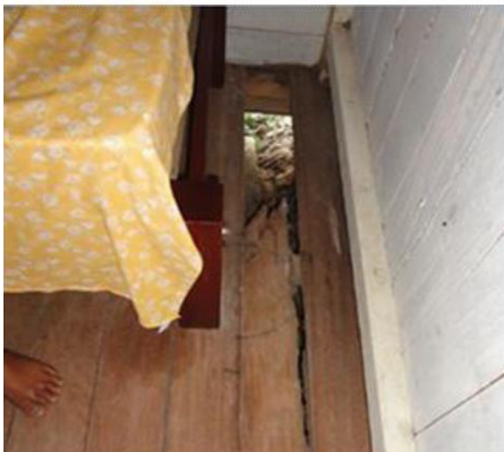
Figura 1 – Falha no Piso
