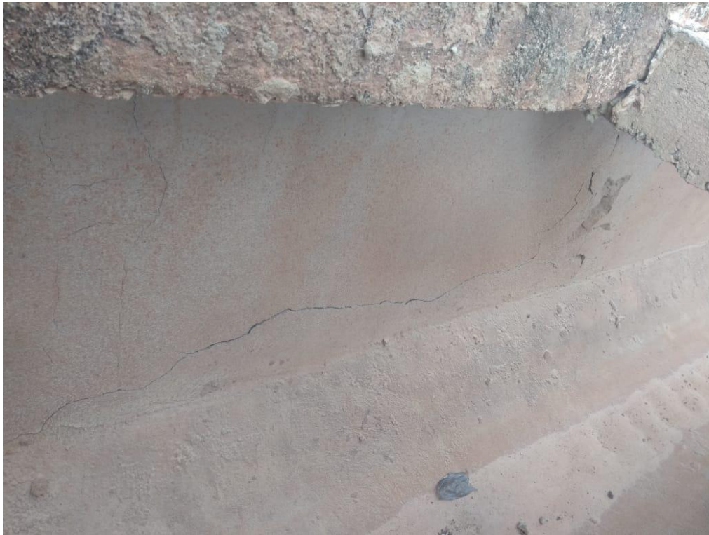
Figura 22 – Trinca Fonte: Autora, 2018.
