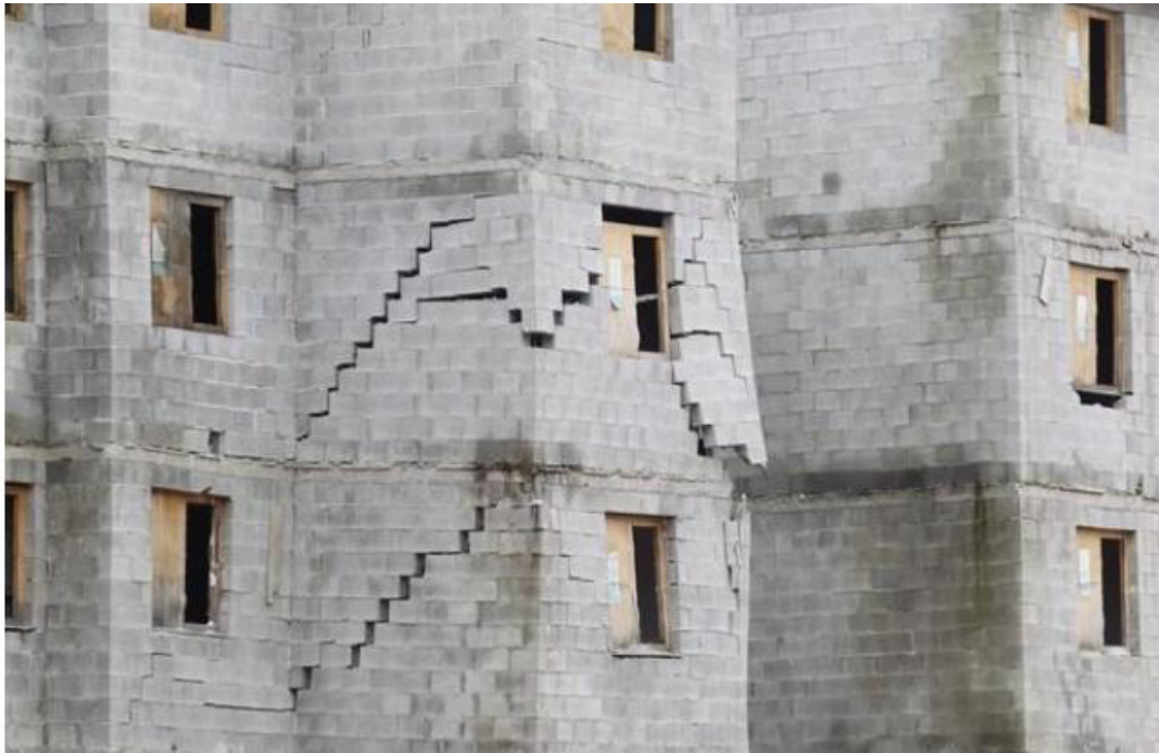
Figura 4 – Alvenaria Estrutural Comprometida
