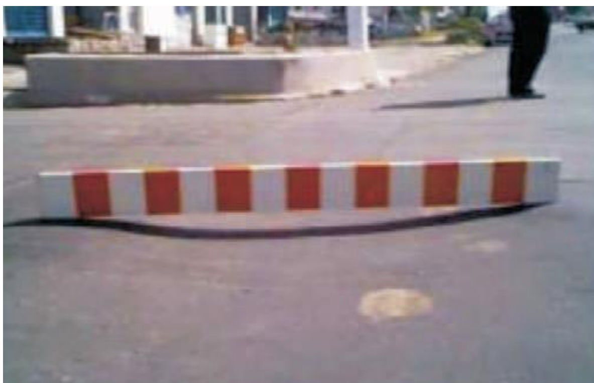
Figura 12 - Afundamento por consolidação
