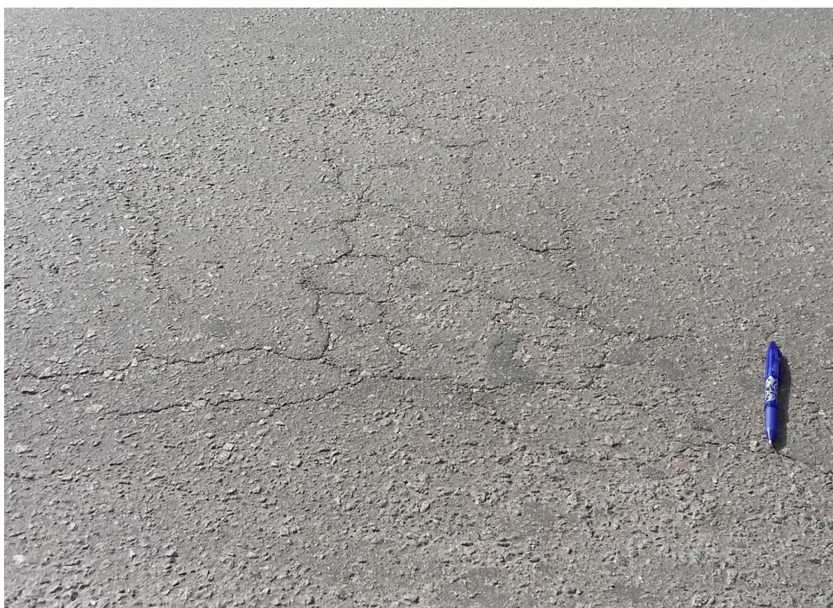
Figura 26 - Trincas interligadas sem erosão
