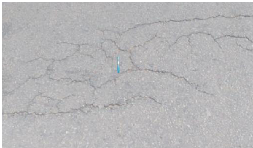
Figura 9 - Trinca tipo “Couro de Jacaré”
