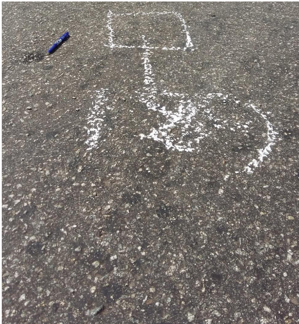
Figura 27: superfície desgastada (estação 189)
