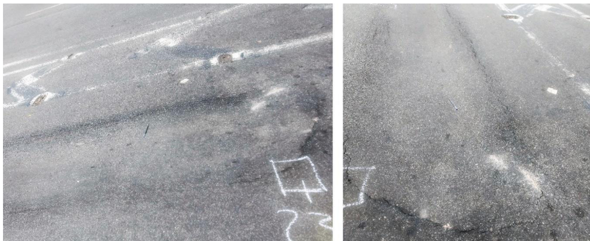
Figura 31 - Afundamento de trilha de roda (estação 230)
