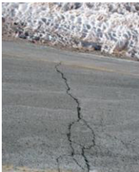
Figura 8 - trinca de retração
