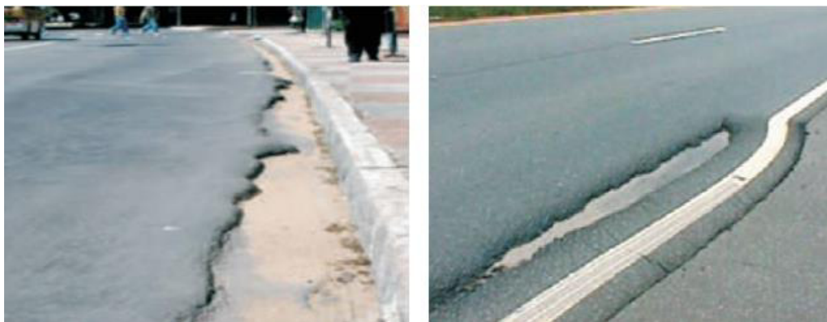
Figura 15 - Escorregamento (a) do revestimento (b) da massa asfáltica
