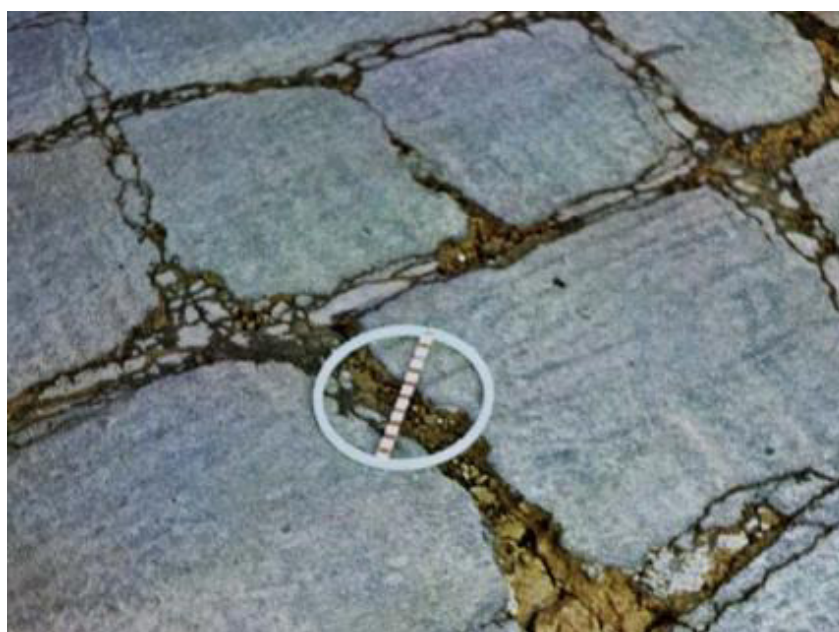
Figura 10 - Trinca tipo “Bloco”
