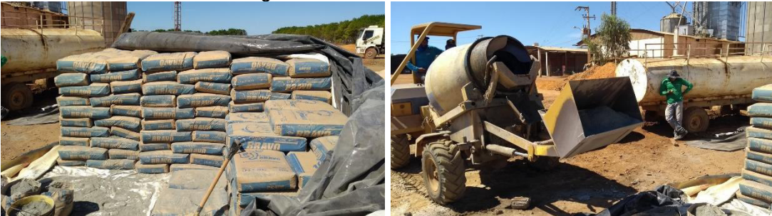
Figura 24 - Central de concreto
