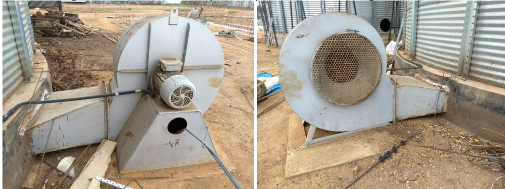
Figura 9 - Ventiladores para o processo de aeração dos silos
