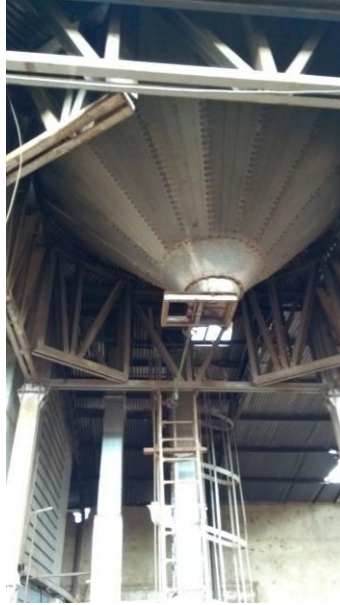
Figura 10 - Silo de expedição
