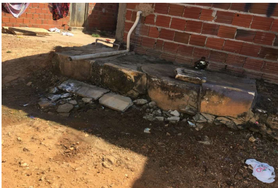
Figura 5 – Tubulações de esgoto direcionadas para as ruas
