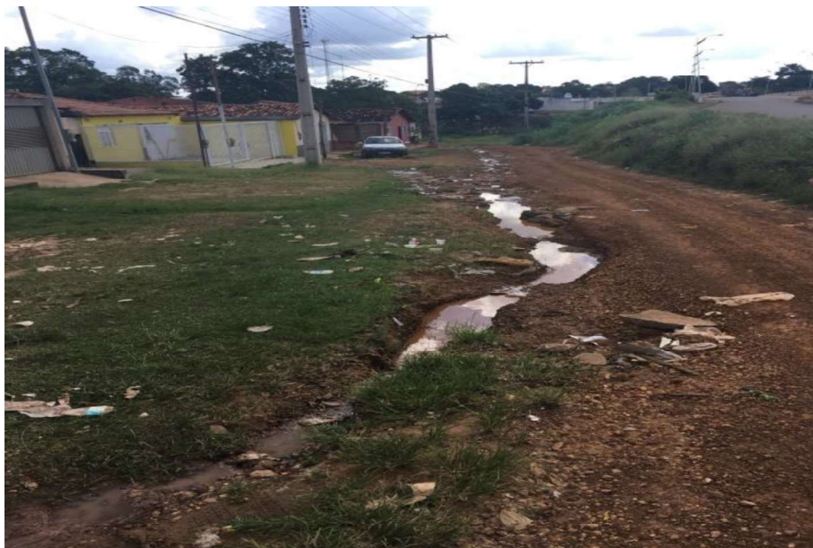
Figura 1 - Rua sem pavimentação e com problemas de infraestrutura
