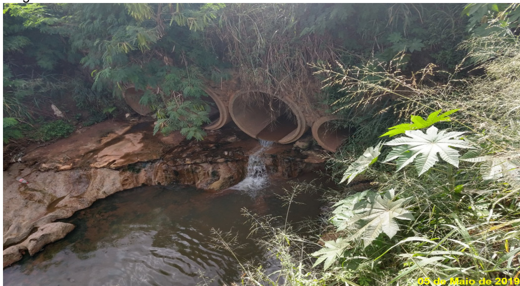
Figura 26: Bueiros tubulares de concreto na BR-230 das zonas ZR P e ZR CJ.
