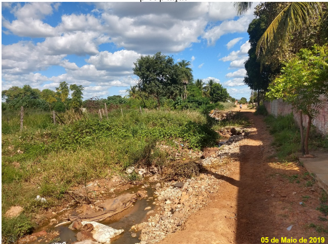
Figura 1: Erosões na Rua 07 da Zona Residencial Potosí após alguns eventos de precipitação.
