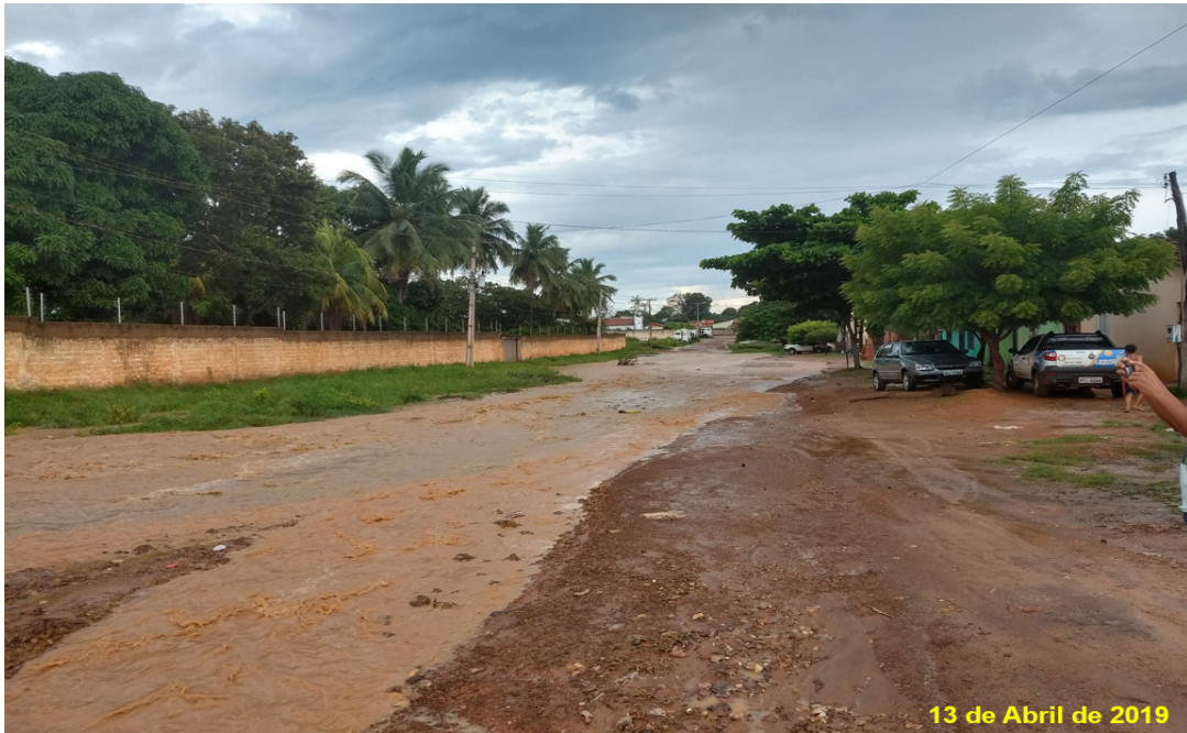
Figura 11: Ponto de alagamento na Avenida Juscelino Kubitschek da Zona Residencial Potosí.
