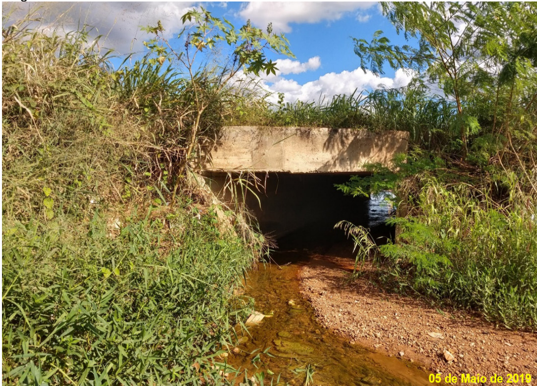
Figura 24: Bueiro celular de concreto localizado na Avenida Brasil da zona ZR P.
