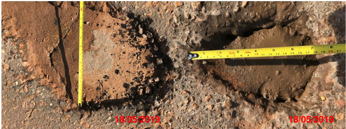
Figura 64 - Buracos no pavimento da Ponte 05.
