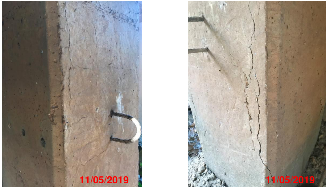
Figura 33 - Fissuras nos pilares.
