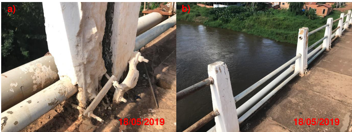
Figura 61 - a) Desagregação do concreto e exposição de armaduras nos pilares do guarda corpo. b) Local com ausência de barra metálica no guarda corpo.
