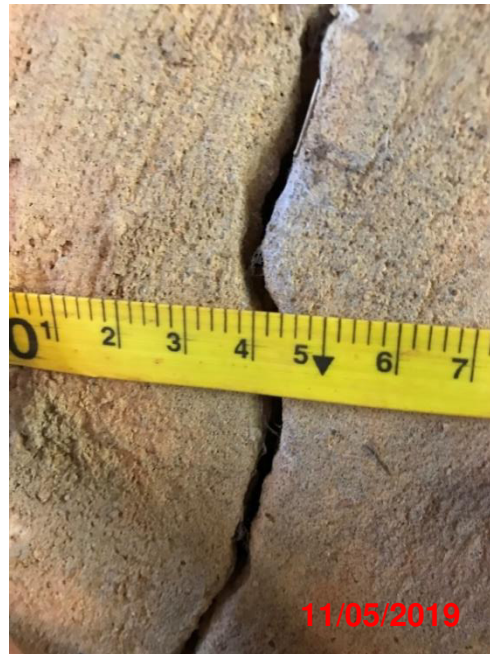
Figura 56 - Abertura de fenda no muro de arrimo.
