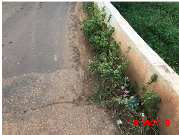
Figura 84 - Trinca no pavimento e crescimento de vegetação na lateral da pista.
