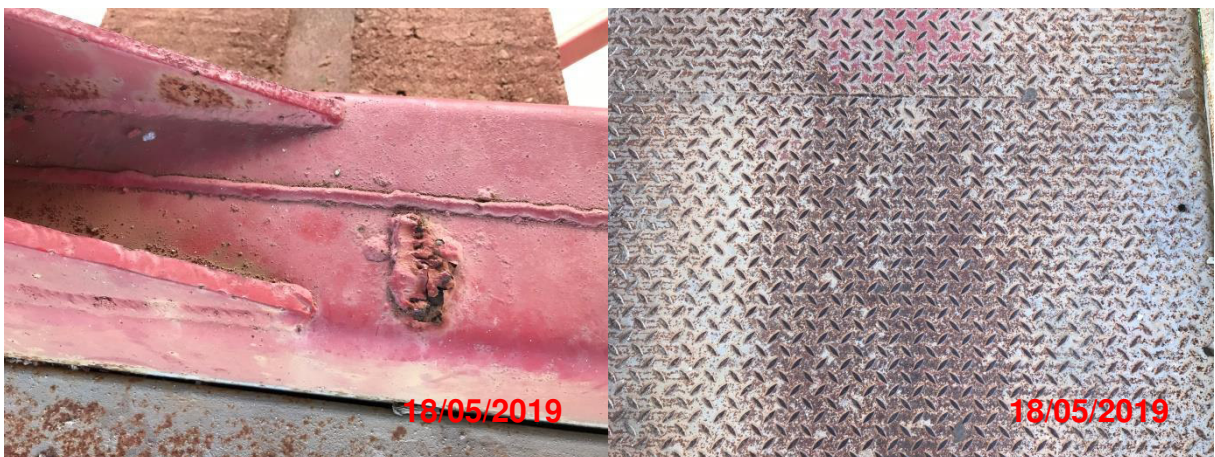
Figura 86 - Processo de oxidação em pontos da estrutura metálica.
