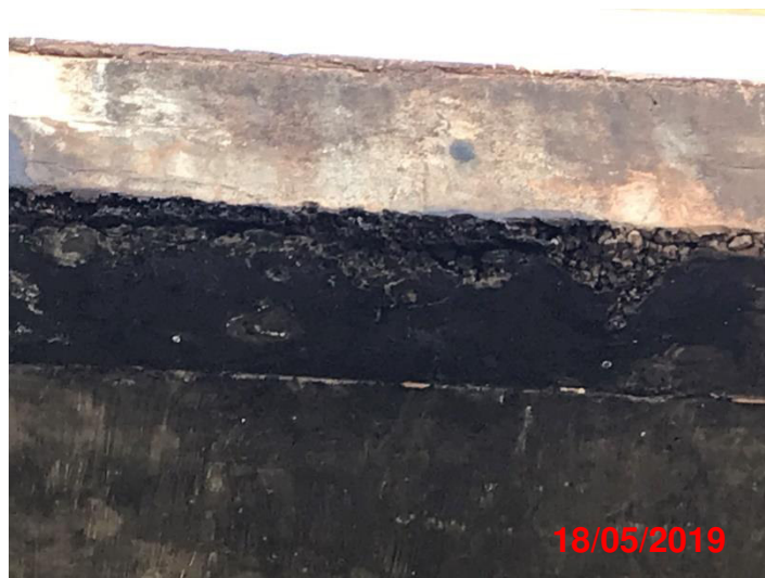
Figura 63 - Percolação de água e segregação do concreto.
