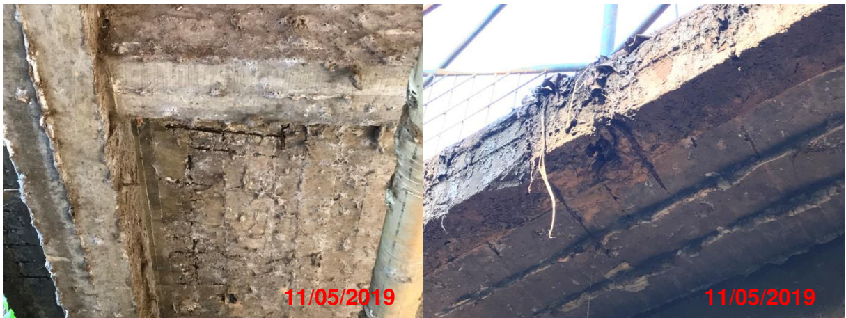
Figura 53 - Desagregação do concreto e exposição de armaduras na Ponte 04.
