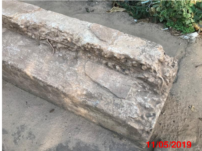
Figura 50 - Desagregação do concreto em guarda rodas da Ponte 04.
