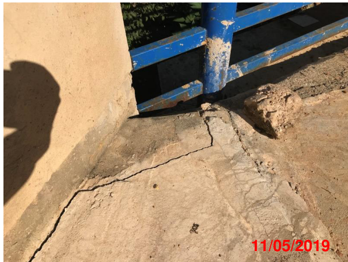
Figura 45 - Fenda no piso da parte superior ao encontro da ponte.
