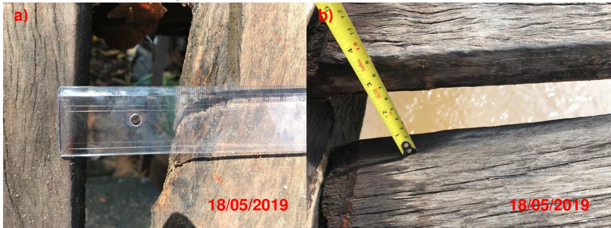
Figura 73 – a), b), c) e d): Defeitos no tabuleiro.
