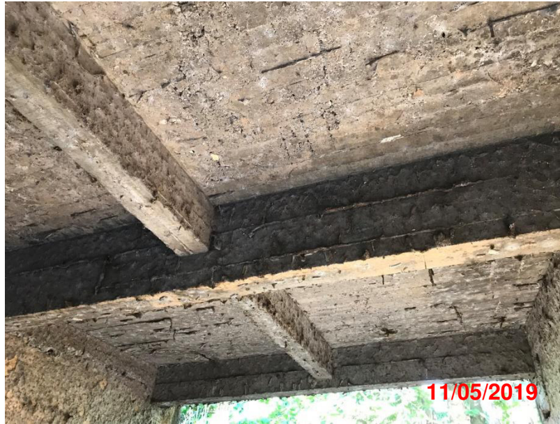
Figura 54 - Eflorescências e manchas causadas por agentes bióticos na Ponte 04.
