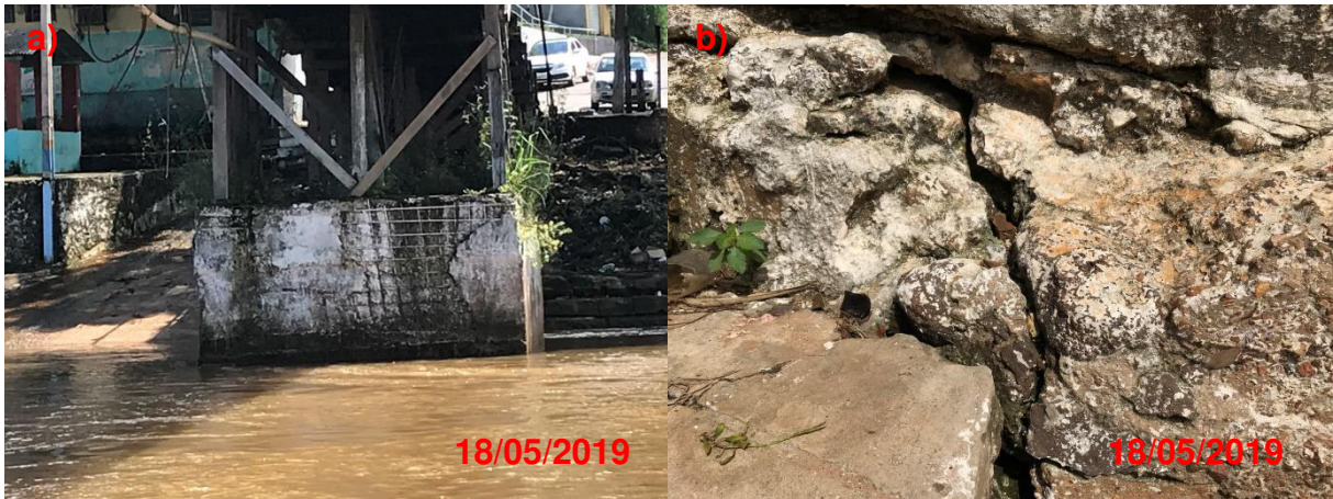
Figura 78 – a) Desagregação do concreto e exposição de armaduras nas fundações. b) Abertura de fenda em bloco de fundação.
