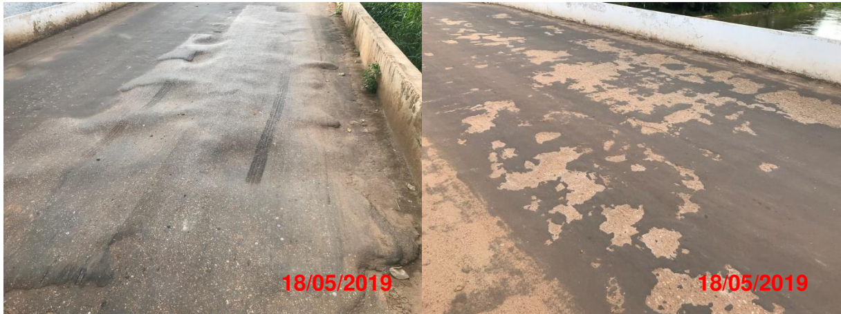
Figura 83 - Defeitos no pavimento.
