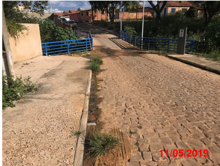
Figura 44 - Escoamento e acúmulo de água oriunda do lençol freático.
