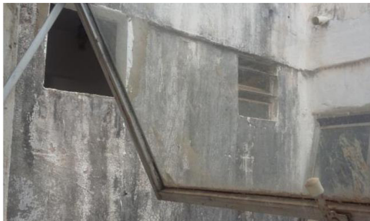
Figura 20 - Manchas formadas por bolor.
