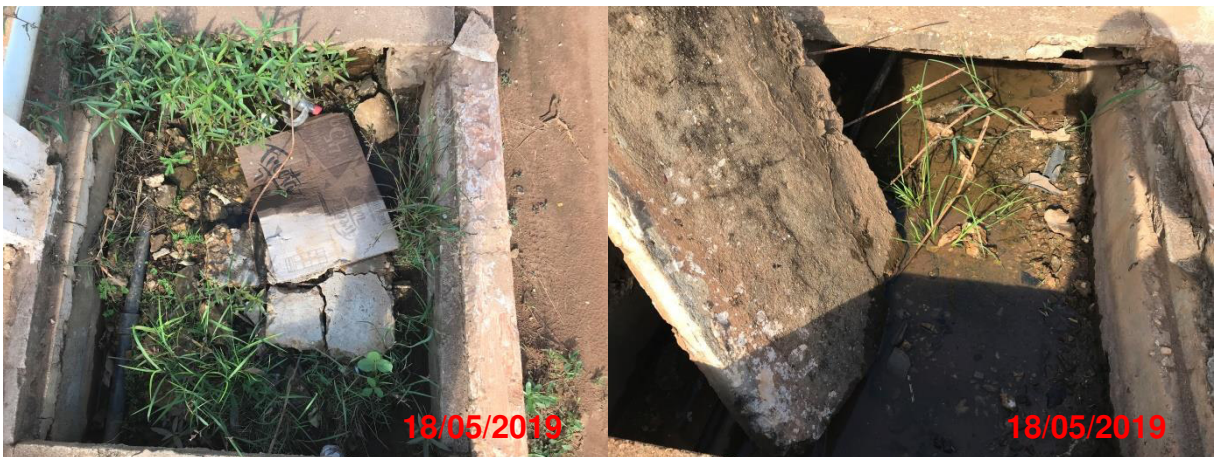
Figura 62 - Acúmulo de água e crescimento de vegetação nos passeios danificados.
