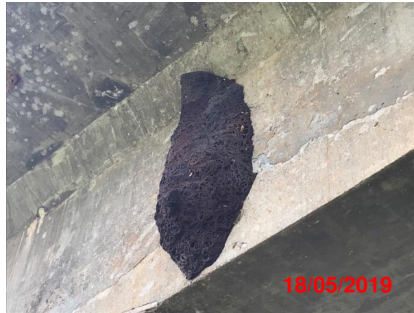
Figura 67 - Ninho de insetos na Ponte 05.
