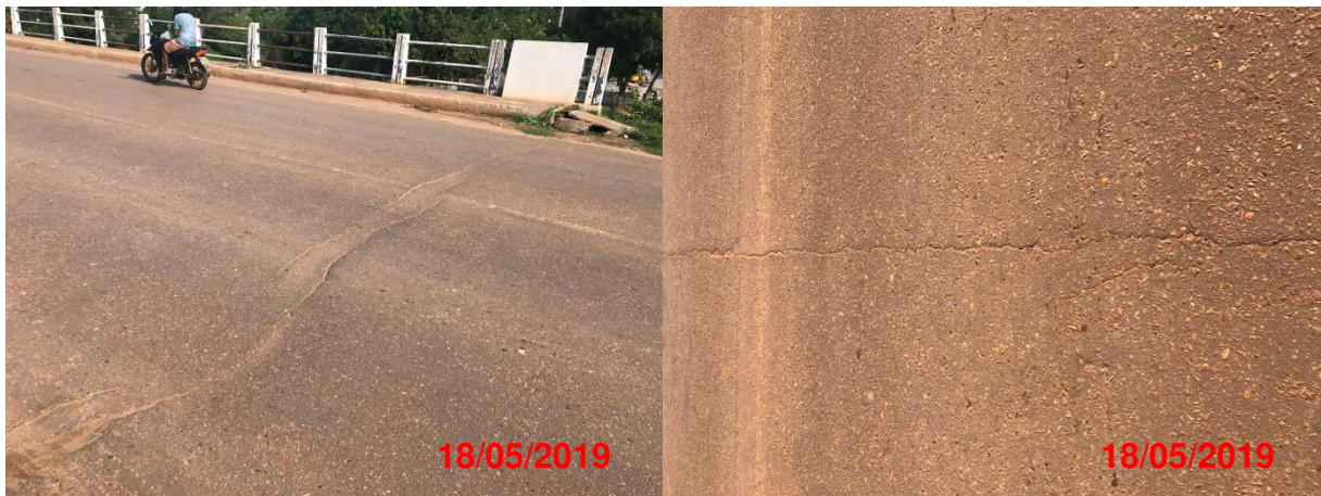
Figura 65 - Fendas no pavimento da Ponte 05.
