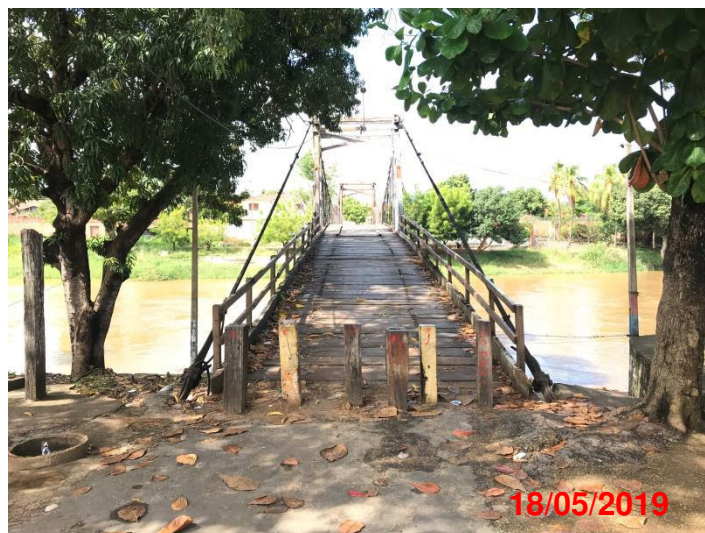
Figura 71 - Peças de madeira interditando a entrada da ponte.
