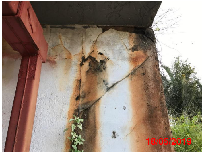
Figura 85 - Fissuramento no muro de arrimo da Ponte 07.
