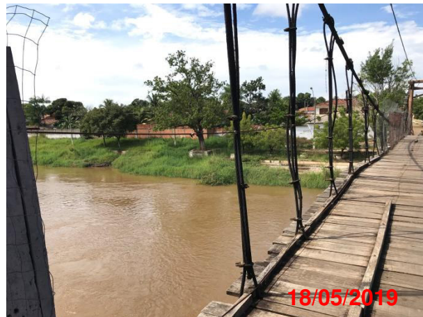
Figura 72 - Falta de grades de proteção.
