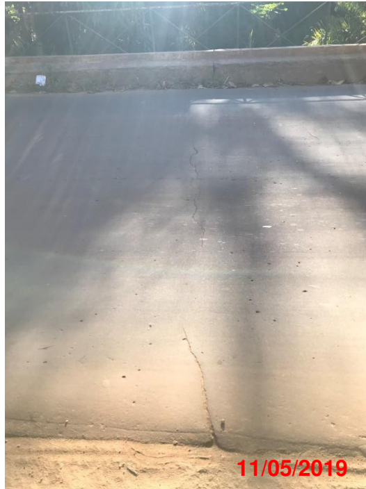
Figura 52 - Trincas transversais longas no pavimento asfáltico.
