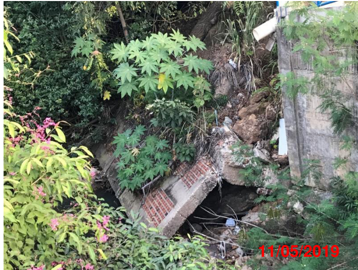
Figura 37 - Antigo muro de arrimo em alvenaria que entrou em colapso.
