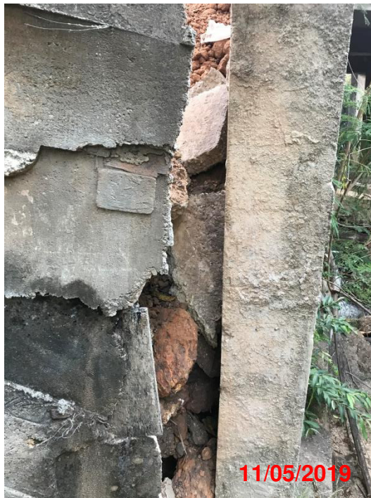
Figura 38 - Rompimento no muro de arrimo.
