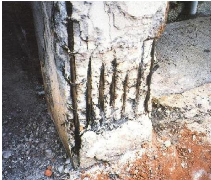
Figura 16 - Fenômeno de desagregação do concreto.
