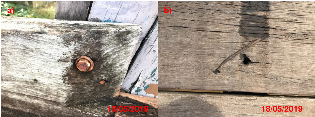
Figura 76 - a) Degradação química em fixador. b) Desprendimento de fixador.
