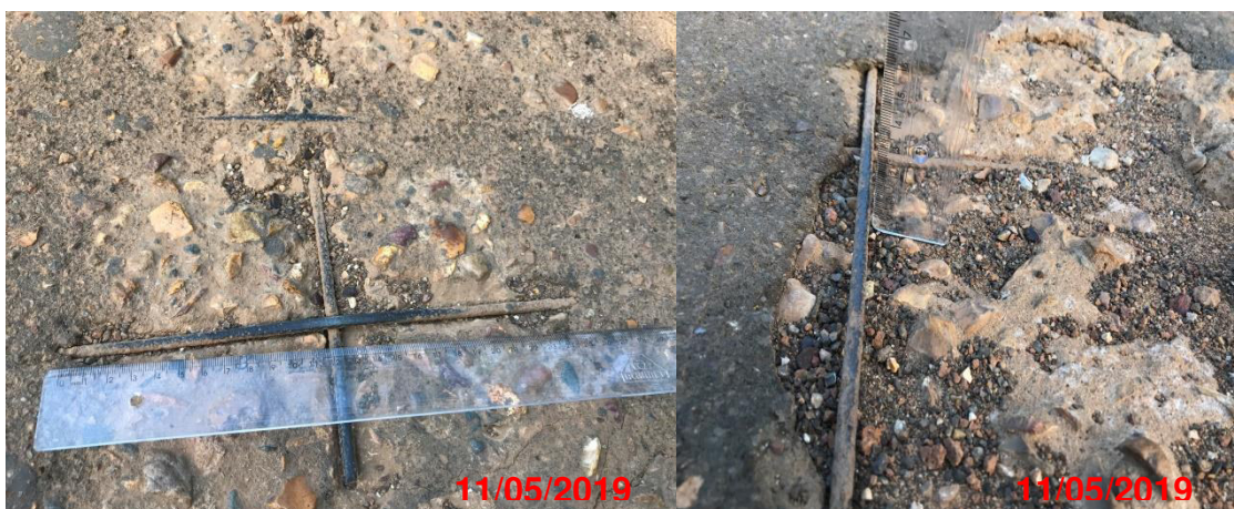
Figura 31 – Buracos com exposição de armadura na pista de rolamento.
