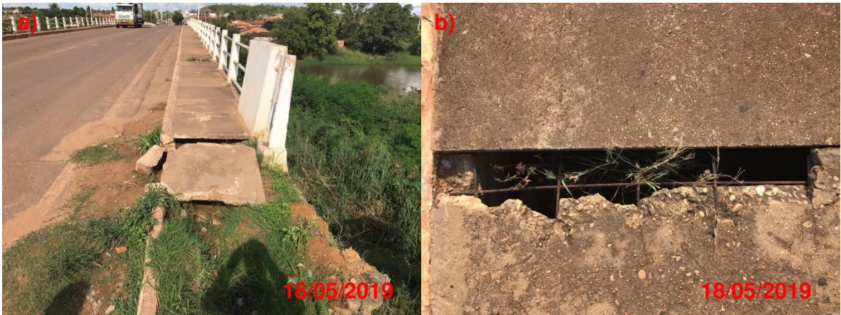
Figura 60 - a) Passeios para pedestres danificados. b) Detalhe de exposição e corrosão de armaduras no passeio.
