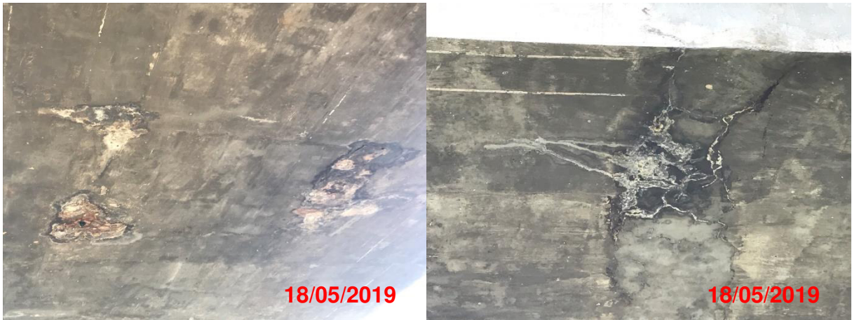
Figura 66 - Eflorescências no estrado celular da Ponte 05.
