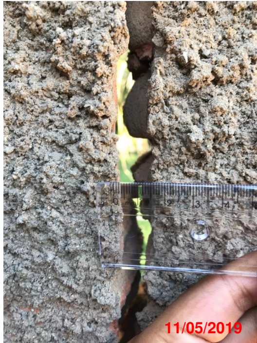
Figura 46 - Abertura de fenda no muro da residência da margem esquerda da ponte.
