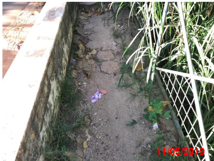
Figura 51 - Passeios da Ponte 04 com ocorrência de recalque crescimento de vegetação.
