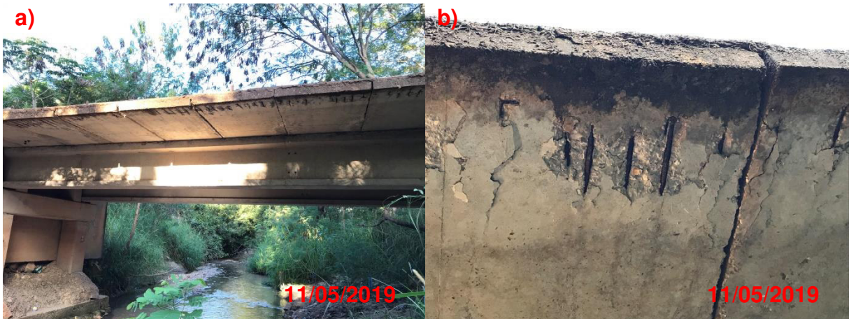
Figura 32 – a) Vista lateral da laje com armaduras expostas. b) Detalhe da corrosão da armadura e desagregação do concreto.
