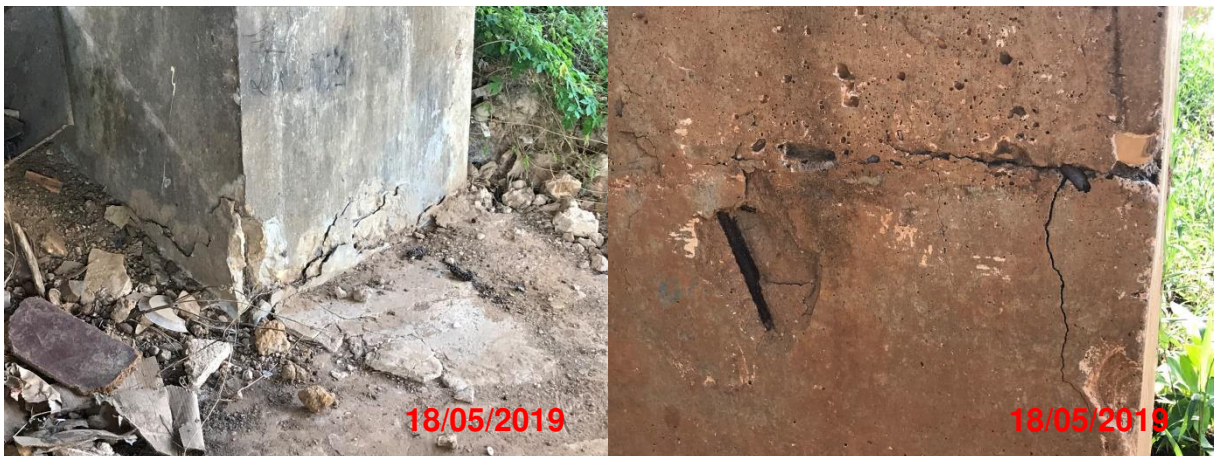
Figura 68 - Desagregação do concreto e exposição de armaduras em pilares da Ponte 05.
