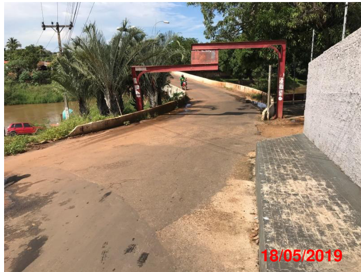
Figura 81 - Curva de raio curto no encontro da ponte com a Rua do Caraibas.
