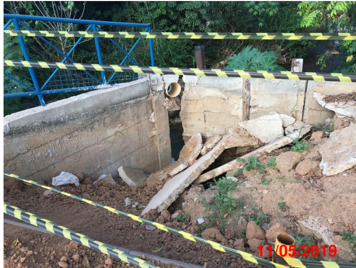
Figura 39 - Ponto interditado pelo recalque e rompimento do muro de arrimo.
