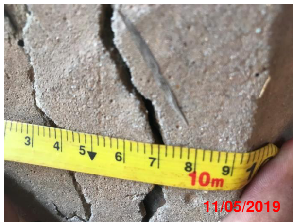
Figura 34 - Detalhe da abertura de fenda na aresta de um dos pilares.
