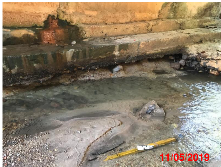
Figura 55 - Erosão sob o muro de arrimo.
