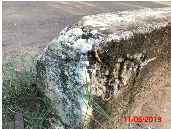
Figura 30 - Guarda rodas com extremidade danificada.
