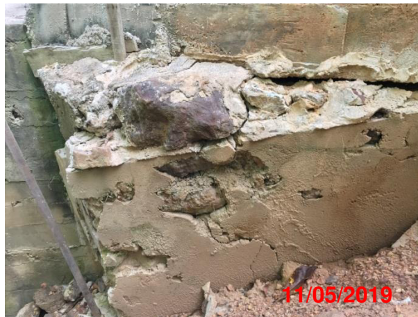
Figura 47 - Recalque e fissuramento no muro de concreto ciclópico.
