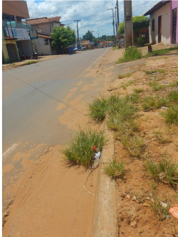
Figura 74-Calçadas com pisos irregulares e dotadas de vegetação rasteira
