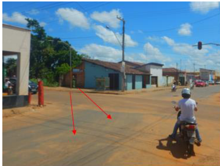
Figura 47- Deformações e ondulações no pavimento
