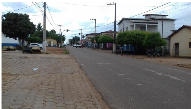
Figura 103-Estado do pavimento no Trecho 03
