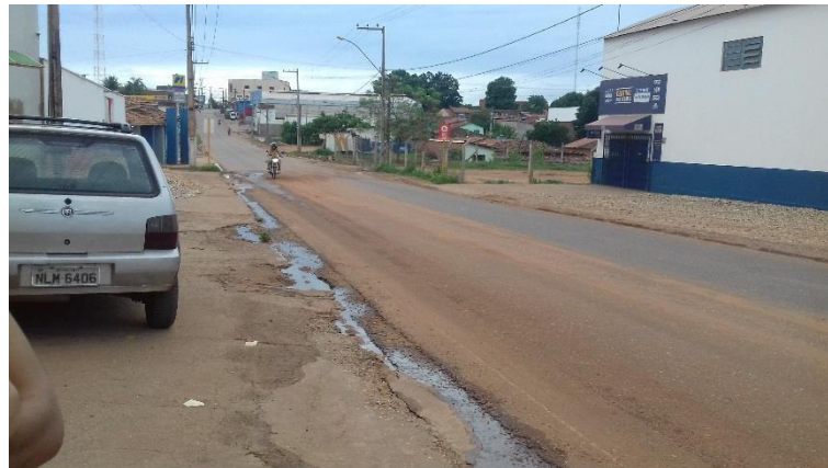
Figura 33-Ausência de guia (meio-fio) facilita o estacionamento de veículos na calçada
