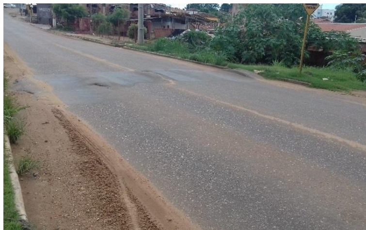
Figura 77-Deformação da pavimentação
