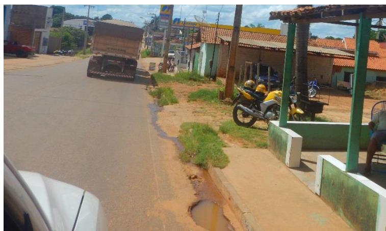
Figura 36- Calçada com largura inadequada
