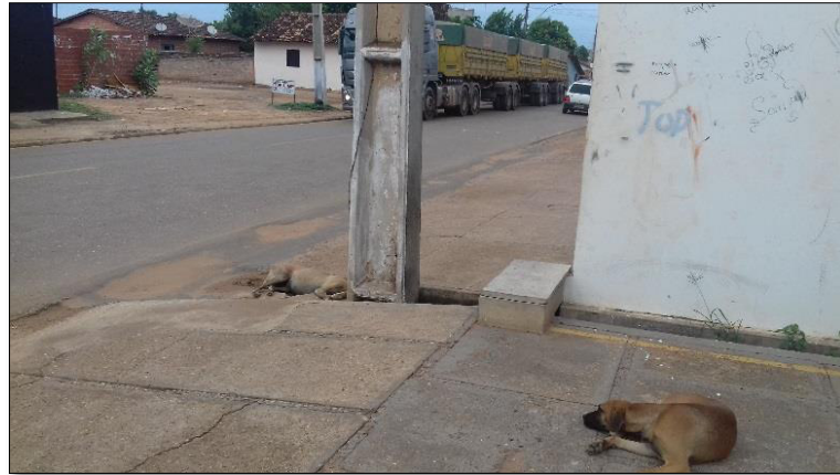
Figura 44- Barreiras na calçada (poste, inclinação acentuada, caixa de inspeção e desnível)
