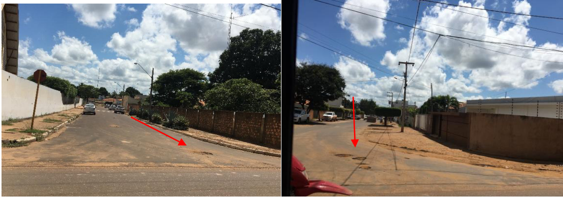
Figura 46-Buracos nos limites das interseções da Av. Contorno com outras ruas no Trecho 01
