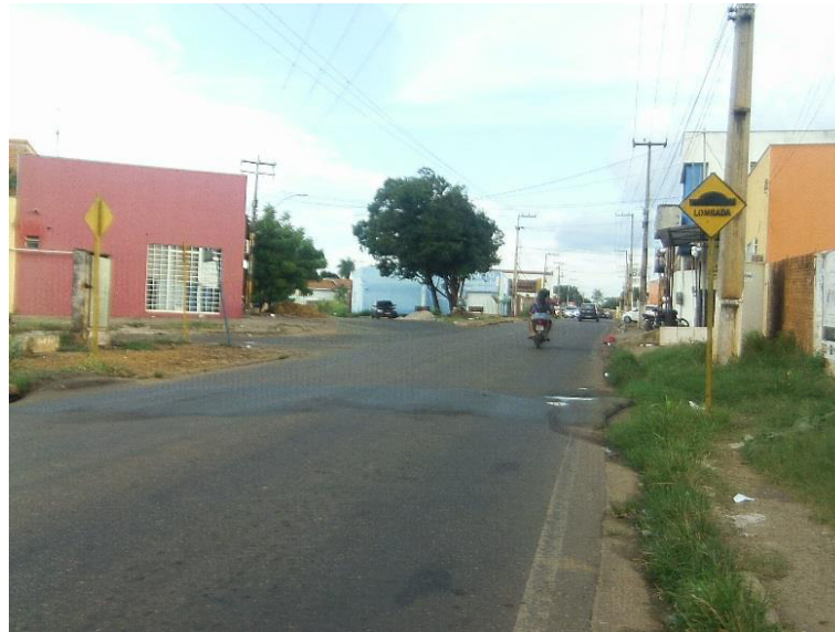
Figura 78- Lombada com pavimentação deformada
