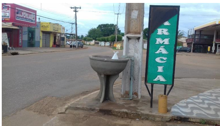
Figura 101- Obstáculos na calçada
