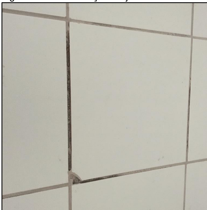
Figura 11 - Deterioração de junta
