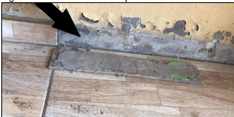
Figura 6 - Destacamento da placa cerâmica
