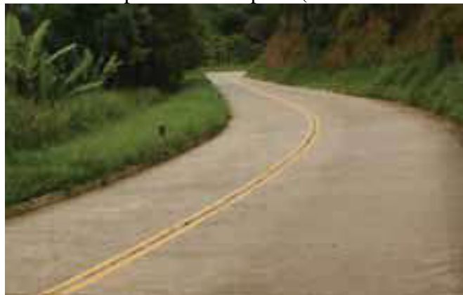
Figura 3 - Rodovia Itaipava – Teresópolis (mais de 90 anos em serviço)
