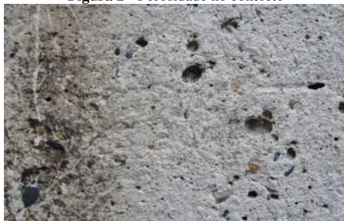
Figura 2 - Porosidade no concreto
