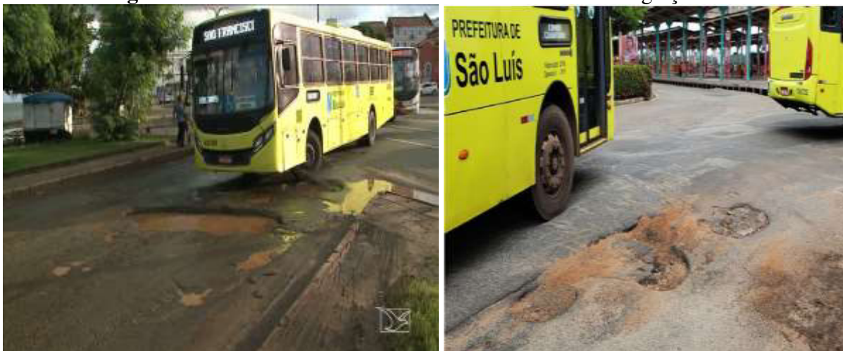
Figura 17 - Via deteriorada na entrada do Terminal de Integração da Beira Mar
