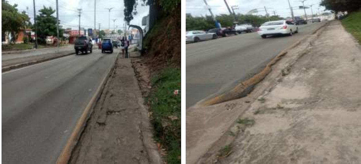
Figura 18 - Pista apresentando deformações na Avenida Jeronimo de Albuquerque
