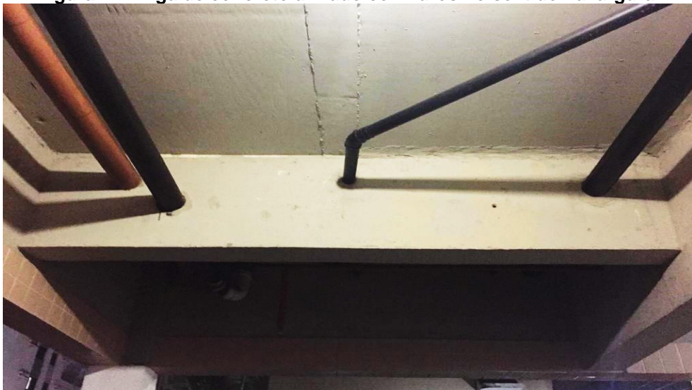
Figura 11 - Viga de concreto armado com furos no sentido na largura.
