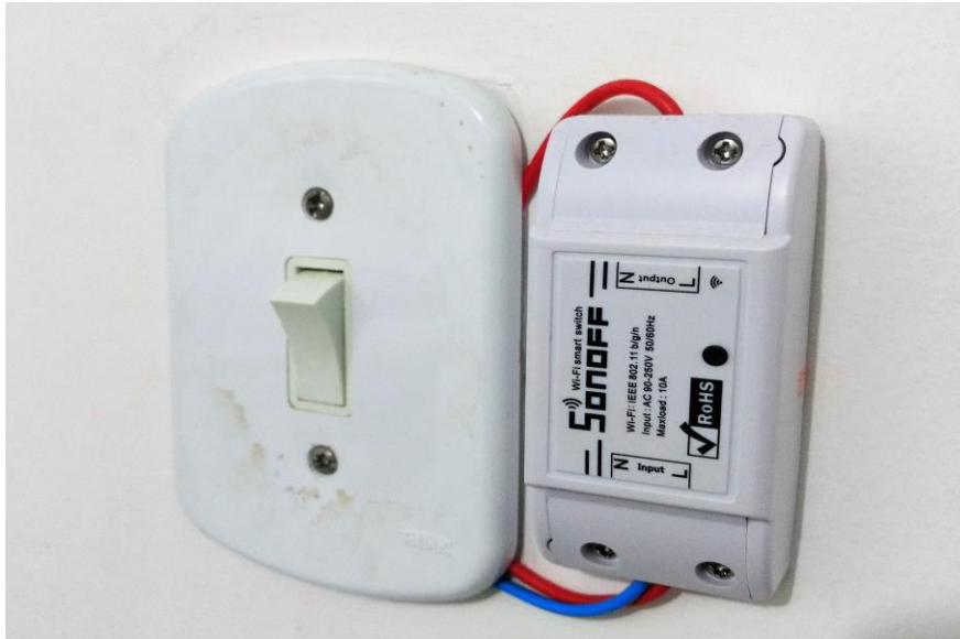
Figura 22 – Sonoff Basic instalado na residência
