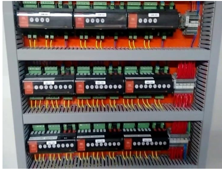
Figura 14 – Quadro de automação residencial
