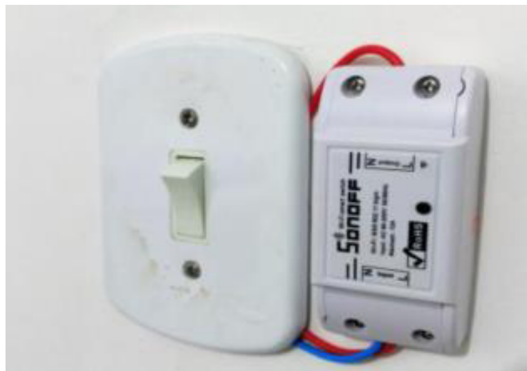
Figura 24 – Sonoff instalado na residência
