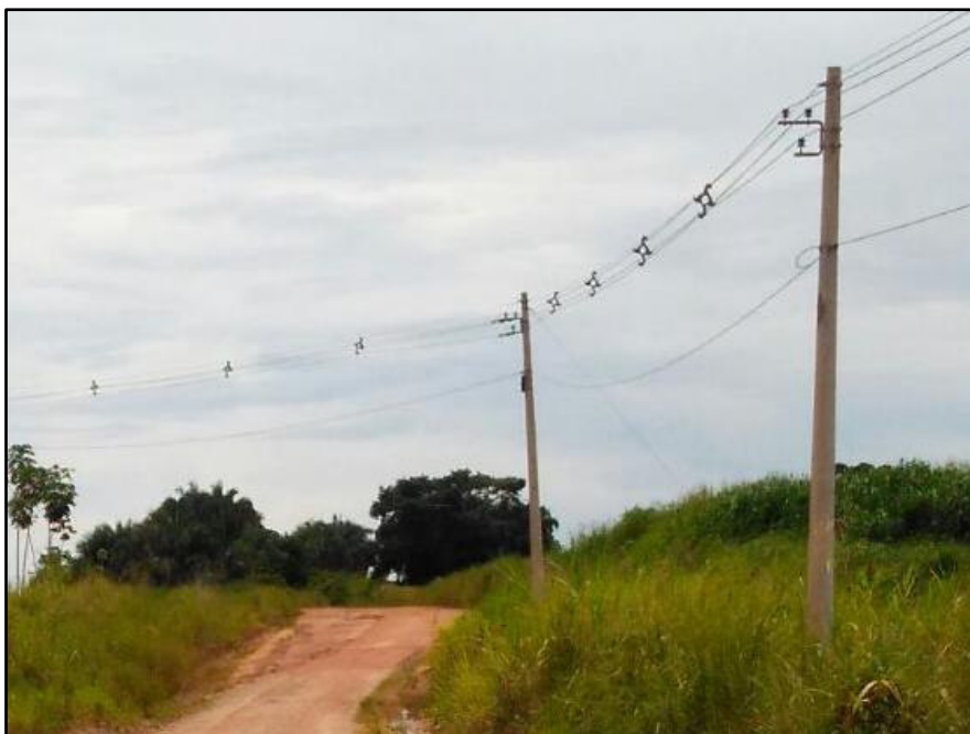
Figura 24: Rede de Distribuição Compacta - RDC
