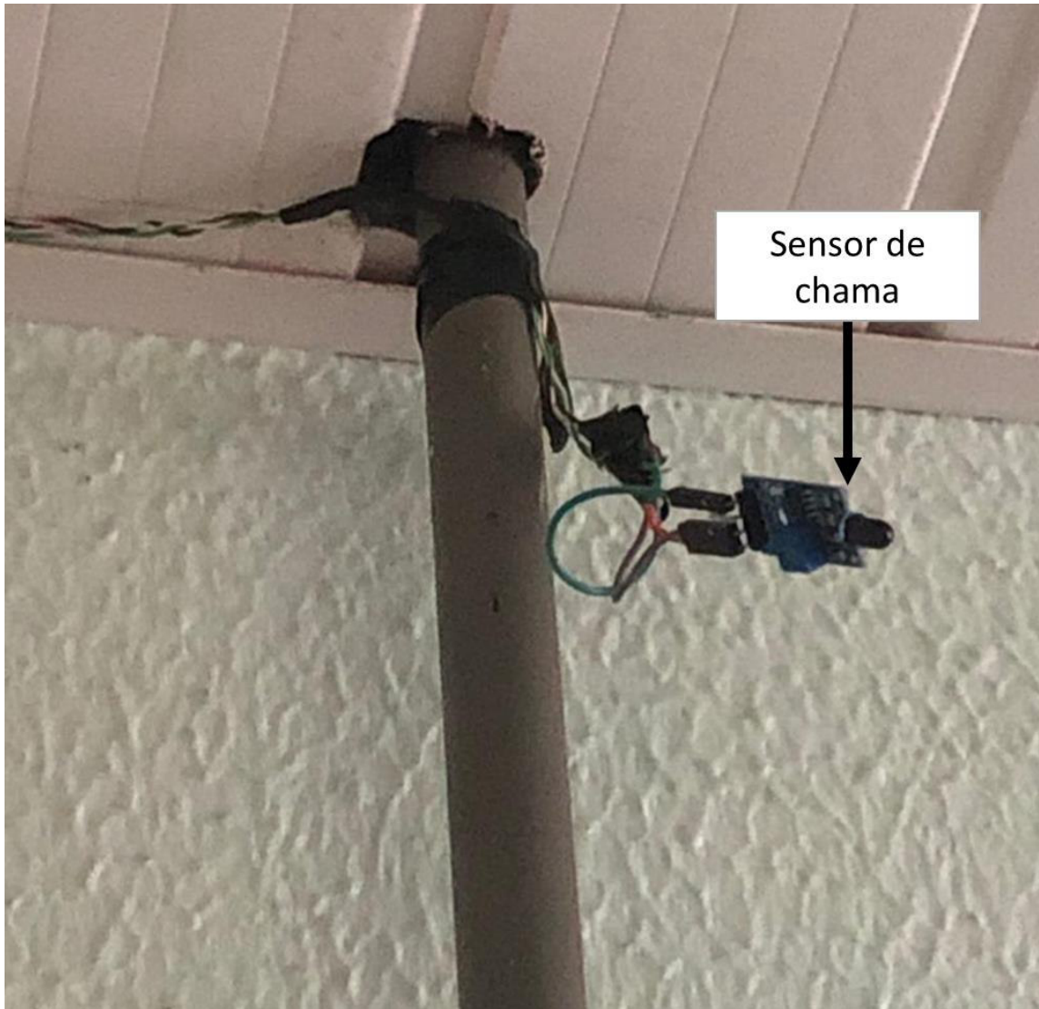
Figura 23: Sensor de chama sobre o quadro elétrico do LABGEA
