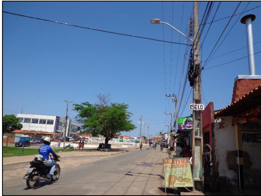
Figura A.3 – Luminária Pública BRP371 A LED87-3S/NW 86W no trecho AB. Fonte Própria.
