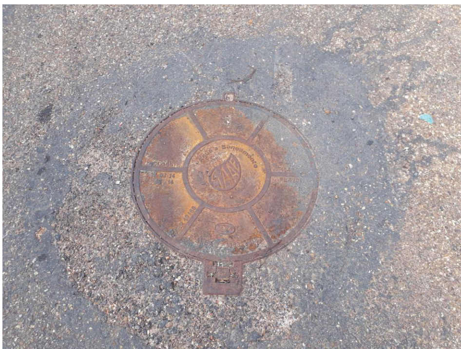
Figura 9 – Tampão de poço de visita.
