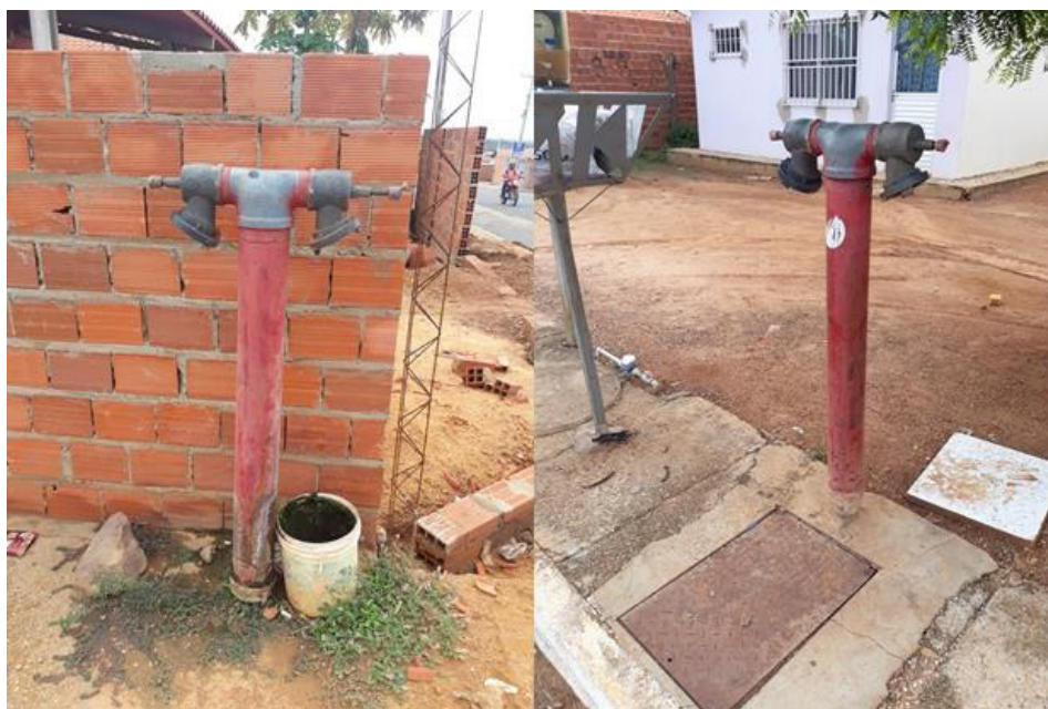
Figura 8 – Hidrantes com vazamento de água.
