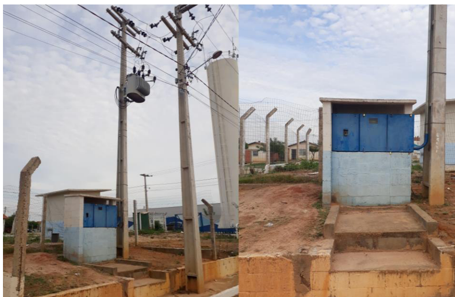
Figura 6 – Estação aérea, transformador e quadro.
