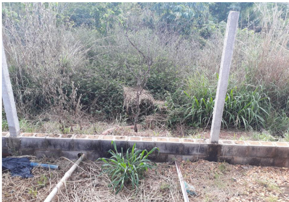
Figura 16 – Canos que levam o esgoto tratado até o córrego natural.
