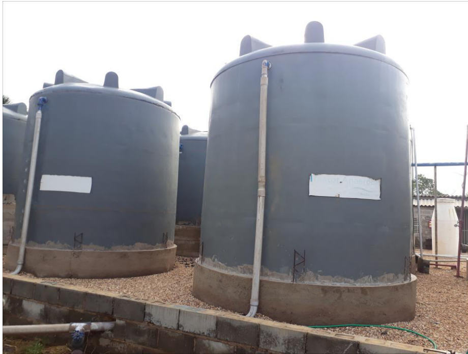
Figura 11 – Tanque do reator anaeróbico.
