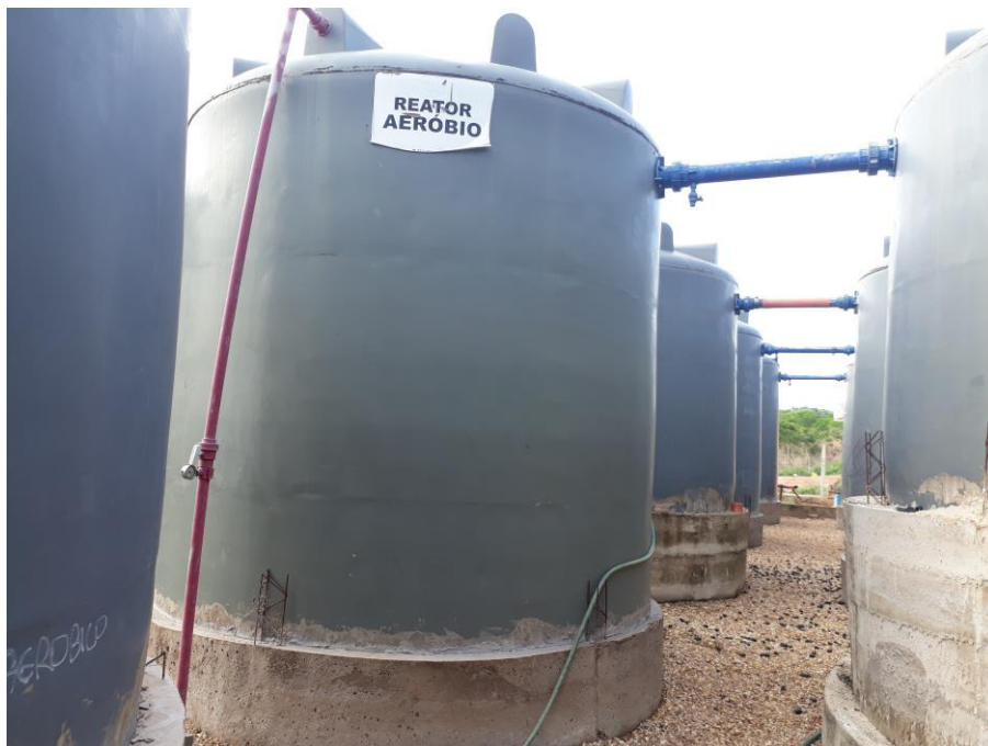
Figura 12 – Tanque do reator aeróbico.
