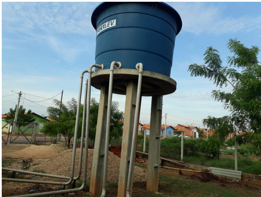
Figura 10 – Caixa receptora de esgoto.
