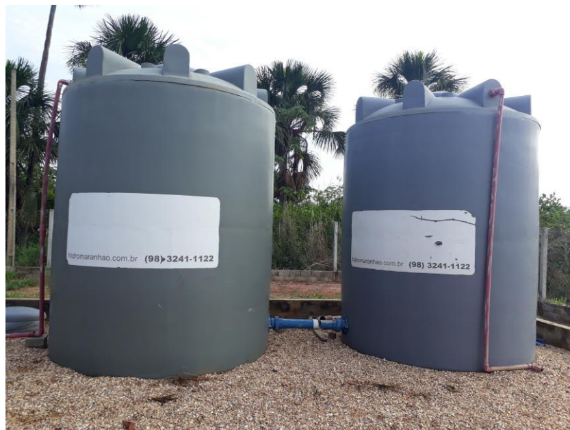
Figura 14 – Tanque de lodo.
