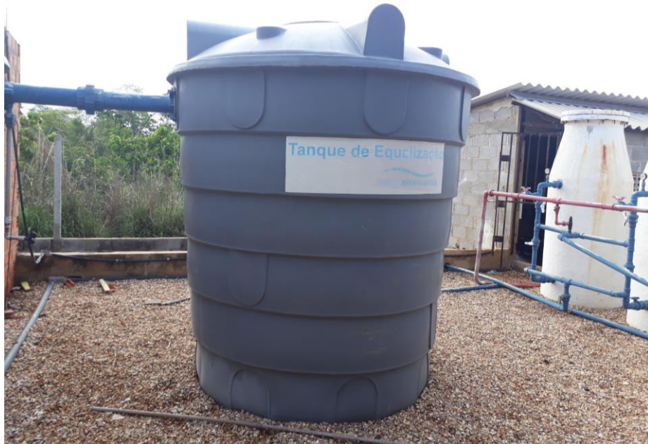
Figura 15 – Tanque de equalização.
