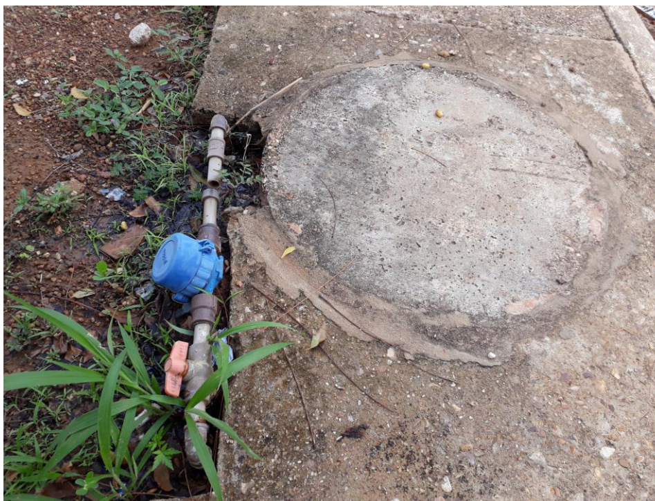
Figura 7 – Vazamento no cavalete de abastecimento de água.
