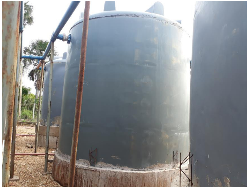
Figura 13 – Tanque de decantação.
