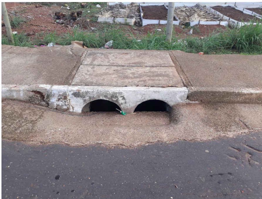
Figura 19 – Boca de lobo.
