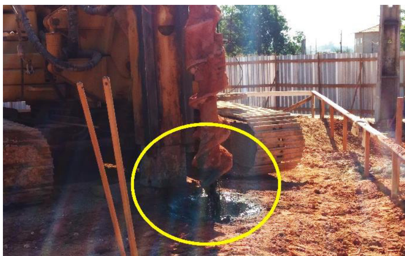
Figura 20 - Calda de lubrificação saindo junto com concreto na ponta do trado.
