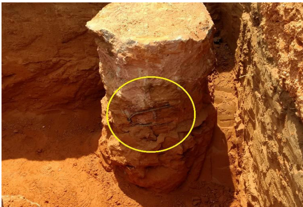
Figura 28 - Armação de estaca exposta.
