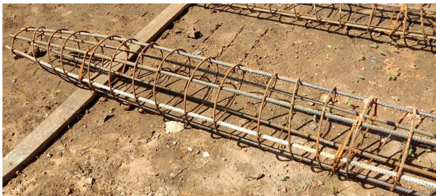
Figura 27 - Armação utilizada nas estacas do empreendimento Vila da Serra.
