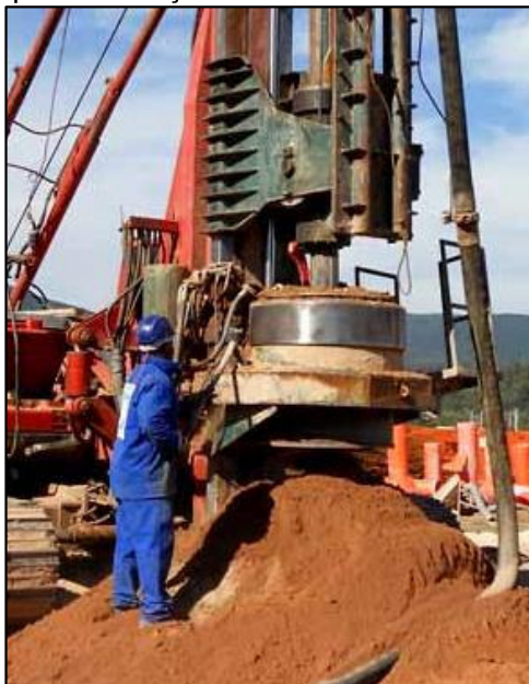
Figura 24: Entulho gerado pela escavação da estaca ocasionando o desperdício de concreto.
